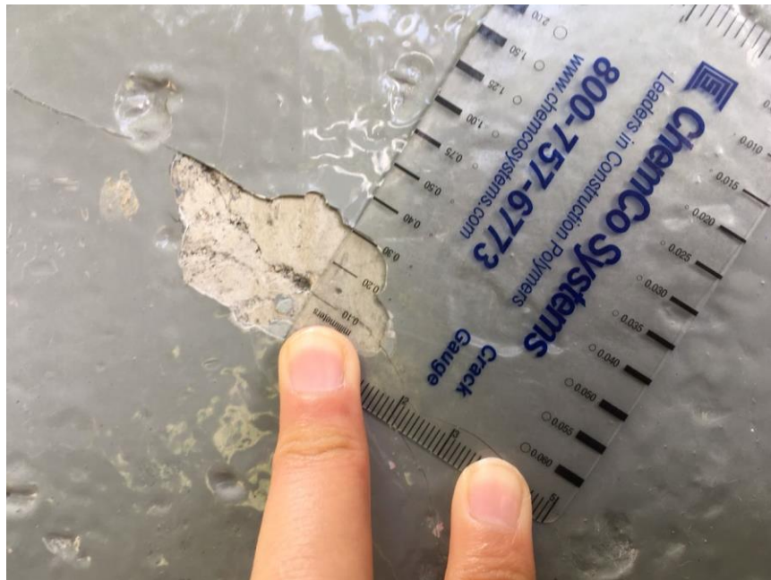
Figura 2.8 Daño por cortante observado en la columna del Eje 1 en sentido longitudinal, agrietamiento de 0.10 mm de espesor.
