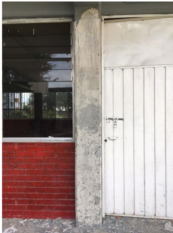
Figura 2.11 Daño por cortante observado en la columna del Eje 8 en sentido longitudinal, agrietamiento de 0.75 mm de espesor.
