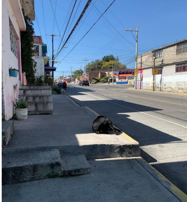
Imagen 11. Fotografía de la franja de circulación peatonal obstruida por un escalón.
