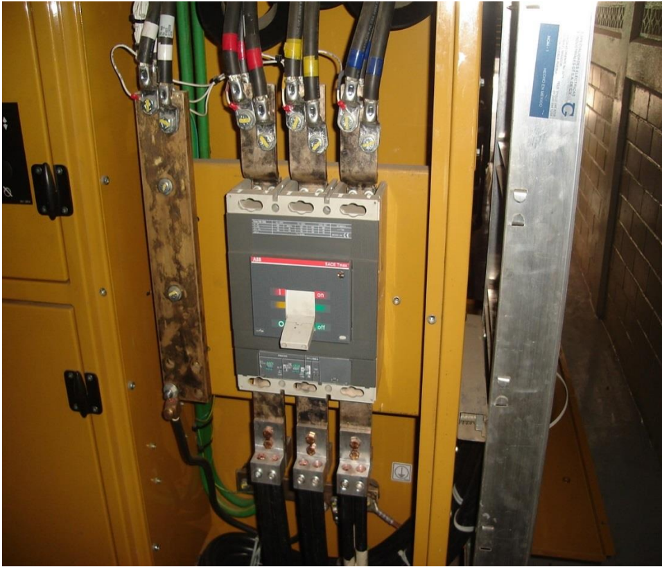
Figura 2.5.2 Corrosión. Origen Propio.
