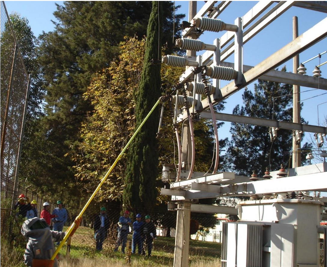
Figura 6.19 Desconexión con Pértiga y Traje de Arc Flash. Origen: Propio.
