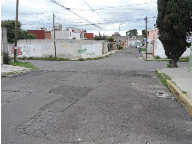
Figura 47 Grafitis y banquetas dañadas
