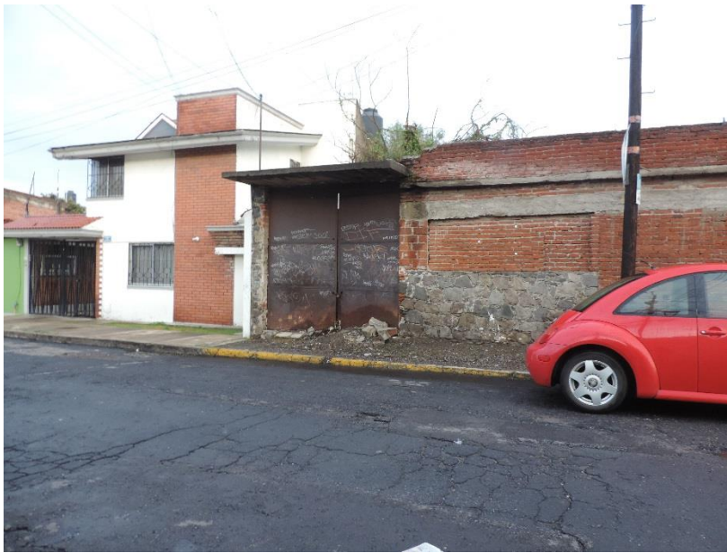
Figura 17 Edificio con grafiti y señales de abandono
