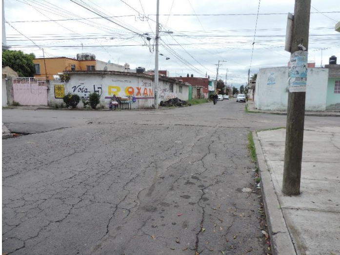
Figura 55 Construcción con escombro enfrente y grietas en el pavimento
