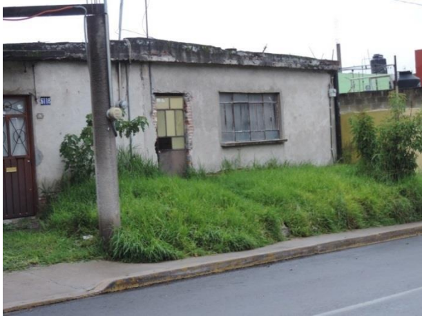
Figura 29 Estructura con ventana rota
