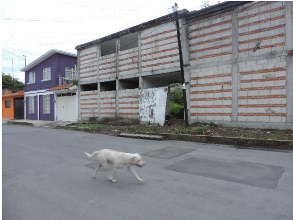
Figura 65 Abertura en edificio abandonado mostrado en la figura 49
