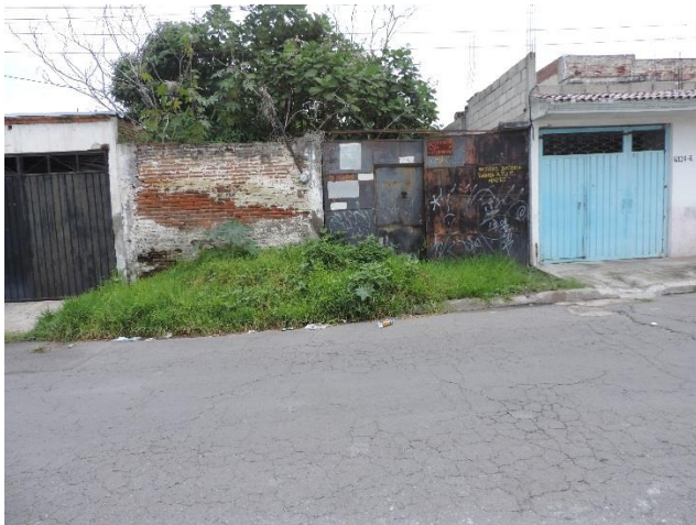
Figura 59 Construcción con grafiti y señales de abandono
