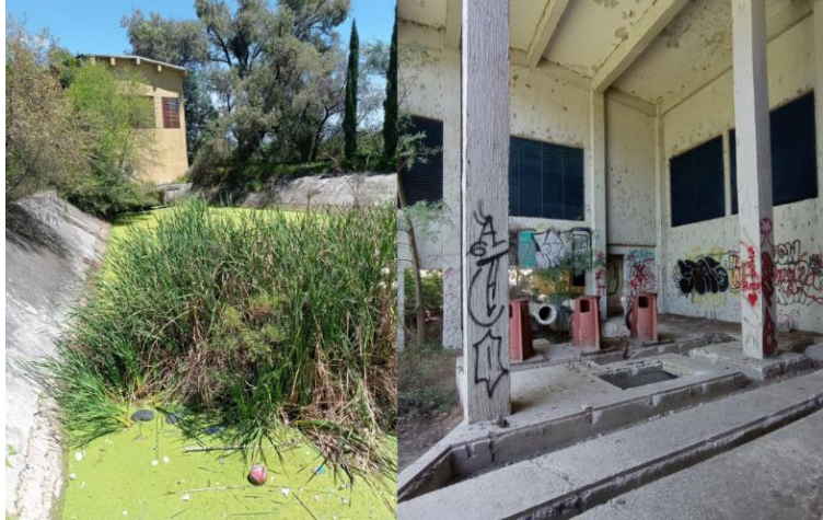
Figura 22. Vaso regulador y cuarto máquinas vandalizados (Cabrera, 2023)
