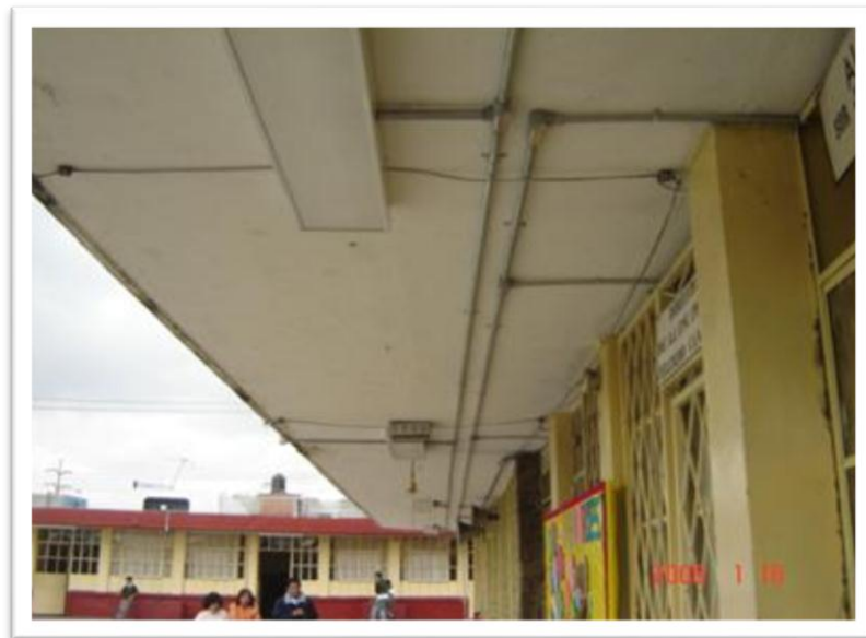
Foto 12.- Instalación Eléctrica realizada
