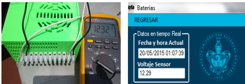
(a) Medición de voltaje de baterías.
