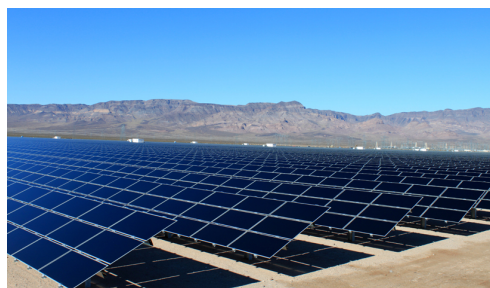
Figura 2.14: Parque Fotovoltaico NL [44]
