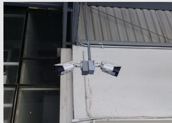
Nota. Tesistas. (2021). Cámaras de seguridad en la terminal. [Fotografía].
