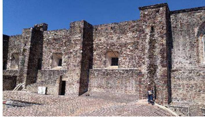
Ilustración 5 Fachada sur del edificio que muestra su mala condición, fotografía tomada por tesistas, (2020).
