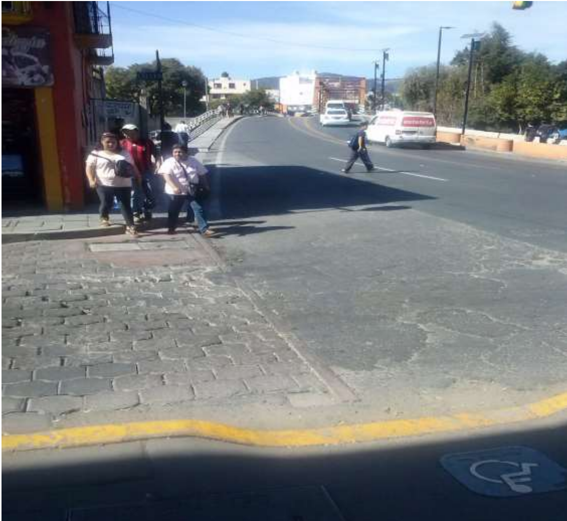
Figura III.23.- Cruce peatonal de la Avenida Allende en mal estado.
