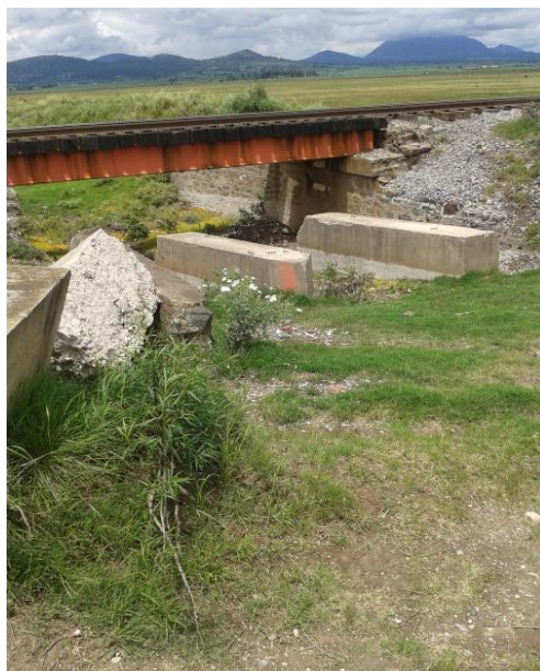
Fotografía 1 Tramo de la vía del tren que fue derrumbado en el pasó de Carranza por la zona
