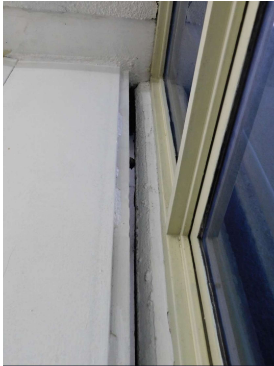
Imagen A. 9. Separación Muro-Columna.
