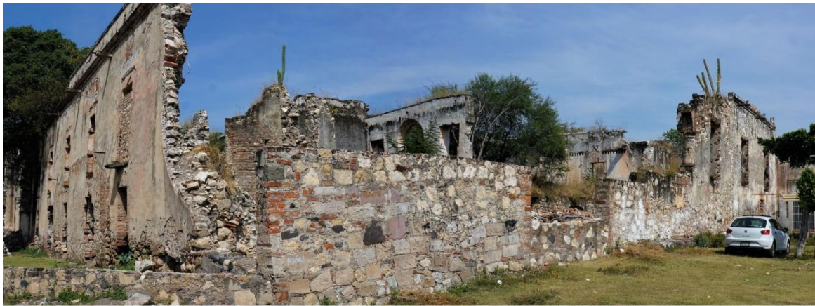
[Fig. 3.11] Vista actual de la esquina sur de la casa grande en el ingenio San Juan Colón. Fotografía: Morán. 2018.
