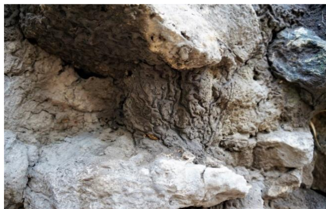
[Fig. 3.14] Mortero de lodo con evidencia de corrosión hidráulica.
