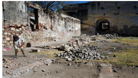
[Fig. 0.3] Demolición de muretes en área de corrales en el patio interior de la casa grande. Fotografía: Morán, F. 10/01/2020.
