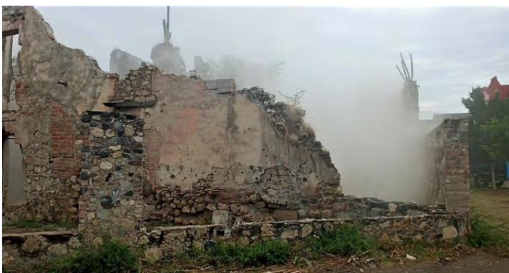
[Fig. 3.13] Esquina sur de la casa grande durante el sismo del 23/06/2020.
