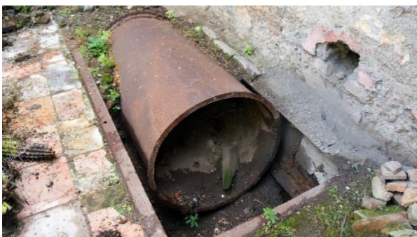
[Fig. 1.6] Tubería metálica subterránea en área de servicios anexos a la fábrica de Colón. Fotografía: Morán, 16/10/2018.
