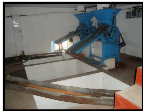
TANQUES DE FERMENTACION, SU ESTRUCTURA PUEDE SER 100% DE CONCRETO ARMADO O MIXTO DE TABIQUE Y PIEDRA, ETC
