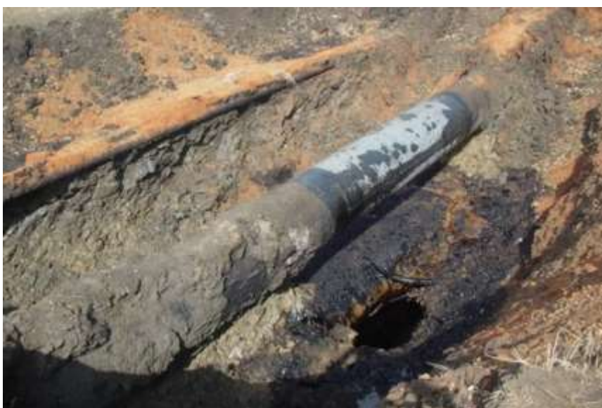
Figura 4.8.- La corrosión por ambientes con sulfuros o por inserción de hidrógeno, debilitan en gran proporción la calidad y resistencia de las tuberías como elementos estructurales, causando un caos en la operación de distribución y transporte.
