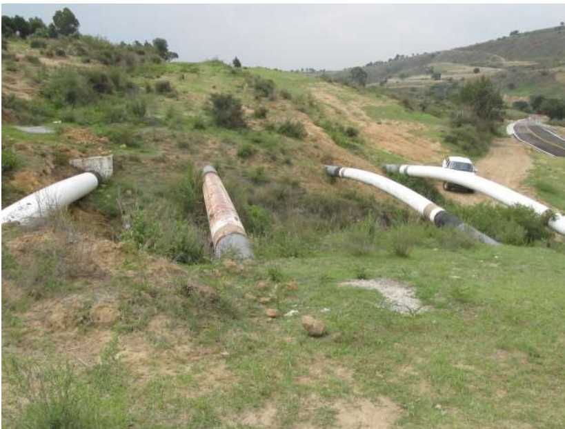
Figura 4.12.- Las condiciones topográficas también son factor de inestabilidad estructural, que se suman a las ya crecientes problemáticas de falla en tubería, en esta configuración de distribución se presenta como adicional el esfuerzos por pandeo en las estructuras.
