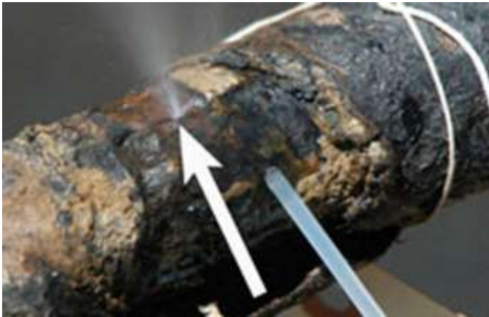
Figura 4.5.- Degradación de estabilidad estructural por corrosión.
