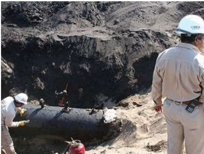
Figura 4.6.- El exagerado abuso de tomas por metro lineal incrementa el riesgo de falla por golpe de ariete, poniendo en riesgo la integridad estructural y funcionalidad del sistema de distribución.
