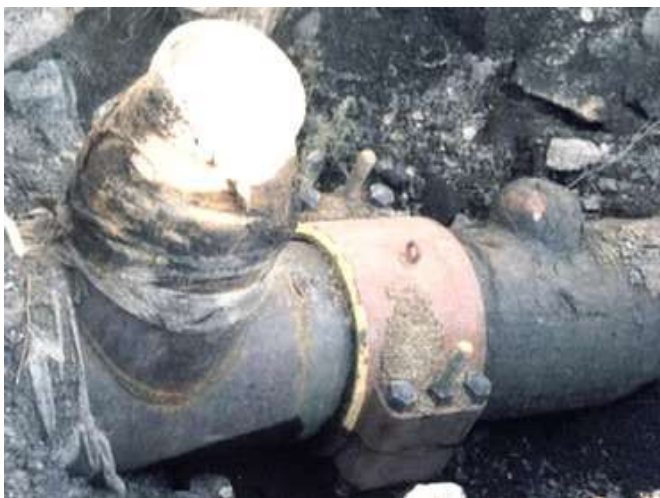
Figura 4.13.- Esta imagen representa el alto grado de inseguridad que existe en los sistemas de distribución y la diferencia entre las condiciones de diseño y las condiciones de operación de la estructura.
