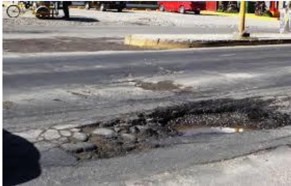
Foto 1.7.1 baches en superficie de rodamiento en Calles de la ciudad de Atlixco
