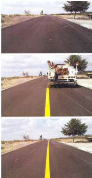
Foto 8. Suministro y aplicación de Señalamiento, Carretera: Tehuacan-Huajuapán de León, km. 38+500, en el Estado de Puebla.
