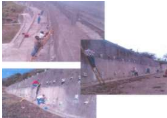
Foto 7. Trabajos de Estabilización de talud, Carretera: Pachuca-Tuxpan, km. 80+000, en el Estado de Puebla.
