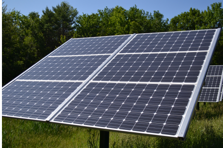
(a) Celdas fotovoltaicas.
