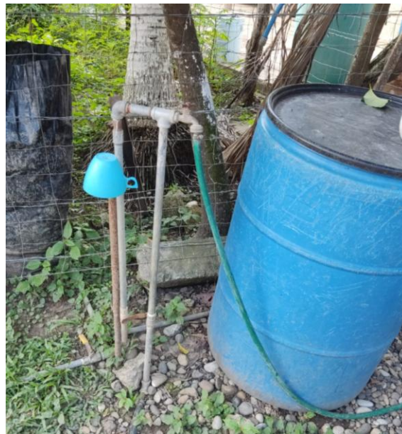
Figura 4.3 Punto de llegada y repartición del agua potable
