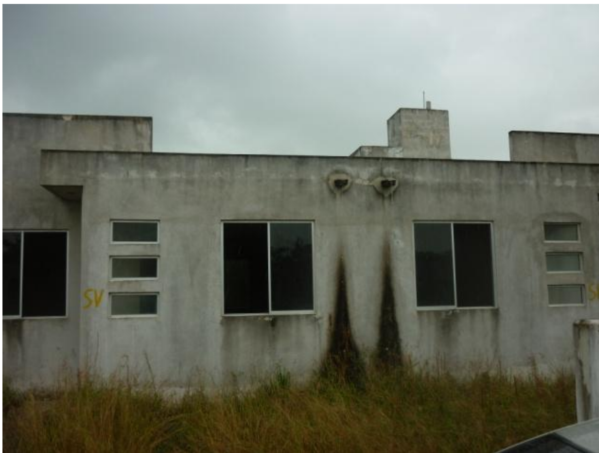
Imagen 49.- Viviendas abandonadas en la periferia del “Polígono 11”.
