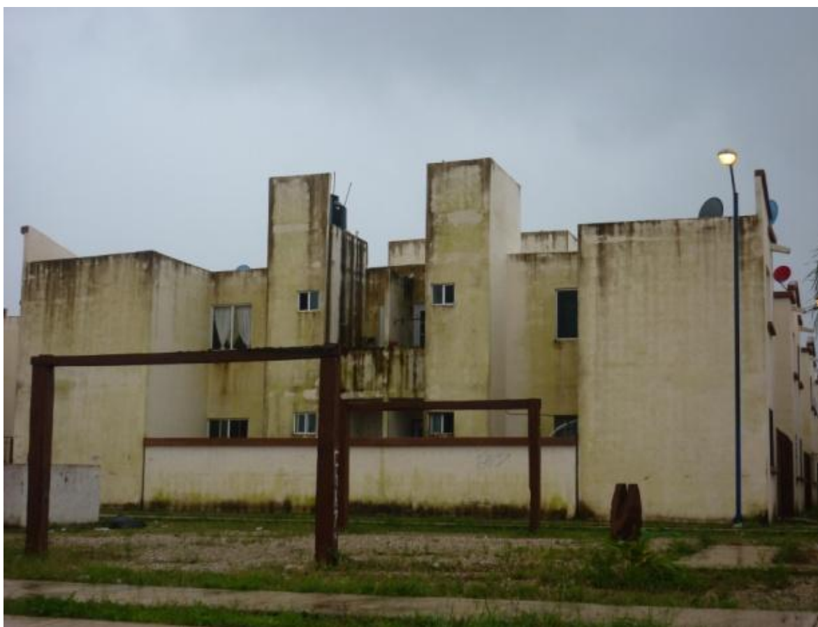
Imagen 56.- Viviendas del Fraccionamiento Villas Otoch Paraíso que presentan humedad y hongos en las fachadas.
