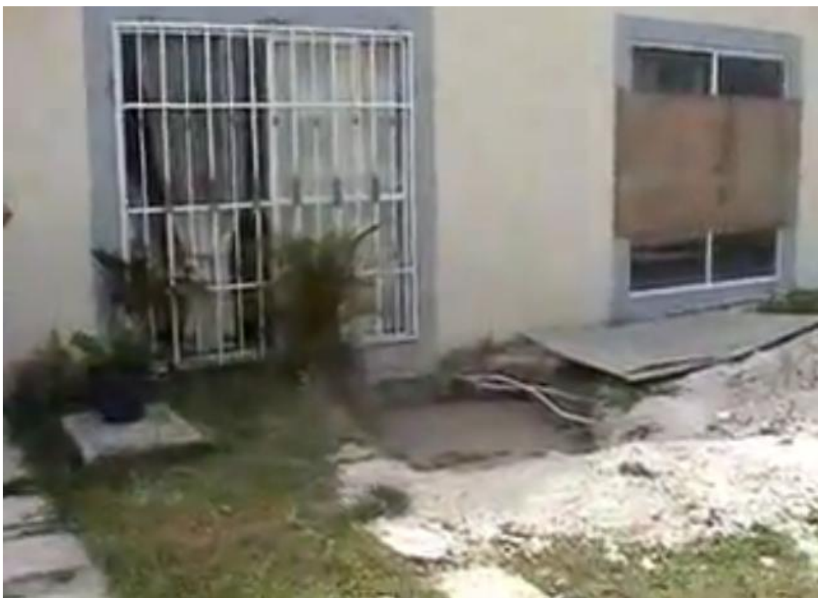
Imagen 27.- Vivienda edificada sobre cenote de la región, evidenciado en el desprendimiento de las capas de compactación de la urbanización, formando una cavidad que no tenía fondo.
