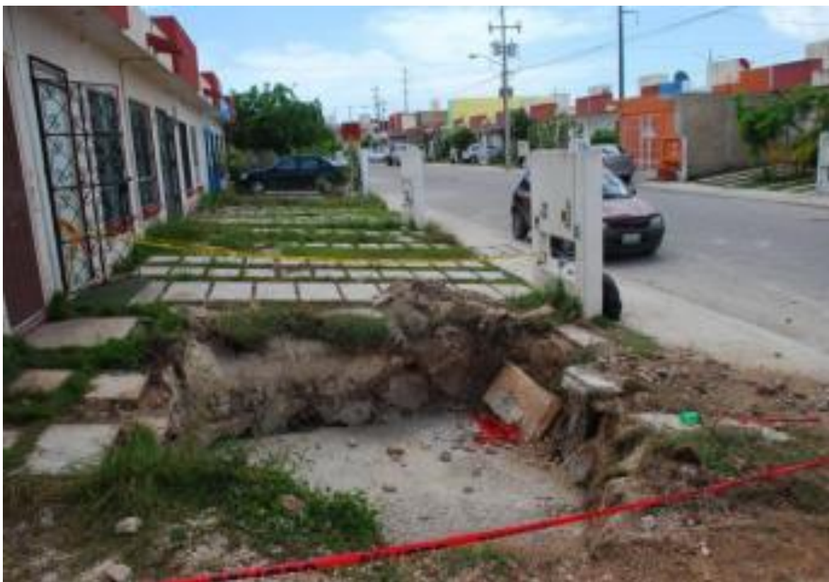
Imagen 28.- Vivienda en el fraccionamiento “Paseos Kabah” que presento la problemática de una cavidad que se abrió del subsuelo.
