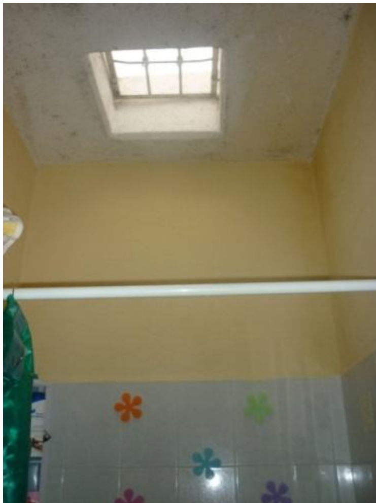
Imagen 54.- Área de baño en vivienda del fraccionamiento “Prado Norte”, el cual no presenta ventana de ventilación y produce hongos al interior del mismo.
