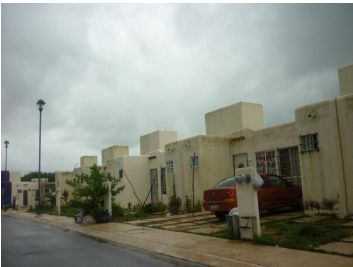
Imagen 57.- Viviendas pertenecientes al Fraccionamiento Villas del Mar III, las cuales denotan húmedas y hongos al exterior.
