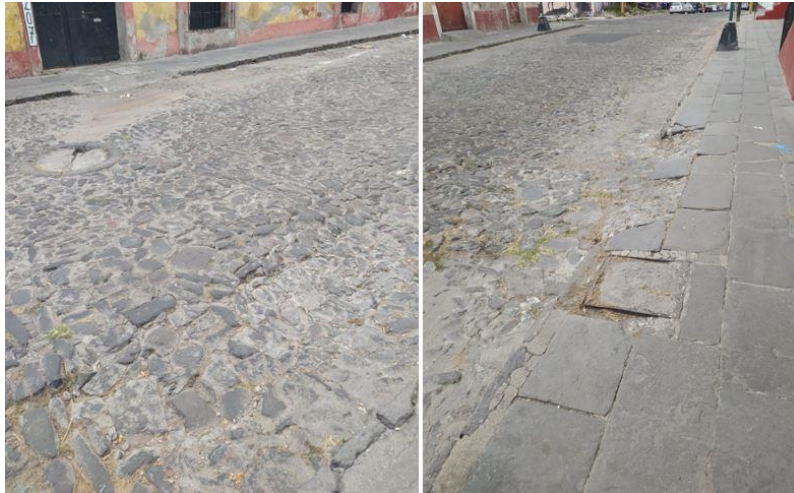
Figura 20. Estado de la vialidad, Calle 7 Ote, Barrio de Analco. Fuente: Foto tomada por Norma Onorato 2020.
