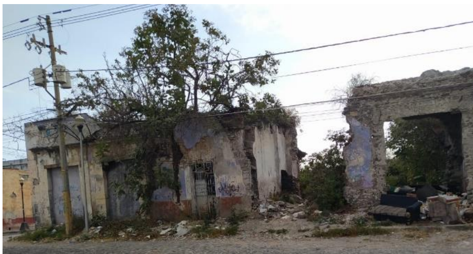
Figura 18. Fachadas deterioradas o en ruinas, Barrio de Analco. Fuente: Foto tomada por Norma Onorato 2020.
