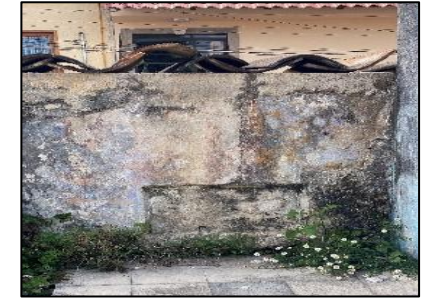
Deterioros en barda perimetral. Fuente: Karla Vélez Ochoa. Marzo 2024
