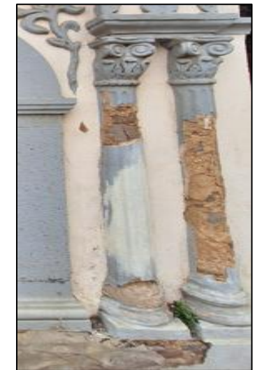
Pérdida de aplanado en elemento de piedra caliza. Fuente: Karla Vélez Ochoa. Marzo 2024
