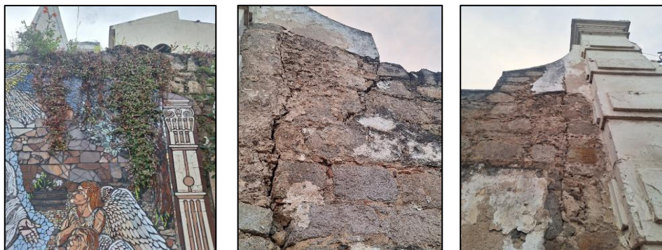
Imágenes de las alteraciones y deterioros que presenta la barda perimetral del panteón por el retiro de aplanado. Fuente: Karla Vélez Ochoa. Marzo 2024
