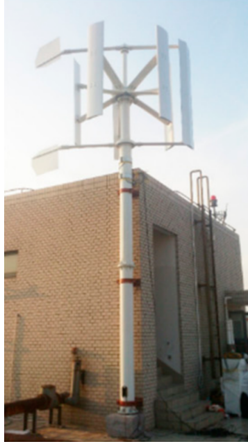
Figura 4.2: Imagen Turbina VAWT instalada sobre un poste [55].
