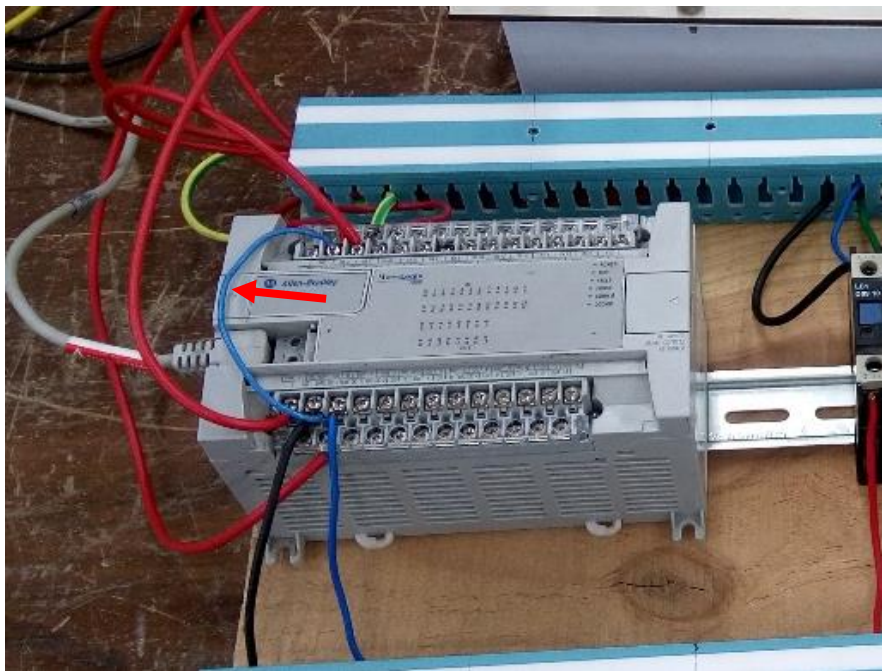
Figura 3.1.3 Cable azul que hace el puente entre el neutro y el común de las entradas señalado con una flecha.
