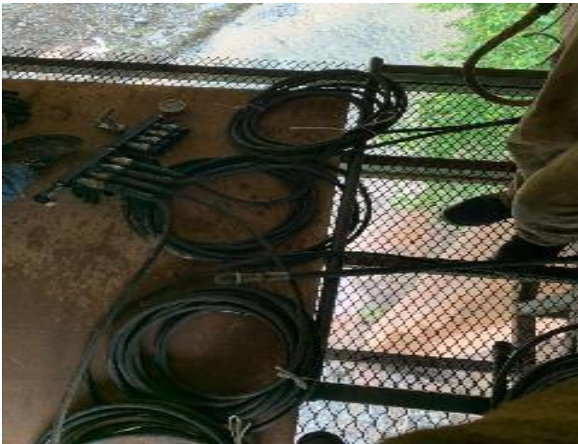
Figura XLVIII. Autoría Propia. Manómetro, mangueras hidráulicas, repartidor y conexiones rápidas para conectar en serie 4 gatos hidráulicos.
