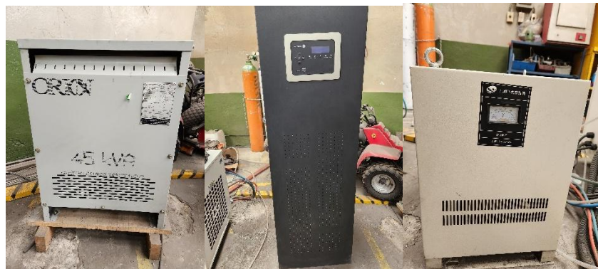
ILUSTRACIÓN 3.7 TRANSFORMADOR, REGULADOR, SUPRESOR
