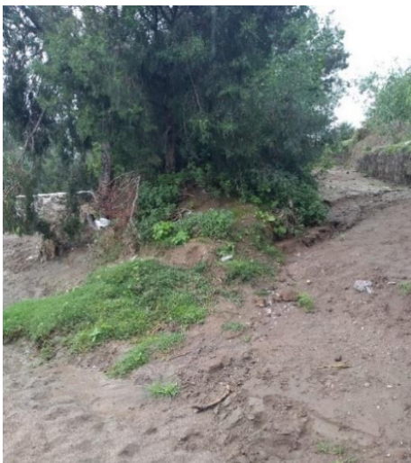
Ilustración 27. Foto Canal de derivación Fuente: propia
