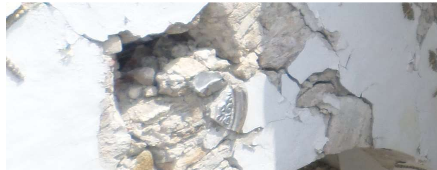
Imagen 2: Detalle de afectaciones presentes en muro interior poniente en Nave tramo 2
