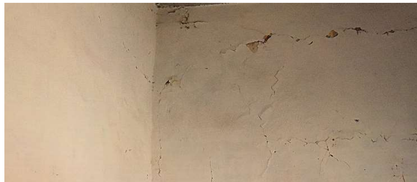
Imagen 1: Vista de afectaciones en parte alta de muro interior norte
