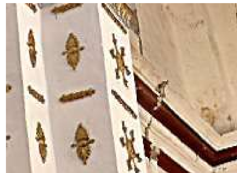
Imagen 2: Detalle de afectaciones en juego de molduras de muro interior sur
