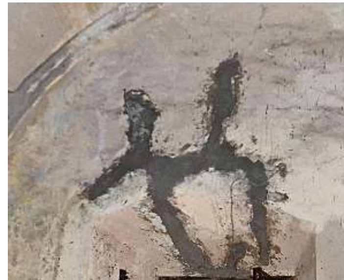
Imagen 1: Detalle de afectaciones en muro interior norte
