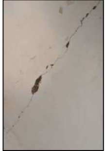
F04. Detalle de afectaciones presentes en intradós de bóveda de presbiterio
