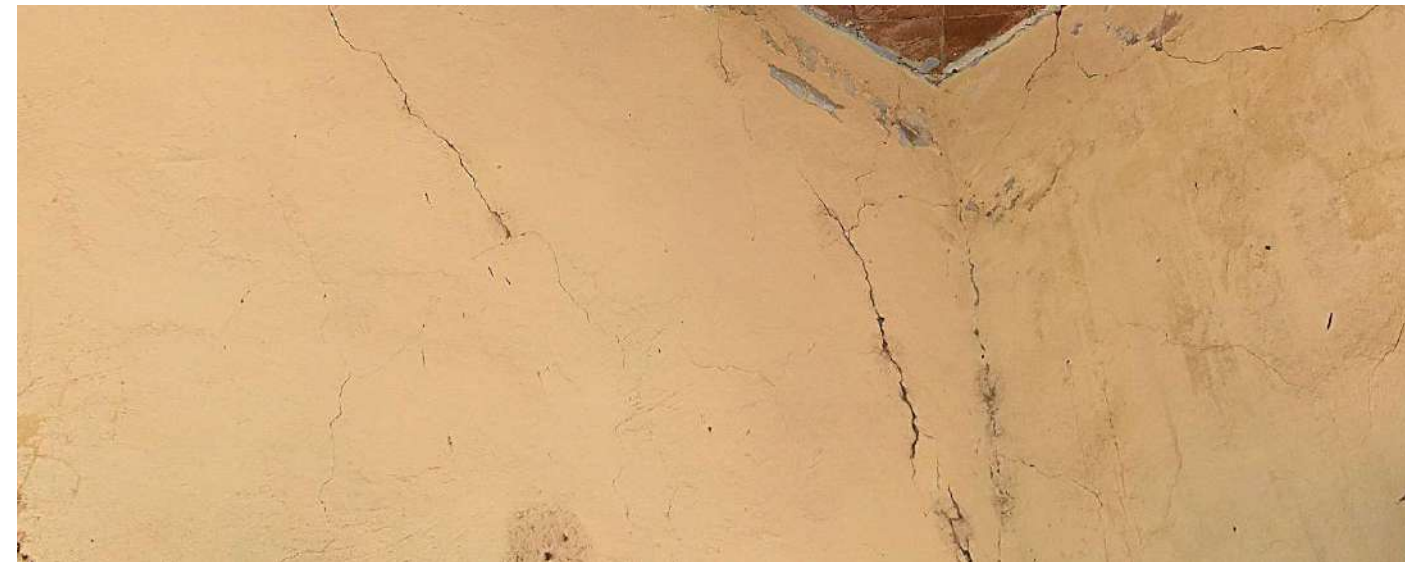
Imagen 1: Agrietamientos y fisuras presentes en sección de muro interior poniente
