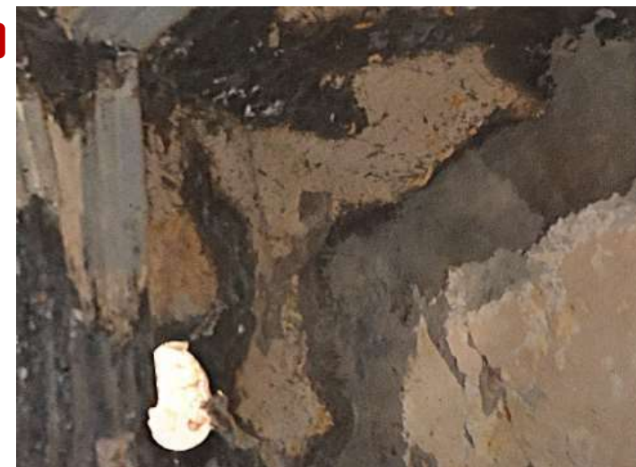
Imagen 3: Agrietamientos y recubrimientos en mal estado en intradós de cúpula
