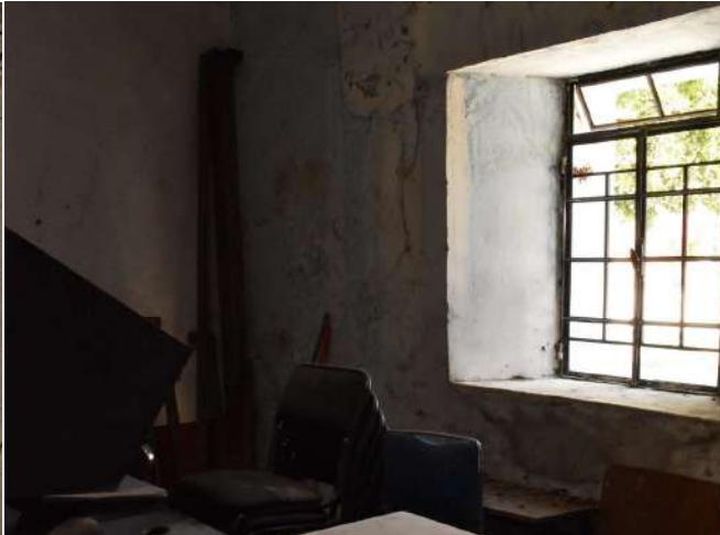
Imagen 3: Vista de afectaciones en parte baja de muro interior oriente
