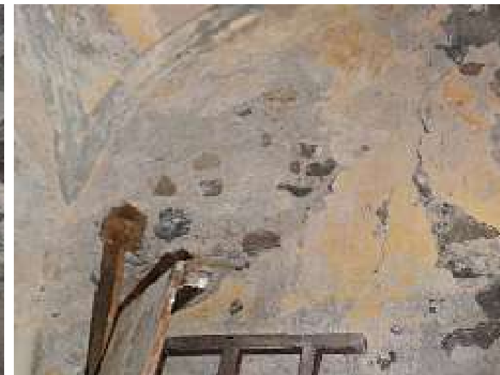
Imagen 4: Vista de afectaciones presentes en parte alta de muro interior sur
