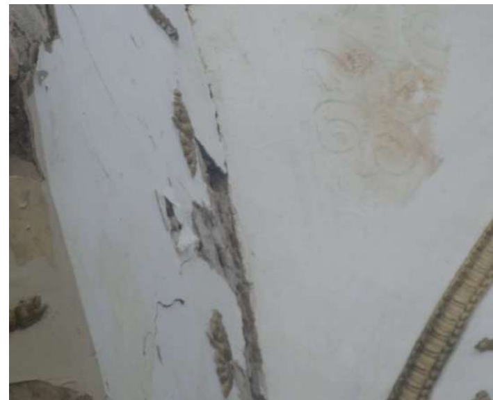
Imagen 1: Detalle de fracturas en unión de arco fajón oriente y pechina suroriente en Nave tramo 2
