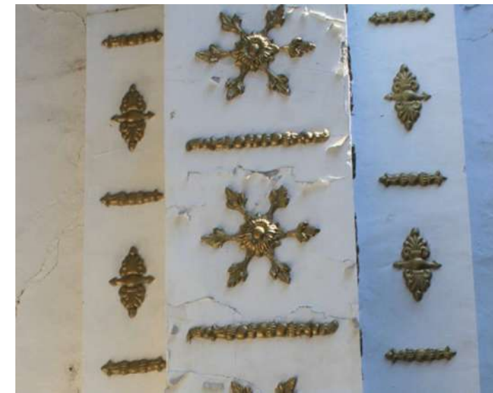
Imagen 2: Detalle de afectaciones presentes en fuste de pilastra nororiente
