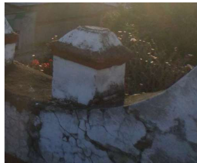
Imagen 3: Detalle de fisuras en remate de imafronte
