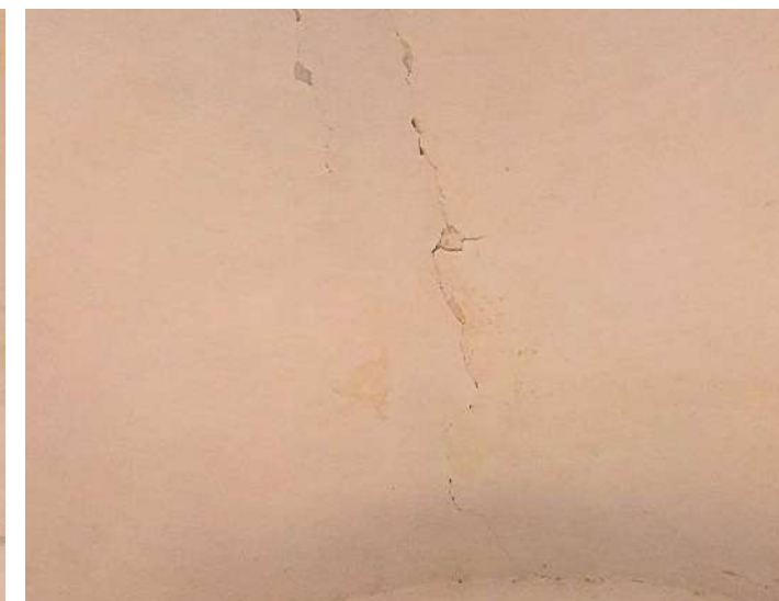
Imagen 3: Detalle de agrietamientos en intradós de bóveda
