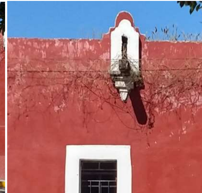
Imagen 2: Detalle de deterioros en bajada de agua pluvial
