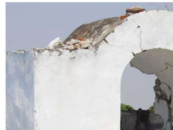
Imagen 4: Detalle de afectaciones en arco de espadaña vista oriente
