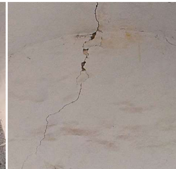
Imagen 2: Detalle de agrietamientos en parte alta de muro interior sur
