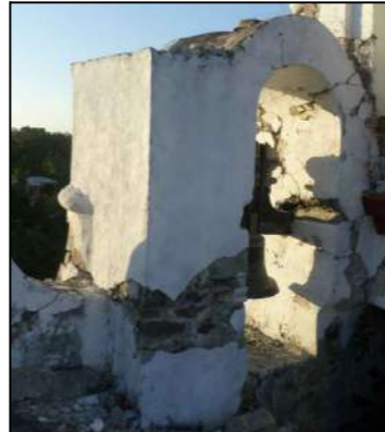
F03. Detalle de deterioros presentes en espadaña, fachada oriente
