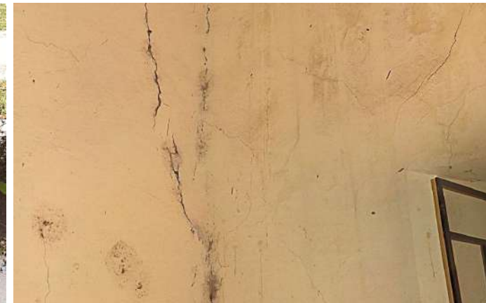
Imagen 3: Detalle de agrietamientos en muro interior norte
