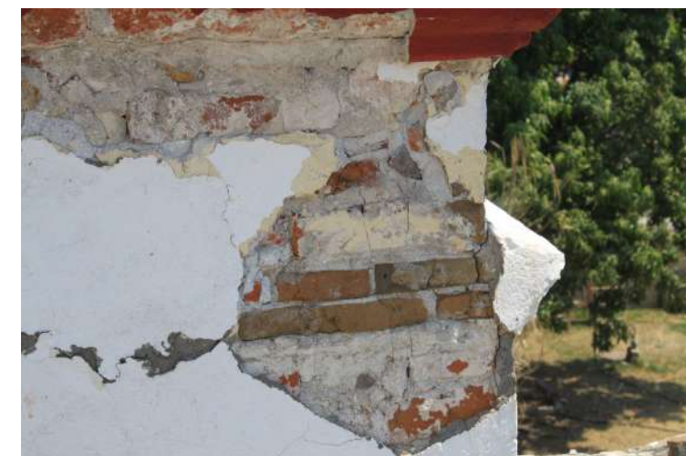
Imagen 1: Detalle de deterioros existentes en fachada oriente
