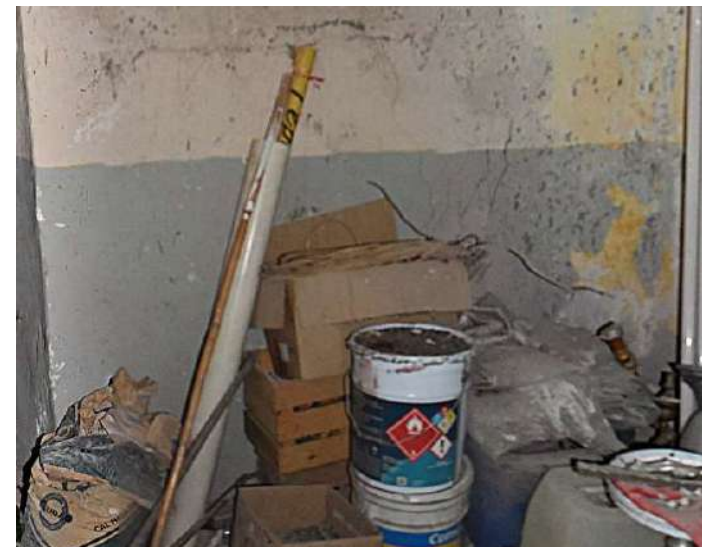
Imagen 3: Detalle de afectaciones presentes en parte baja de muro interior norte
