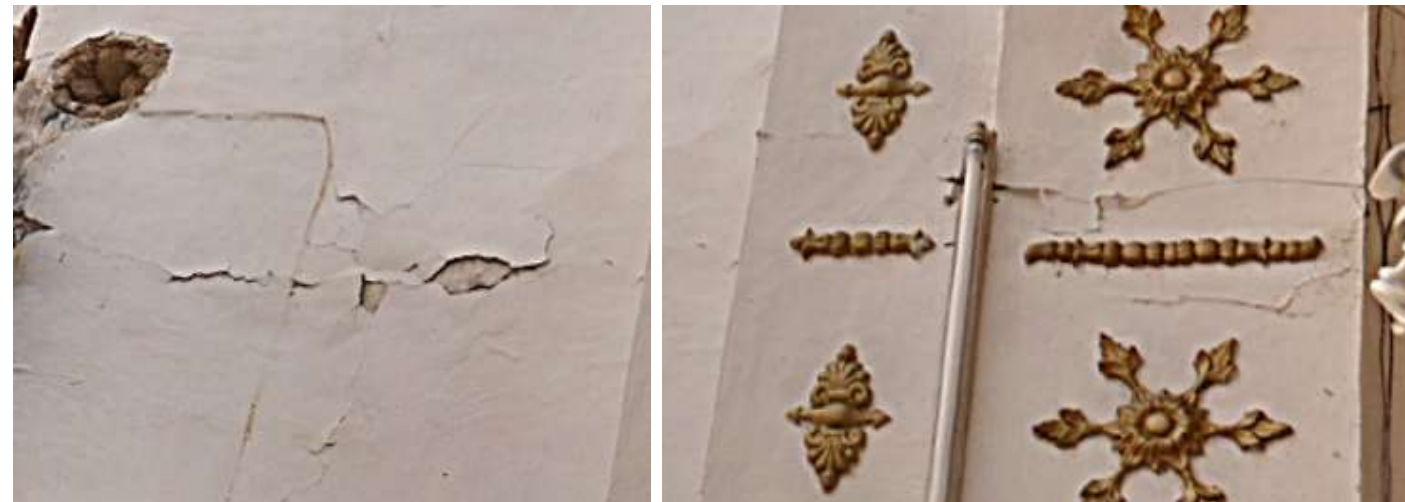
Imagen 2: Detalle de afectaciones en muro interior norte de Nave tramo 2
