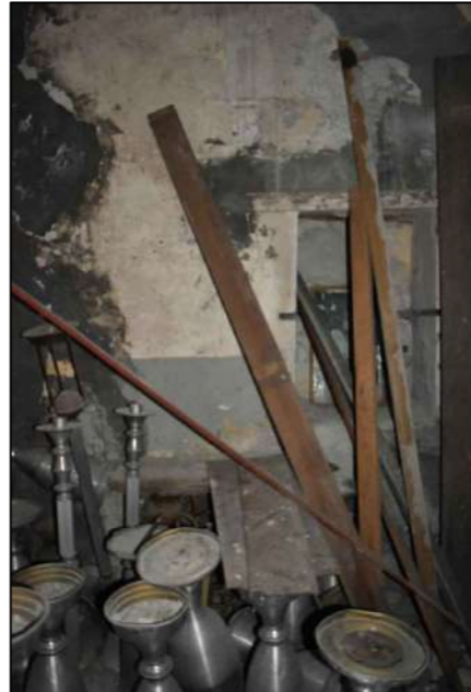
F02. Detalle de deterioros existentes en muro interior oriente de Baptisterio
