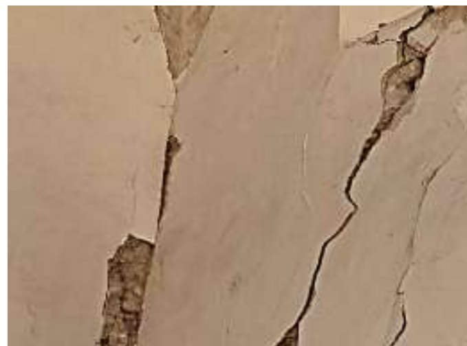
Imagen 2: Detalle de afectaciones presentes en parte alta de muro interior sur
