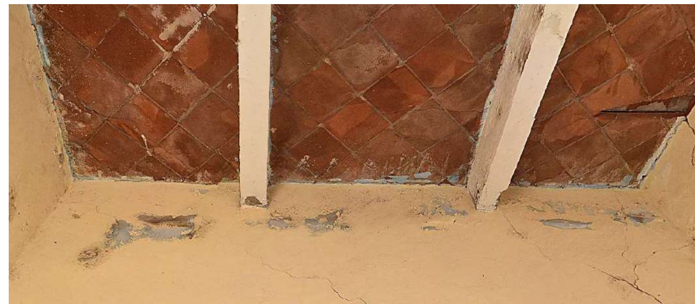
Imagen 2: Sección de intradós de cubierta con afectaciones
