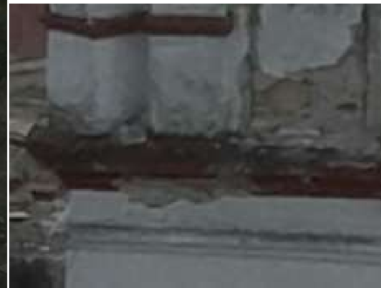
Imagen 3: Detalle de deterioros en parte baja de segundo cuerpo de torre, fachada norte
