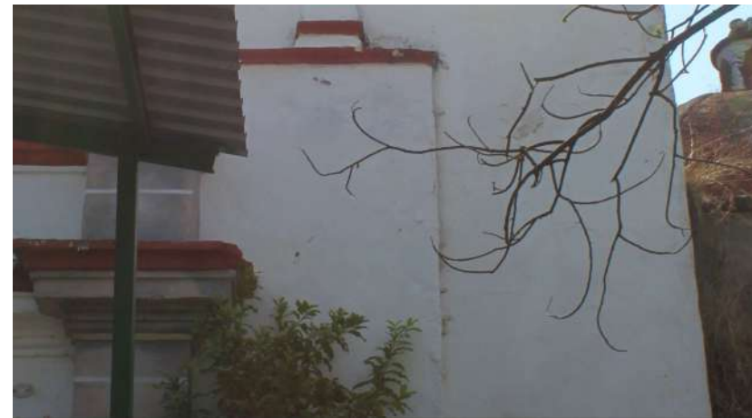
Imagen 2: Vista de afectaciones parte sur de fachada principal
