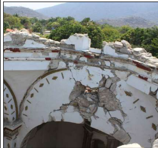
F01. Detalle de deterioros en muro y arco fajón de Presbiterio
