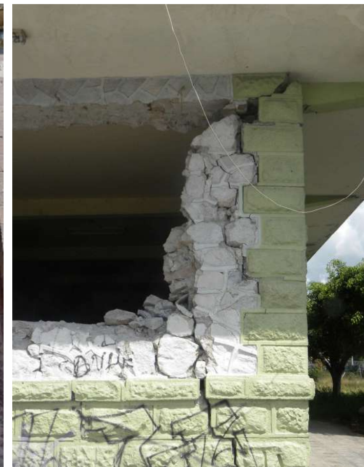
Colapso parcial y fracturas en muro de piedra Ex estación de ferrocarril de Izúcar de Matamoros Sánchez Paulino, 2018
