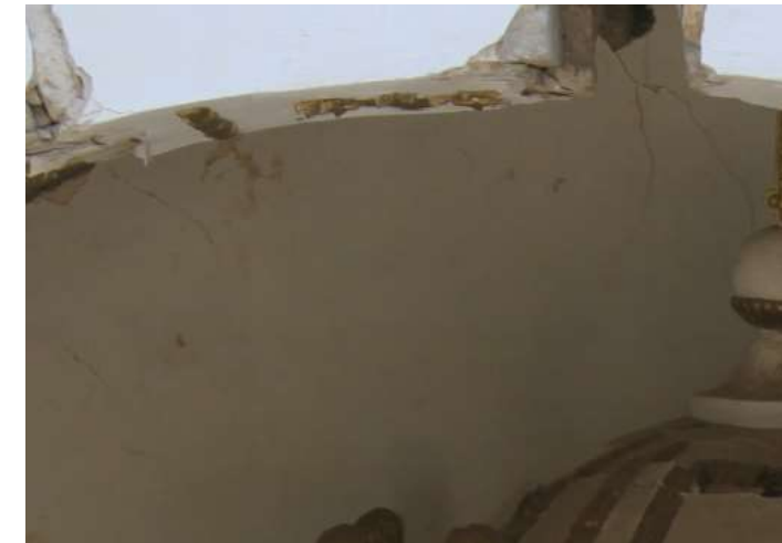
Imagen 3: Detalle de fisuras y agrietamientos en muro interior oriente
