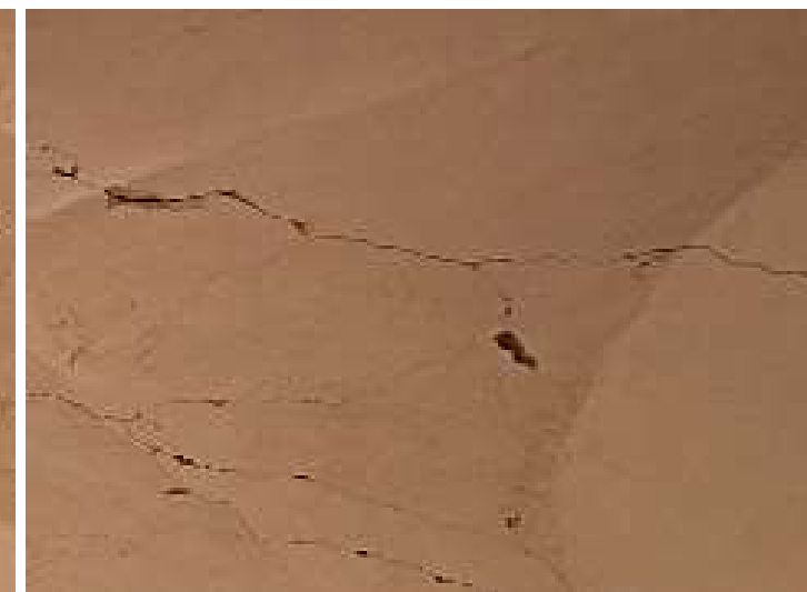
Imagen 3: Detalle de afectaciones en intradós de cubierta
