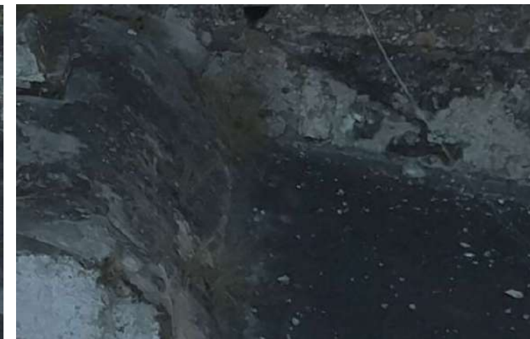
Imagen 3: Detalle de vegetación parásita en azotea
