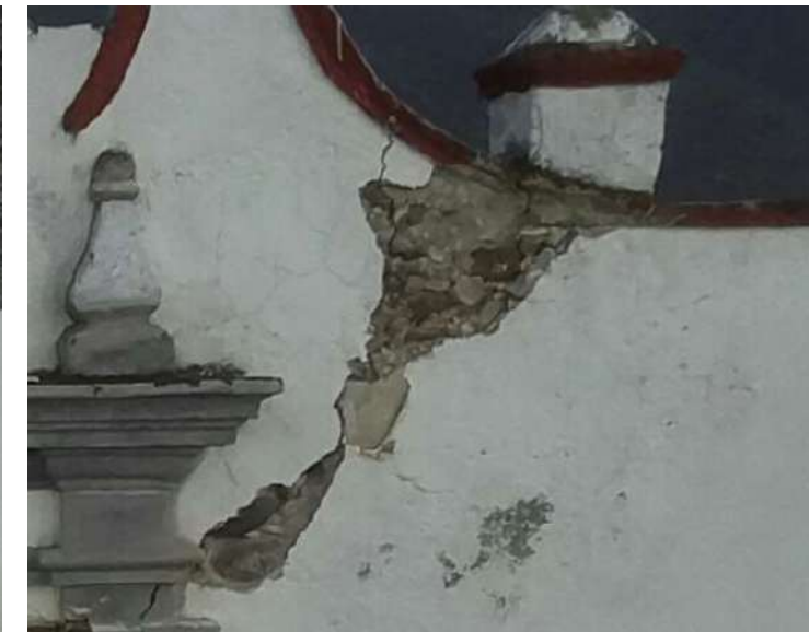
Imagen 2: Vista de afectaciones en imafronte fachada poniente
