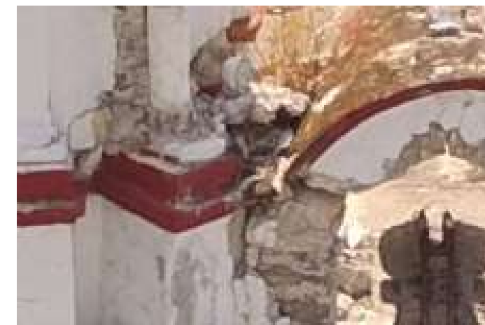
Imagen 3: Detalle de deterioros en espadaña
