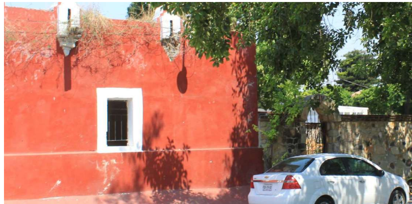
Imagen 1: Vista general de muro exterior oriente
