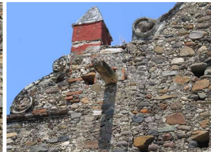
Imagen 4: Detalle de agrietamientos presentes en elementos de remate del muro exterior oriente
