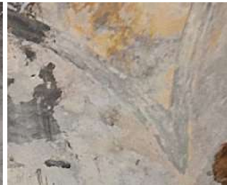
Imagen 2: Estado de los recubrimientos presentes en muro interior oriente
