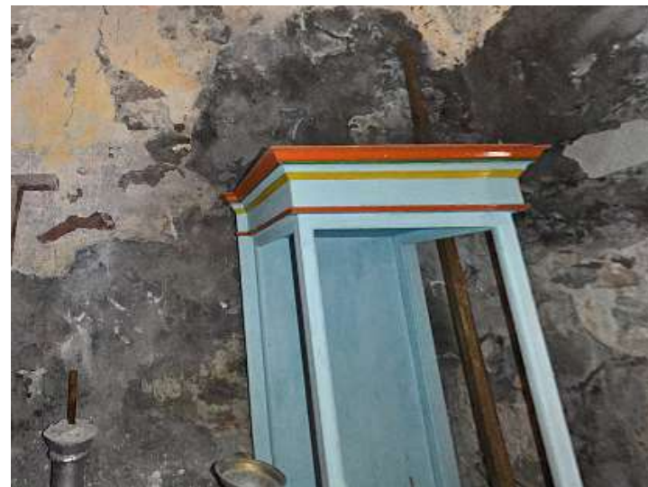
Imagen 3: Detalle de los aplanados existentes en muro interior sur
