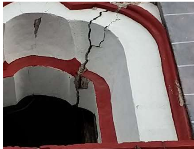
Imagen 2: Detalle de agrietamientos en ventana coral
