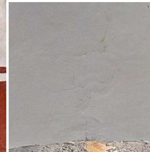
Imagen 3: Detalle de fisuras en parte alta de muro interior oriente
