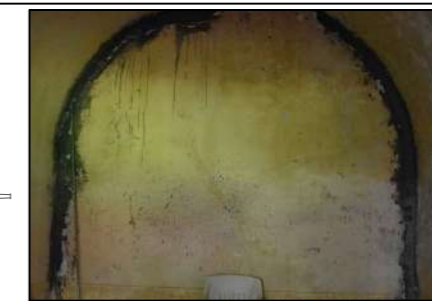
F01. Detalle de afectaciones en muro interior sur de Anexo 2
