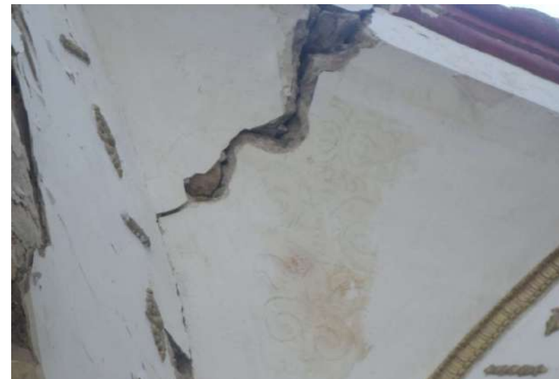
Imagen 2: Detalle de afectación en pechina surorientado en Nave tramo 2
