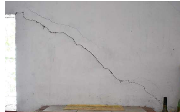
Imagen 3: Detalle de grieta en muro interior poniente
