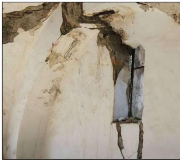
F03. Detalle de afectaciones en interior sur de Nave tramo 1
