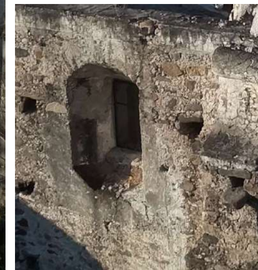
Imagen 3: Detalle de deterioros presentes en ventana y muro exterior sur
