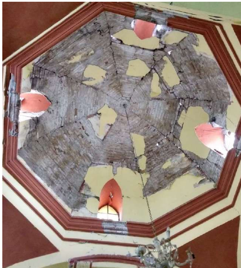
Cúpula octogonal de mampostería de ladrillo con grietas multidireccionales en sección media Templo de San Mateo, Matzaco, Puebla. Sánchez Paulino, 2019.
