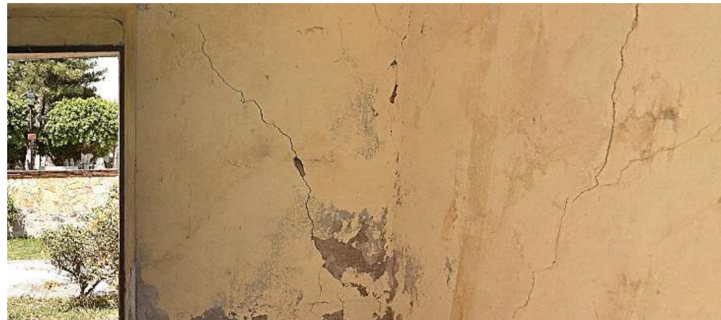
Imagen 1: Vista de afectaciones presentes en muro interior norte
