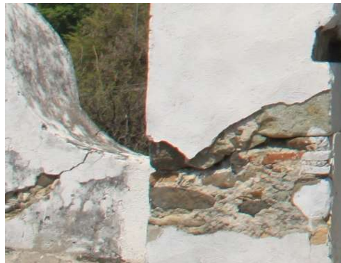
Imagen 3: Detalle de agrietamientos en base de espadaña vista oriente
