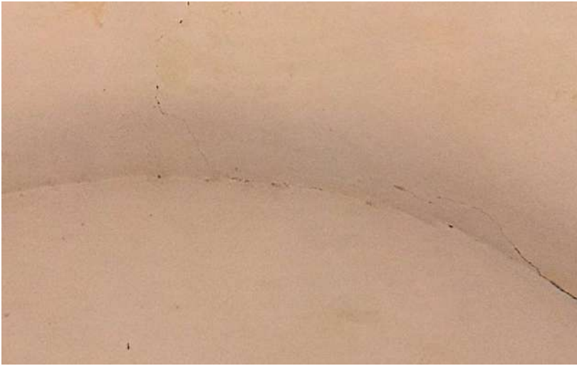
Imagen 3: Agrietamientos en unión de muro interior sur y bóveda
