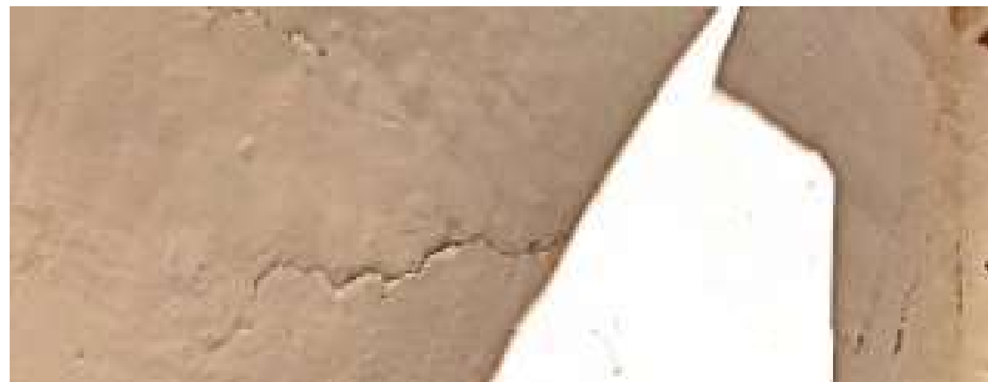
Imagen 1: Detalle de agrietamientos y fisuras presentes en muro interior sur
