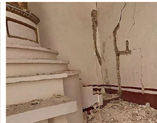
Imagen 3: Detalle de afectaciones presentes en parte baja de muro interior sur
