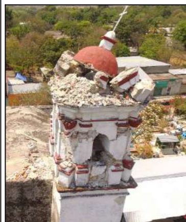
F01. Estado actual del segundo cuerpo de torre campanario fachada norte
