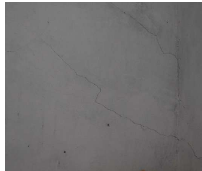
Imagen 2: Detalle de fisuras en muro interior sur
