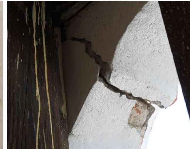
Imagen 2: Detalle de afectación en ventana coral
