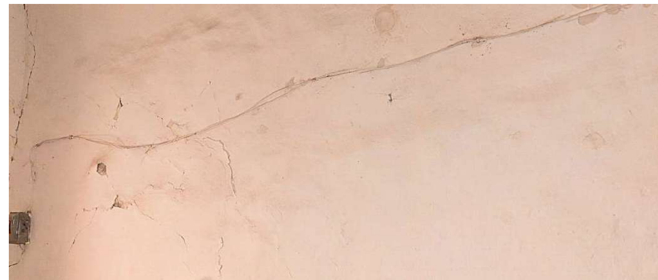
Imagen 2: Vista general de afectaciones en parte alta de muro interior poniente
