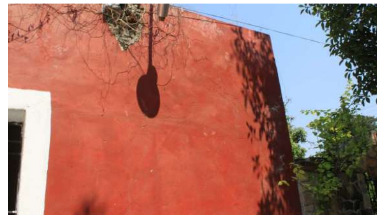
Imagen 2: Detalle de afectaciones presentes en muro exterior oriente
