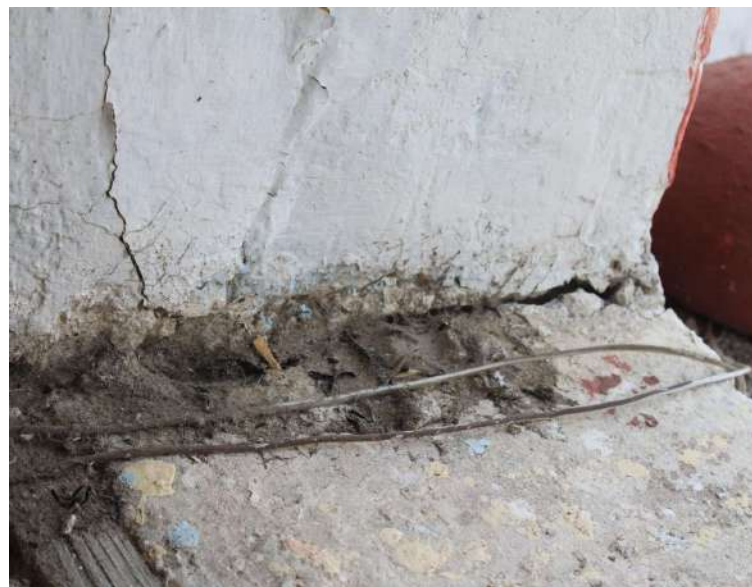
Imagen 3: Afectaciones presentes en muro de ventana coral
