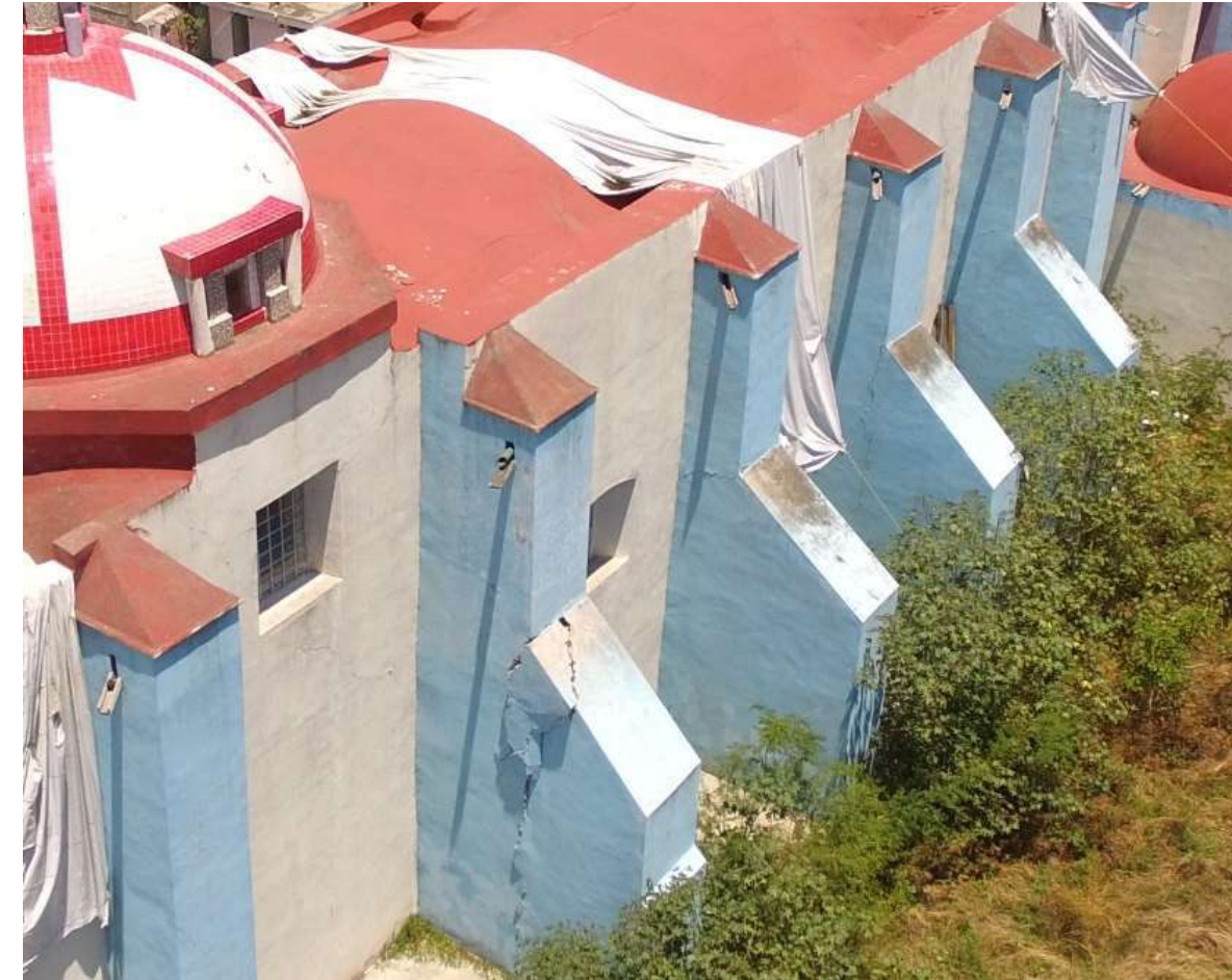
Contrafuerte con fracturas y agrietamientos Templo de San Martín Caballero, Totoltepec, Puebla. Archivo del MAECPE, 2018.
