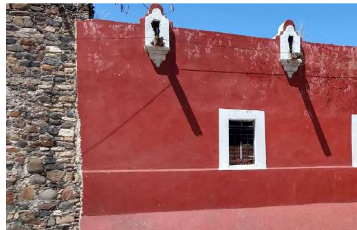
Imagen 2: Vista de afectaciones presentes en muro exterior oriente
