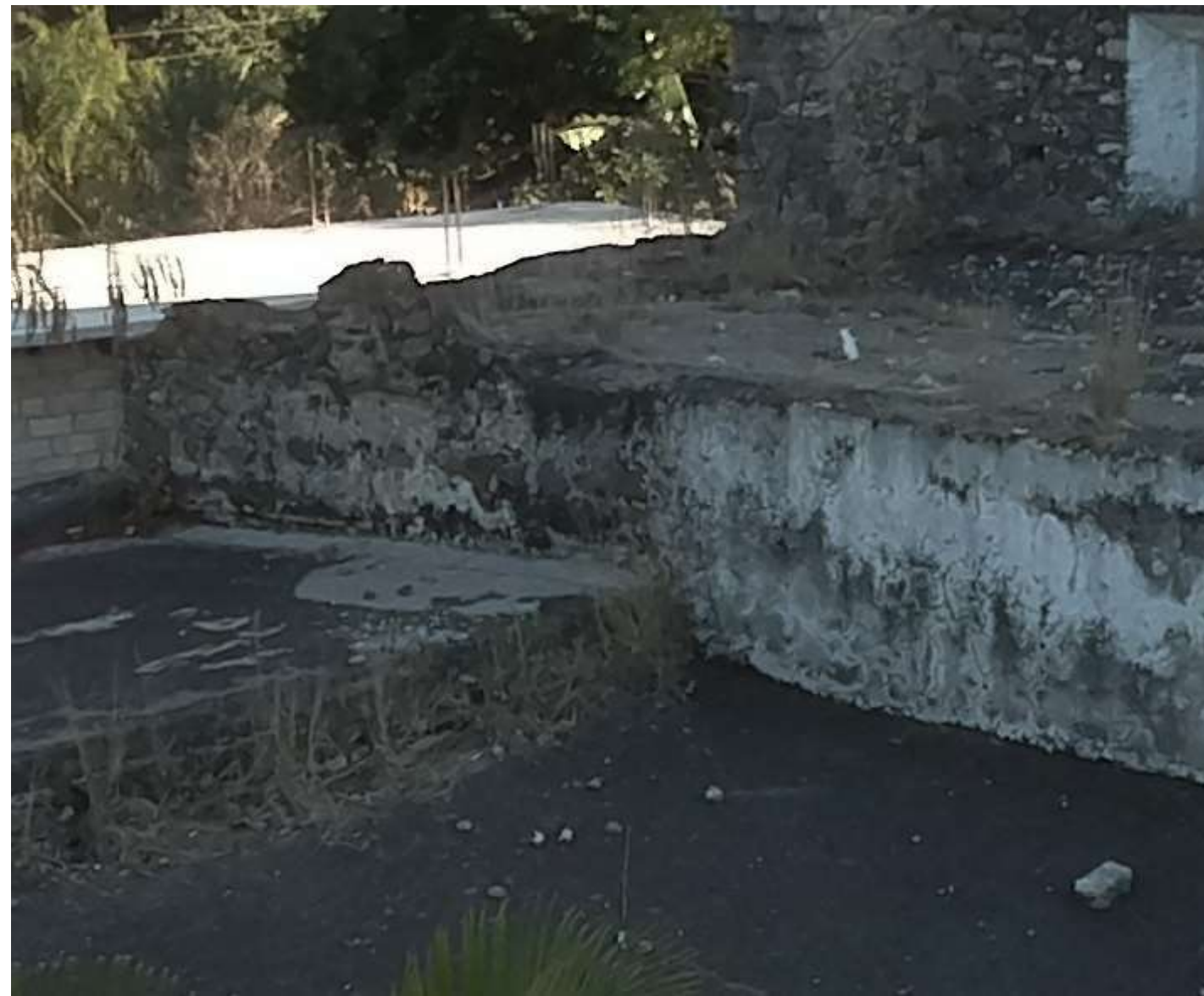
Imagen 1: Vista general de afectaciones en muro exterior norte
