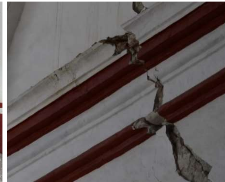
Imagen 3: Detalle de afectaciones presentes en juego de molduras en muro interior sur
