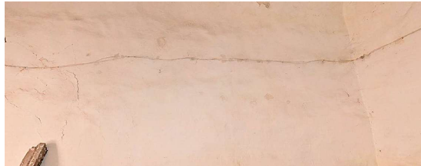
Imagen 1: Detalle de deterioros en sección del muro interior poniente
