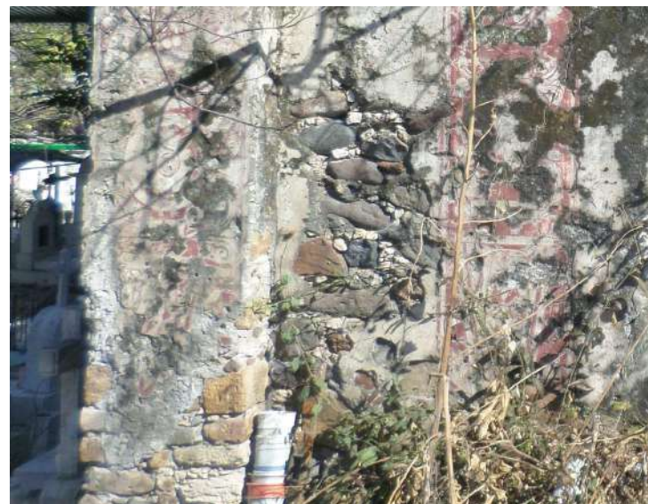
Imagen 3: Detalle de los desprendimientos de aplanados
