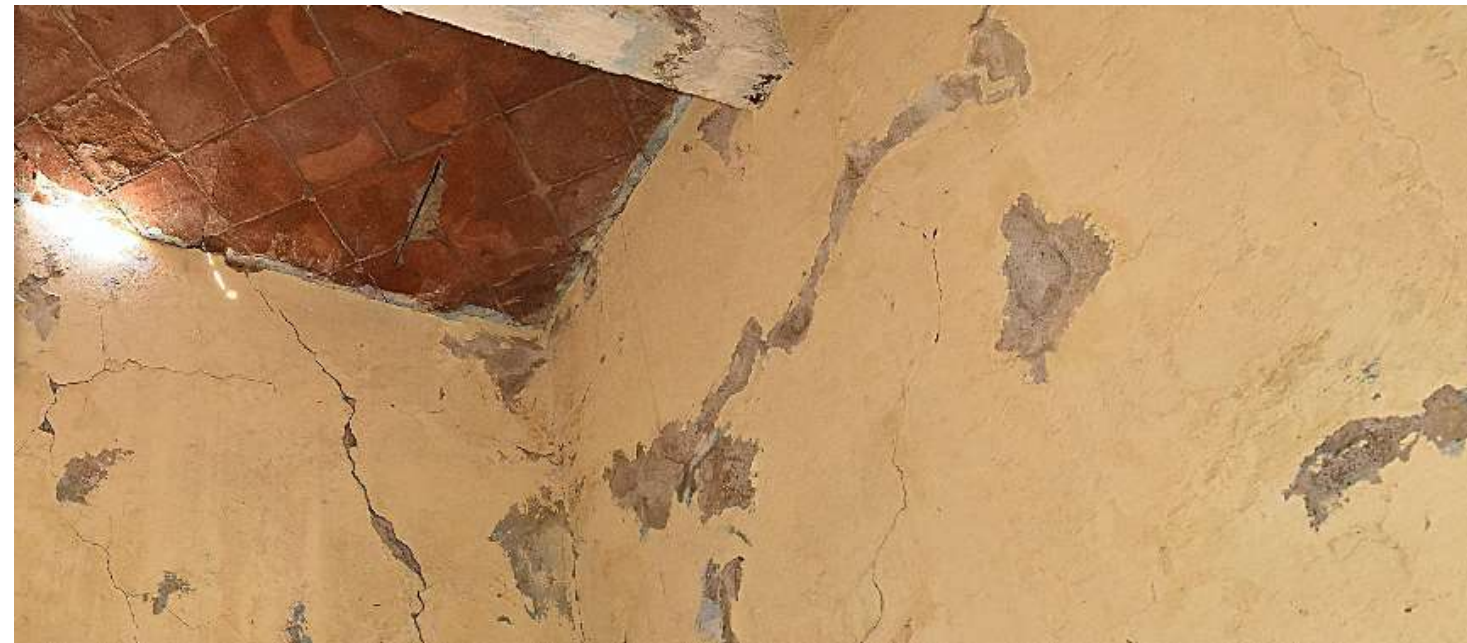
Imagen 1: Vista de afectaciones en parte alta de muro interior norte
