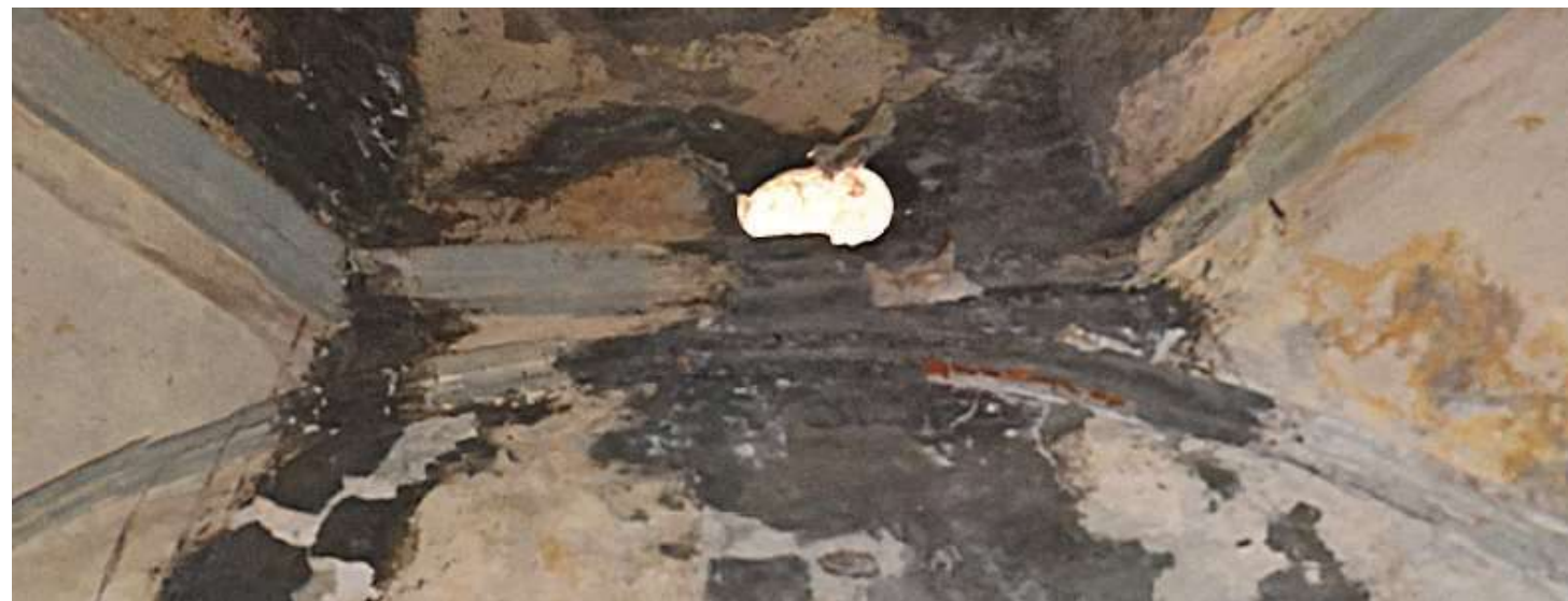
Imagen 2: Estado actual de parte alta de muro interior oriente y unión con tambor de cúpula
