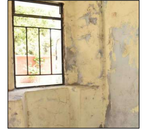
F03. Detalle de afectaciones en muro interior oriente de Bodega 2
