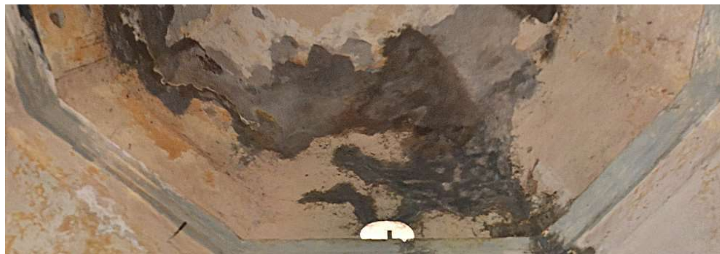
Imagen 3: Estado actual de tambor interior poniente
