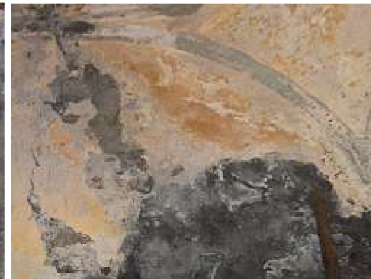
Imagen 2: Detalle de afectaciones existentes en muro interior sur
