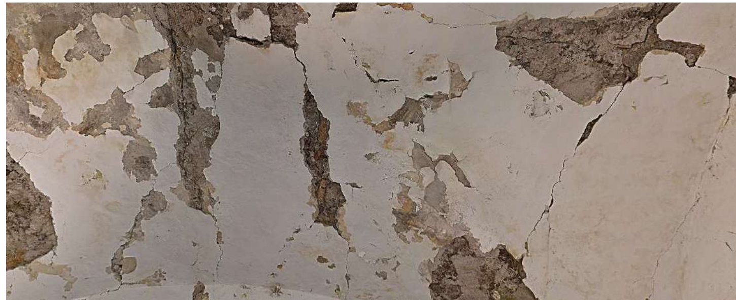
Imagen 2: Detalle de afectaciones en intradós de bóveda parta surorientado
