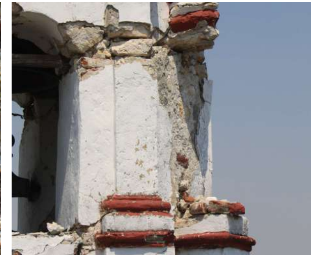
Imagen 3: Deterioros presentes en torre segundo cuerpo fachada oriente
