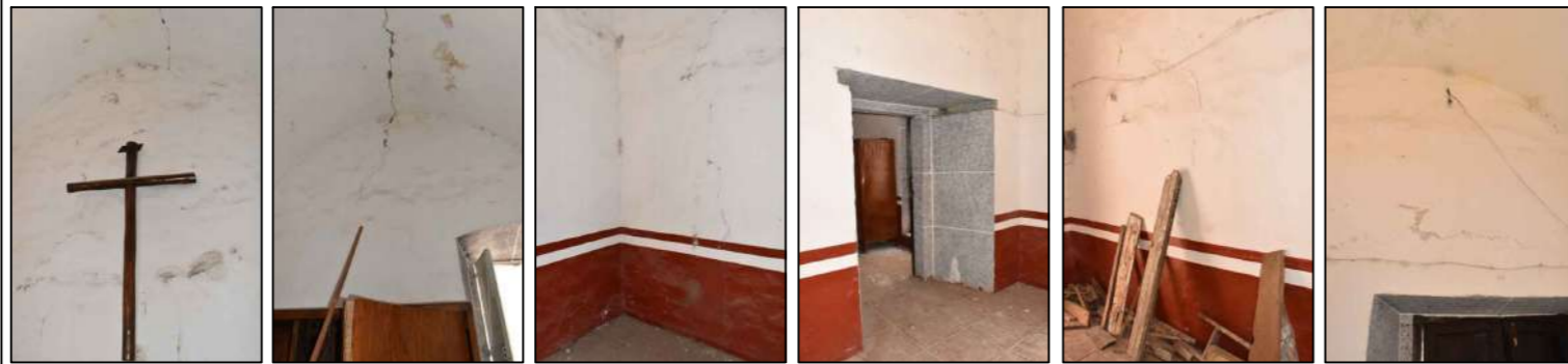
F01. Detalle de afectaciones en muro interior norte de Sacristía F02. Detalle de deterioros presentes en muro interior sur de Sacristía F03. Detalle de agrietamientos en muro interior norte y poniente de Sacristía F04. Vista de muro interior oriente de Anexo 1 F05. Vista de muro interior poniente de Anexo 1 F06. Detalle de afectaciones en muro interior norte de Anexo 1
