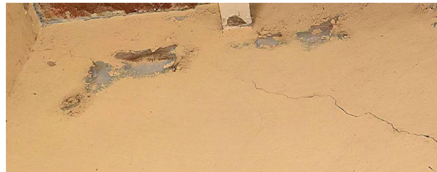
Imagen 2: Detalle de afectaciones presentes en muro interior poniente
