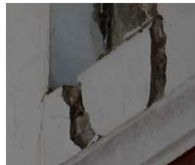
Imagen 3: Vista de afectaciones existentes en parte baja de ventana interior sur
