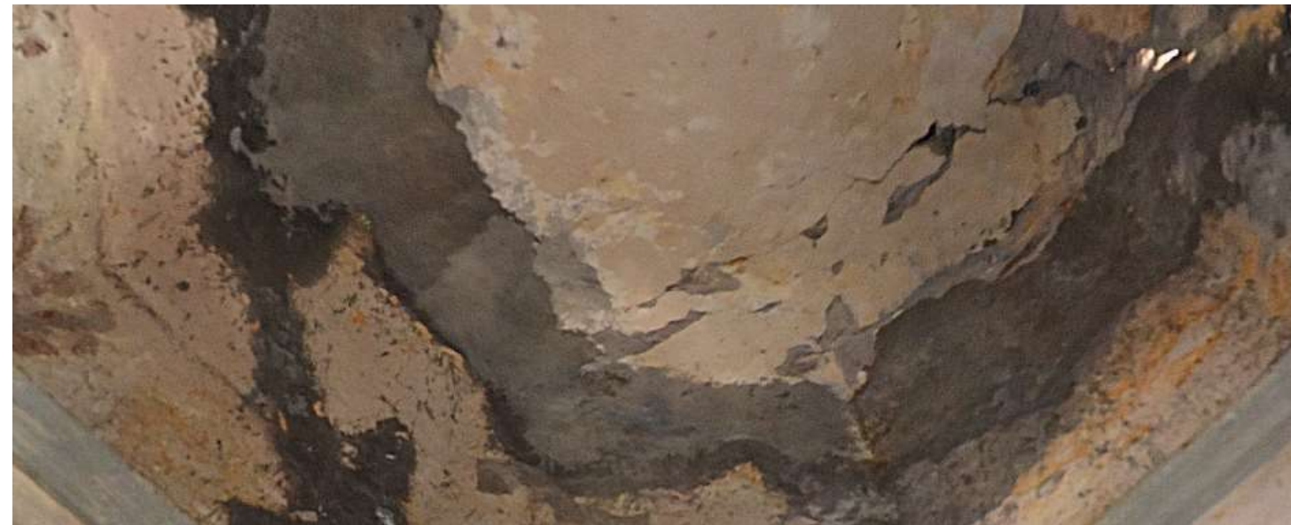
Imagen 1: Vista general del estado actual de parte alta del tambor interior oriente
