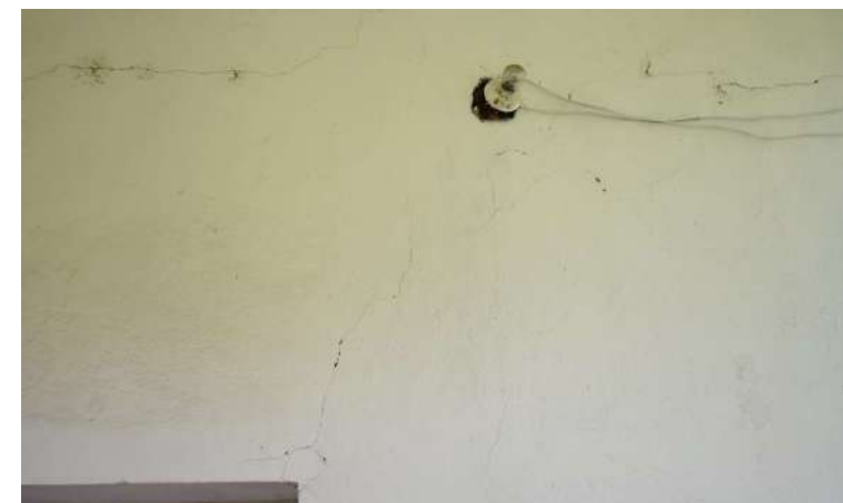
Imagen 2: Detalle de afectaciones presentes en muro exterior norte
