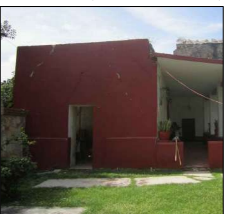
F03. Detalle de afectaciones presentes en muro exterior norte de Bodega 2
