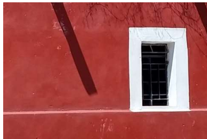
Imagen 3: Fisuras en muro exterior oriente
