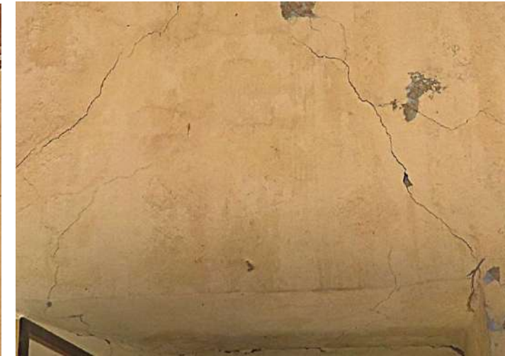
Imagen 3: Fisuras y agrietamientos en muro interior norte
