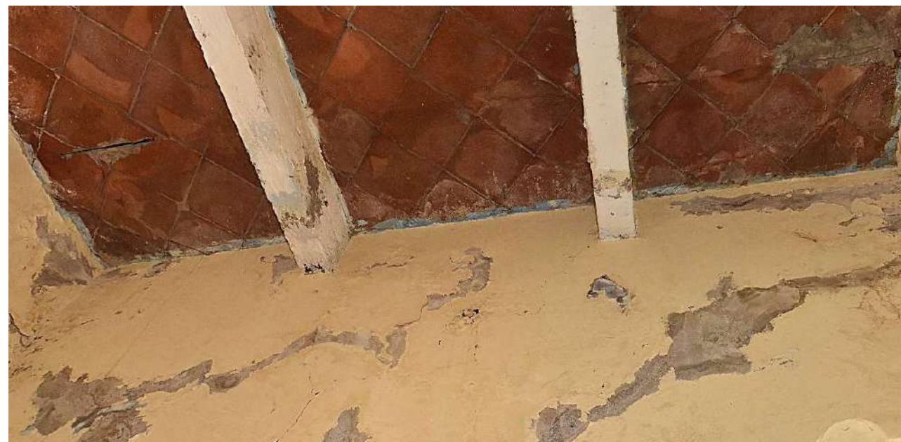
Imagen 2: Vista de afectaciones en intradós de cubierta
