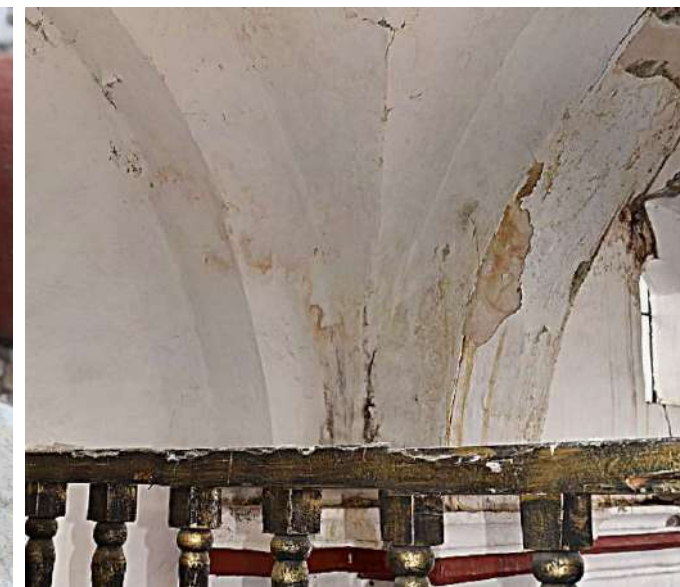
Imagen 4: Detalle de afectaciones en elementos del Coro
