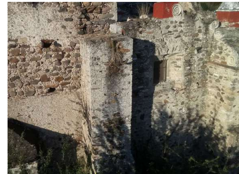
Imagen 2: Vista de afectaciones en segundo cuerpo de contrafuerte
