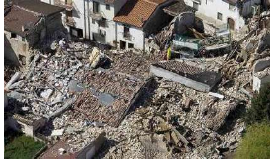
Imagen 2. Daños del sismo en L'Aquila, Italia (2009) Fuente: http://exploretherisks.weebly.com
