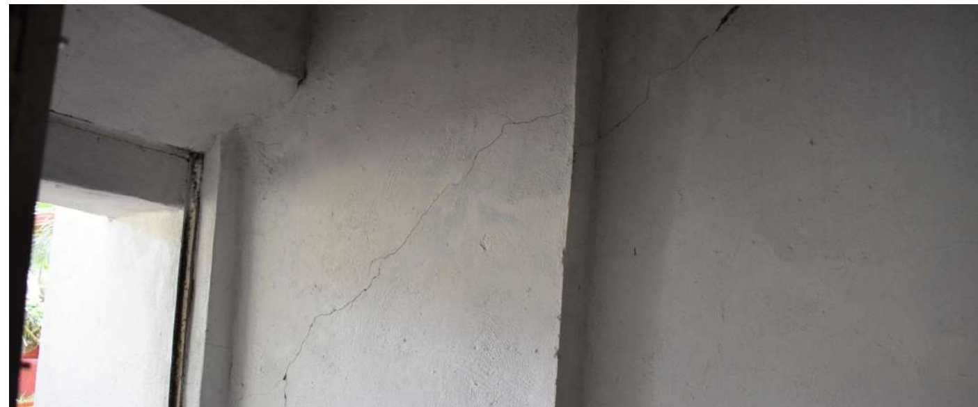
Imagen 1: Daños presentes en muro interior norte
