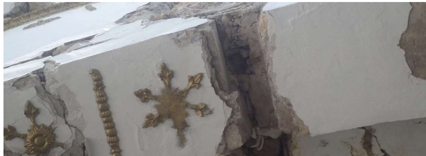
Imagen 2: Detalle de afectaciones en intradós de arco fajón oriente de Nave tramo 2
