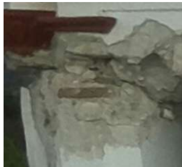
Imagen 2: Detalle de agrietamientos en segundo cuerpo de torre campanario
