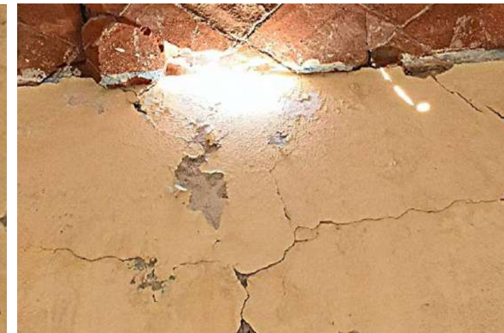
Imagen 3: Detalle de fractura presente en unión de cubierta y muro interior norte
