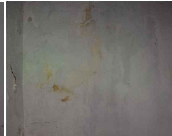
Imagen 3: Humedades en muro interior sur
