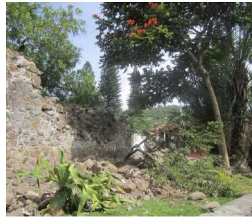
Imagen 18. Daños presentes en barda atrial del templo de San Agustín Obispo Fuente: Sánchez Paulino
