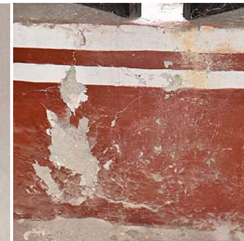
Imagen 2: Detalle de afectaciones en parte baja de muro interior oriente
