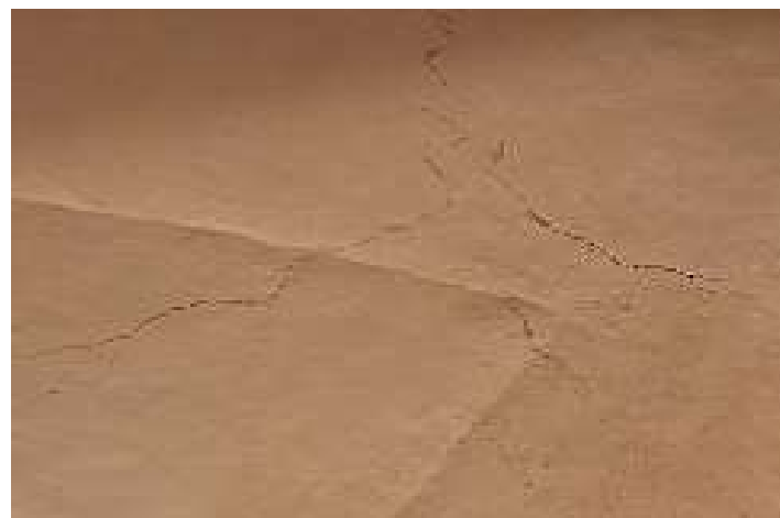
Imagen 2: Detalle de afectaciones presentes en intradós de cubierta
