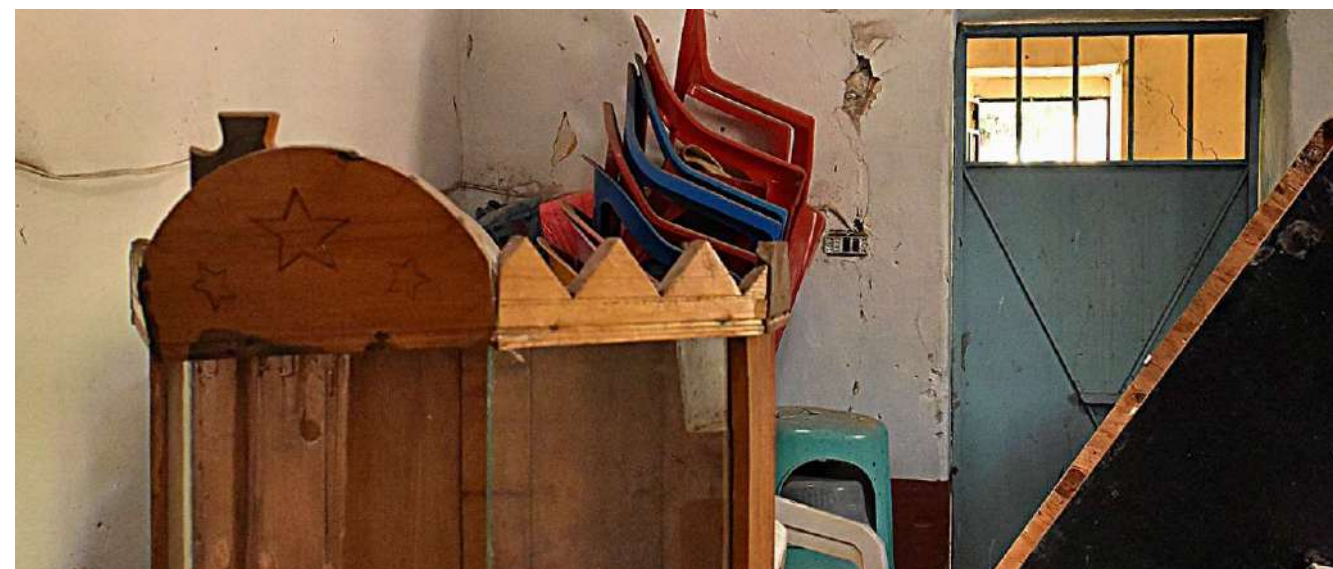
Imagen 2: Vista de afectaciones en parte baja de muro interior norte
