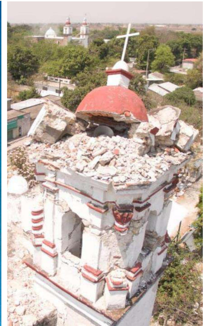
Imagen 2: Daños producidos en segundo cuerpo de torre campanario lado nororiente, tras el sismo del 19 de septiembre del año 2017
