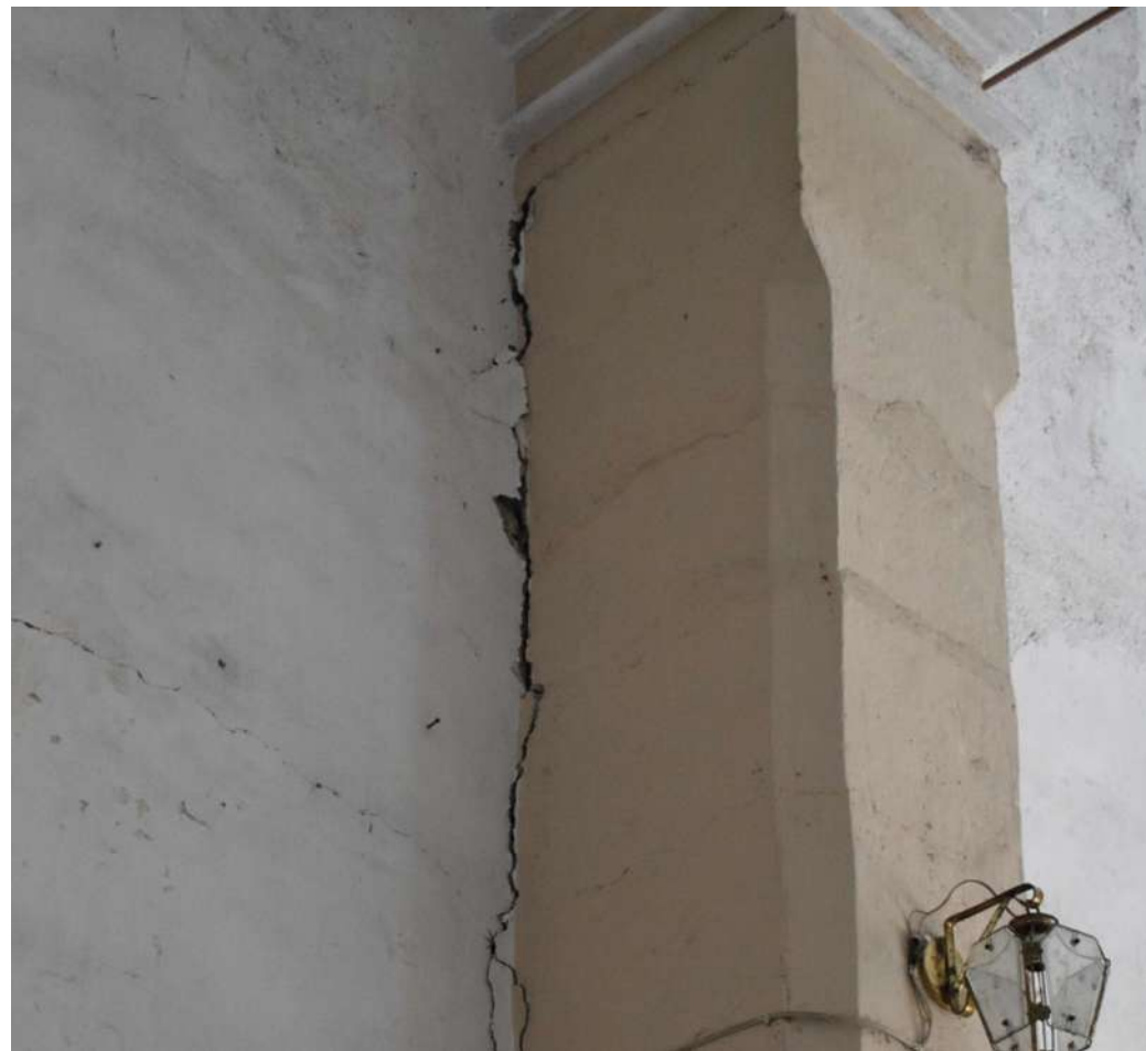
Una afectación muy común de las pilastras es la separación del elemento del muro adyacente Archivo MAECPE, 2018
