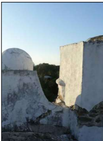
F03. Detalle de estado actual de espadaña fachada oriente
