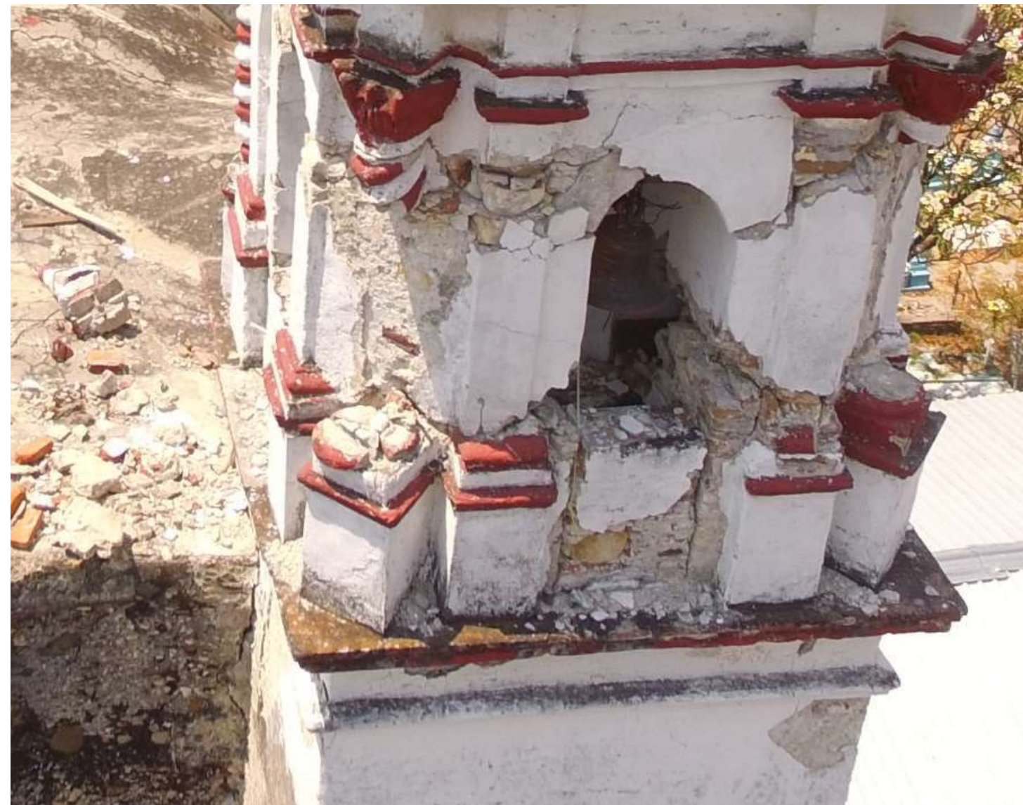
Imagen 1: Vista aérea general de afectaciones en torre campanario fachada norte
