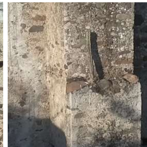
Imagen 2: Detalle de vegetación parásita presente en contrafuerte surorientado
