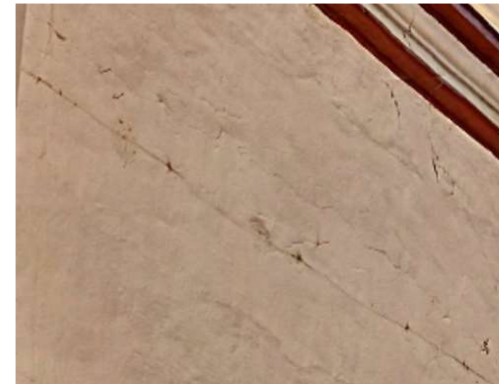
Imagen 4: Detalle de afectaciones existentes en muro interior norte
