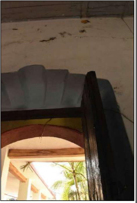
F03. Detalle de afectaciones presentes en muro interior poniente de Bodega 1
