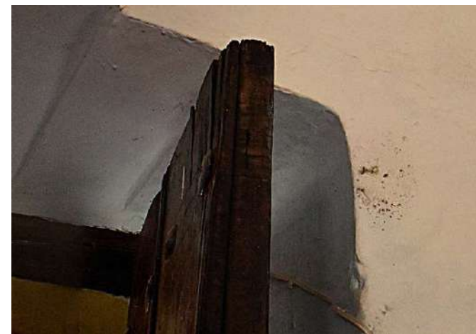
Imagen 2: Detalle de deterioro en muro interior poniente
