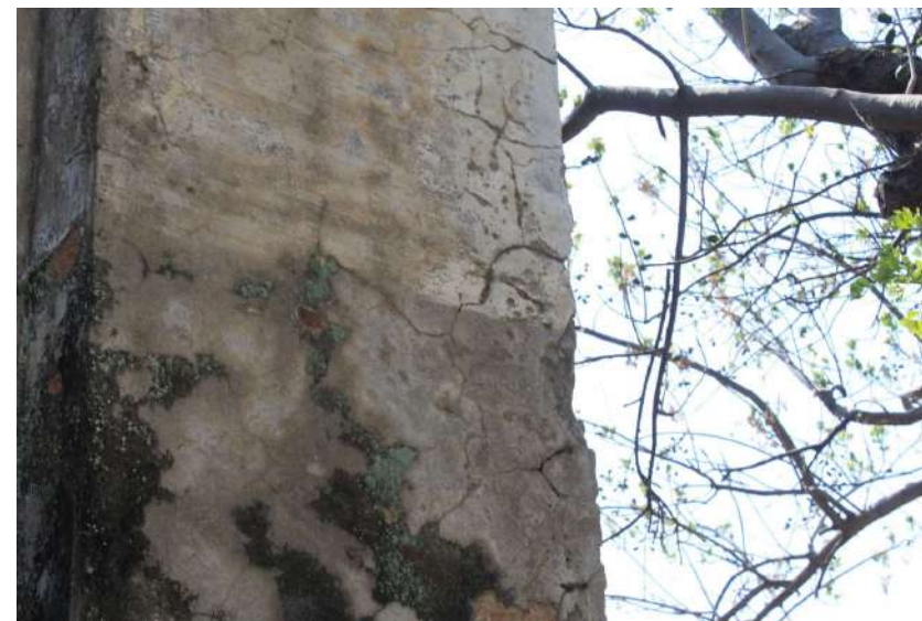
Imagen 2: Detalle de fisuras en muro exterior poniente
