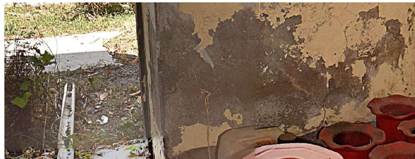
Imagen 2: Humedades y desprendimiento de recubrimientos principales afectaciones
