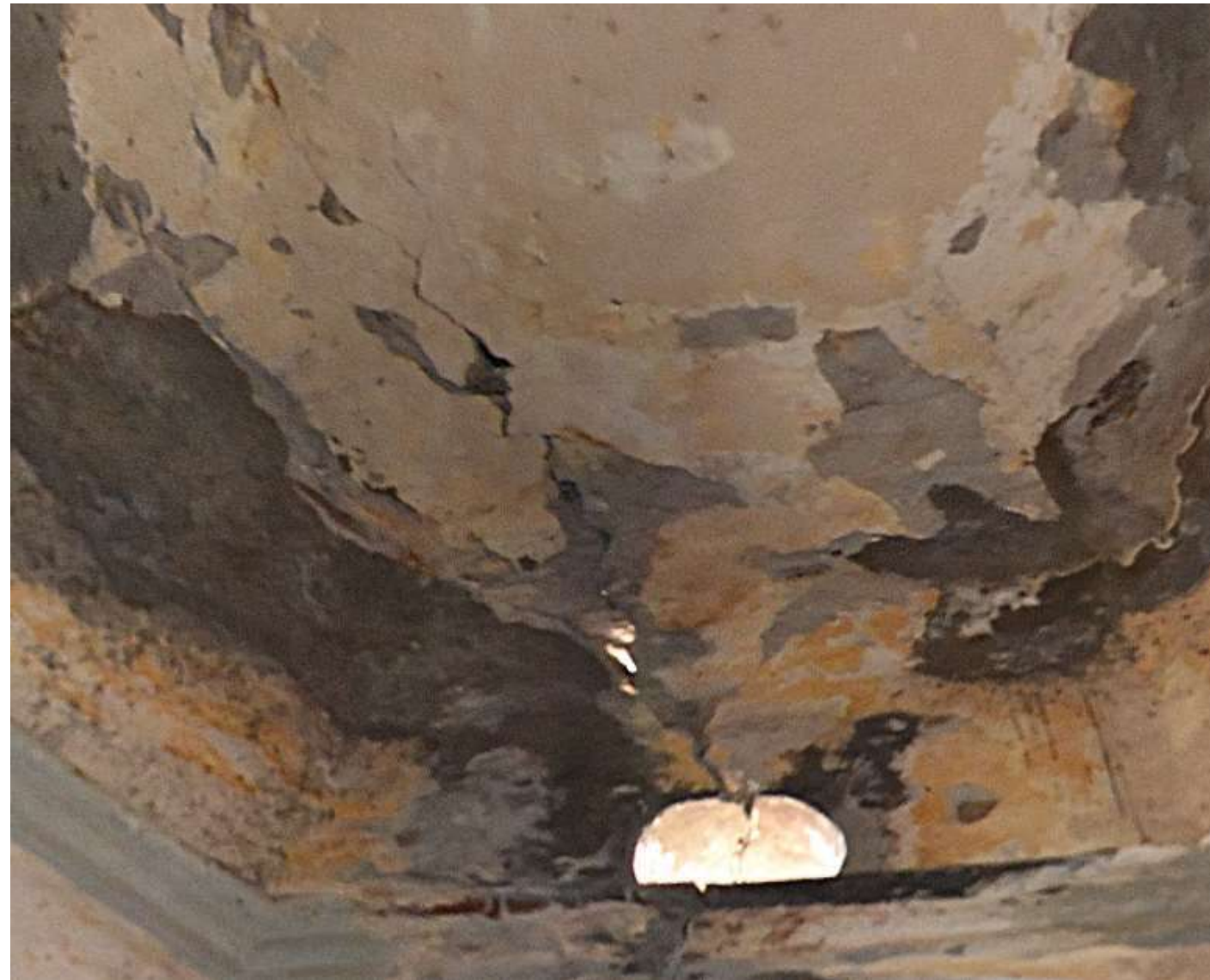
Imagen 1: Vista general del estado actual del tambor de cúpula en interior sur
