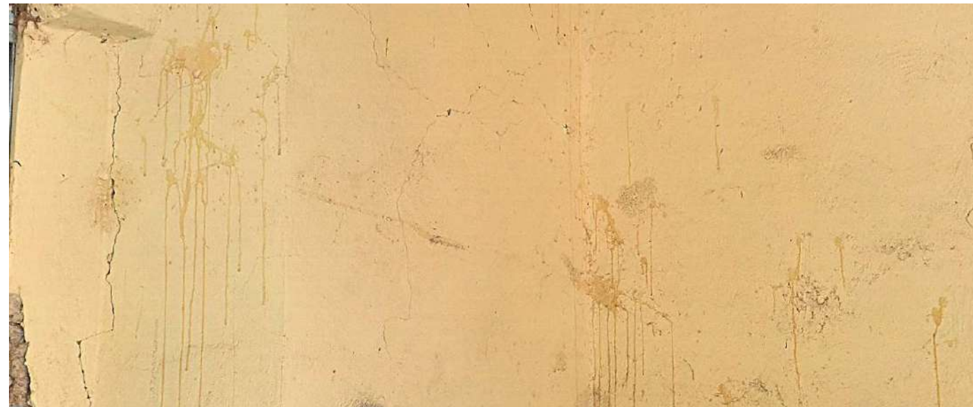
Imagen 2: Fisuras y agrietamientos principales daños en este sector del muro interior sur
