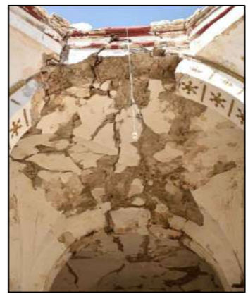
F02. Estado actual del intradós de bóveda en Nave segundo tramo, vista oriente-poniente
