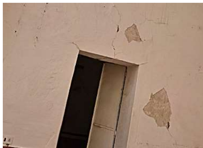
Imagen 2: Detalle de afectaciones presentes en parte baja de muro interior norte
