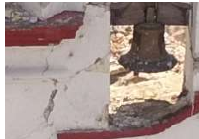
Imagen 2: Detalle de fisuras y agrietamientos base norte de espadaña fachada poniente
