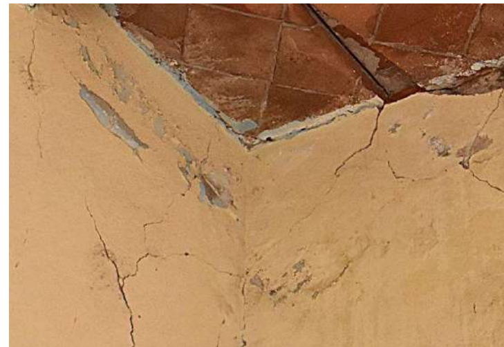
Imagen 2: Detalle de afectaciones presentes en muro interior norte
