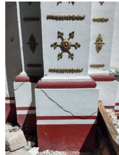
Imagen 2. Detalle de basa de pilastra Norte de Nave Tramo 2 Vista Frontal
