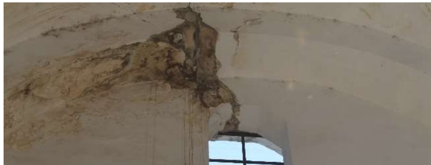
Imagen 1: Fracturas en dinteles de ventanas y arcos formeros
