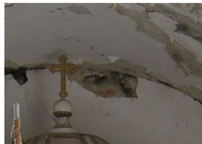
Imagen 2: Detalle de deterioros presentes en muro interior oriente
