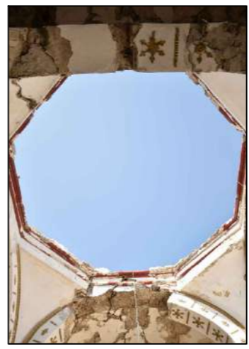
F01. Ausencia de cúpula debido a colapso
