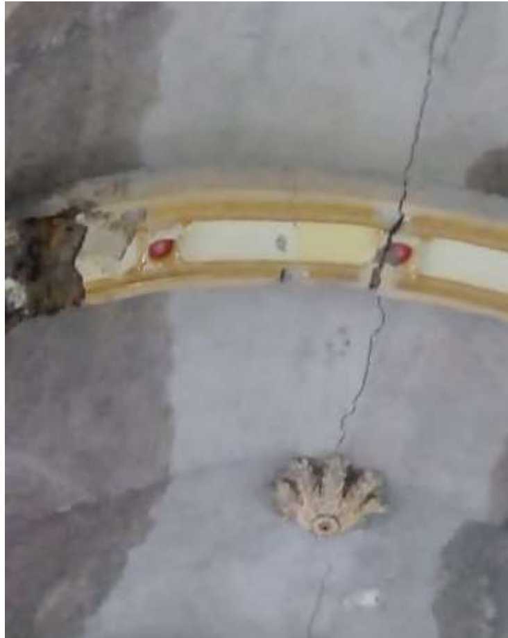
Grietas en clave y tercios de arco fajón. Templo de Santo Tomás de Aquino, Tlapanalá, Puebla, interior de nave Sánchez Paulino, 2018
