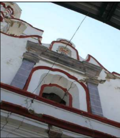
F02. Detalle de afectaciones en segundo cuerpo de Fachada Principal
