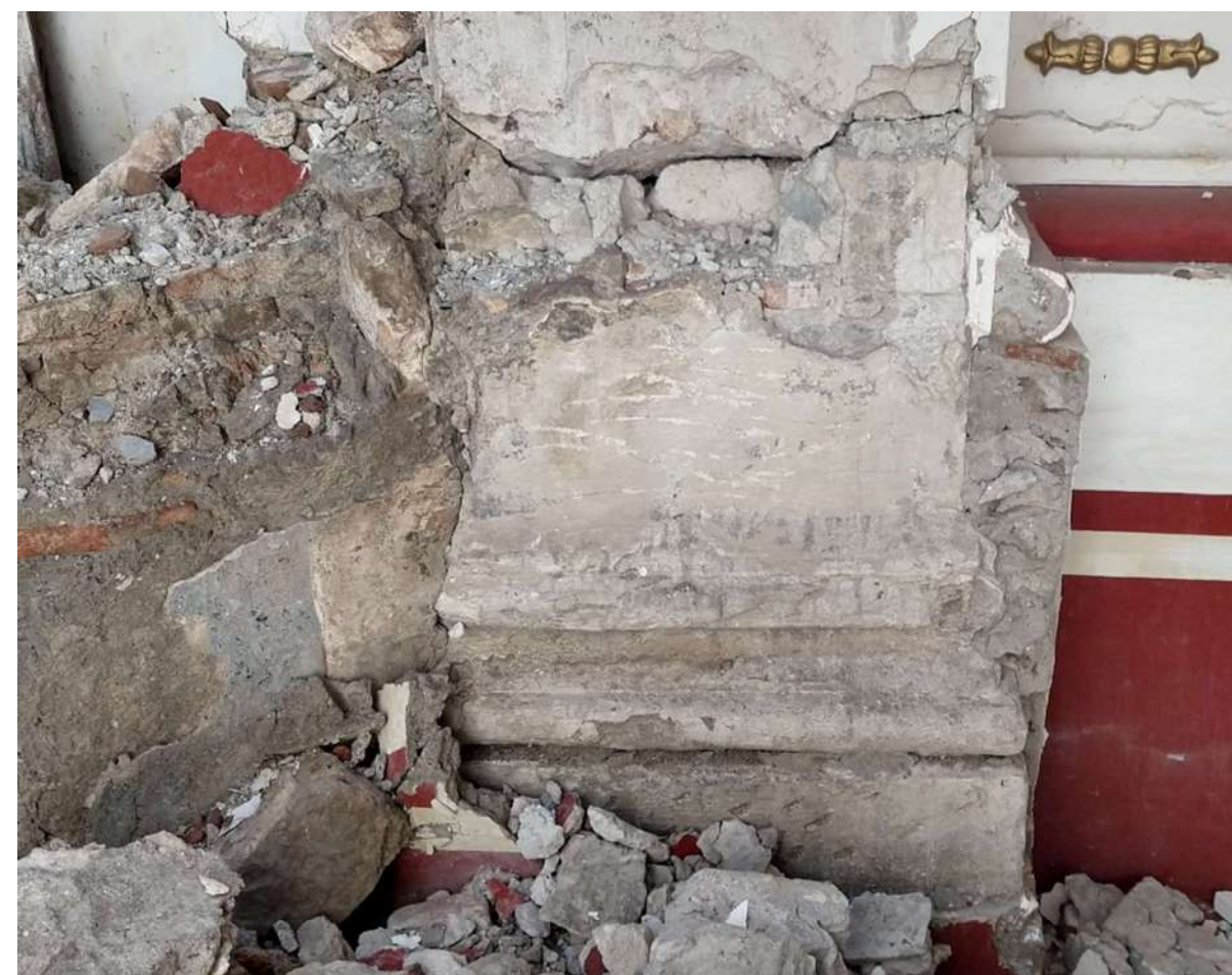
Agrietamiento en sentido horizontal en la parte superior de la basa de la pilastra, pilastra en el Templo de San Agustín Obispo, Tepexco, Puebla. Sánchez Paulino, 2019
