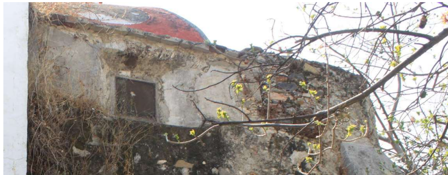
Imagen 1: Detalle del estado actual de parte alta del muro exterior poniente
