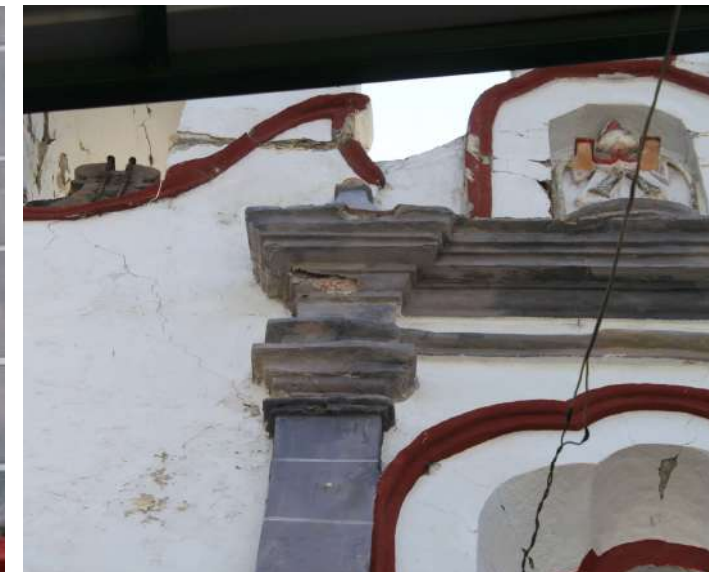
Imagen 3: Detalle de afectaciones en pilastra y muro
