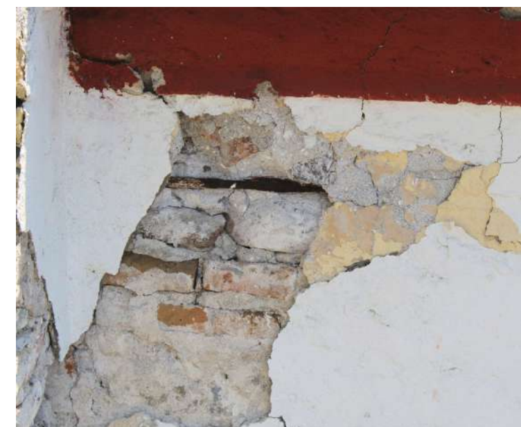
Imagen 3: Desprendimientos que evidencian elementos ocultos en torre campanario
