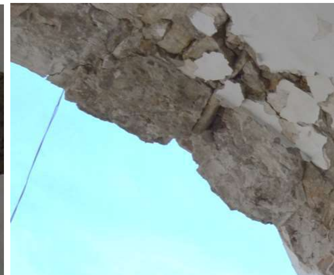
Imagen 3: Detalle del estado actual de arco fajón oriente
