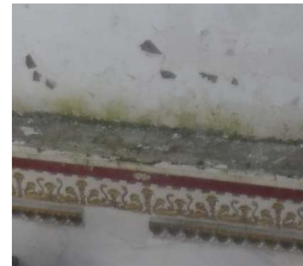
Imagen 3: Detalle de afectaciones en juego de molduras de muro interior sur en Nave tramo 2
