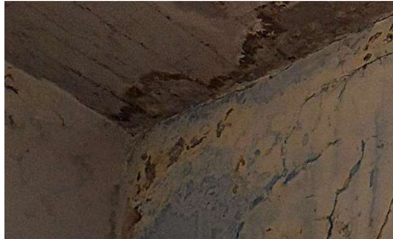
Imagen 2: Detalle de afectaciones en muro interior oriente y unión con cubierta
