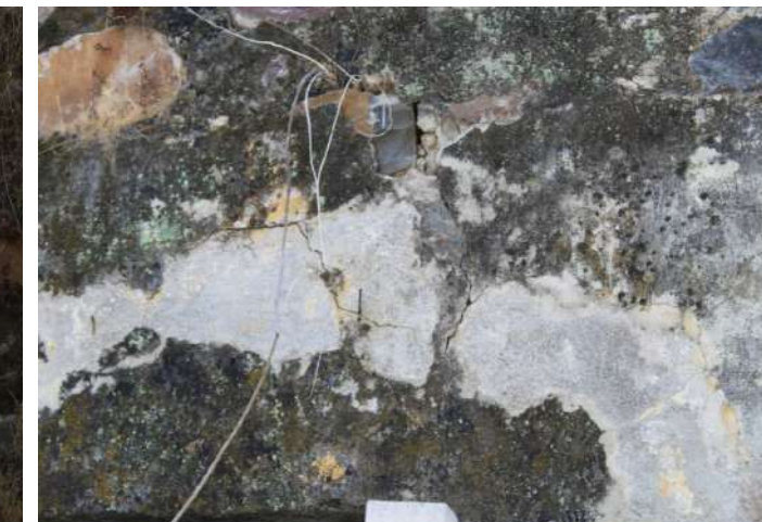
Imagen 4: Detalle de deterioros en muro exterior poniente
