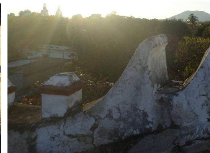
Imagen 2: Detalle de deterioros existentes en imafronte oriente
