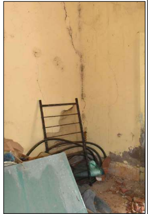
F02. Detalle de afectaciones en muro interior poniente de Bodega 2
