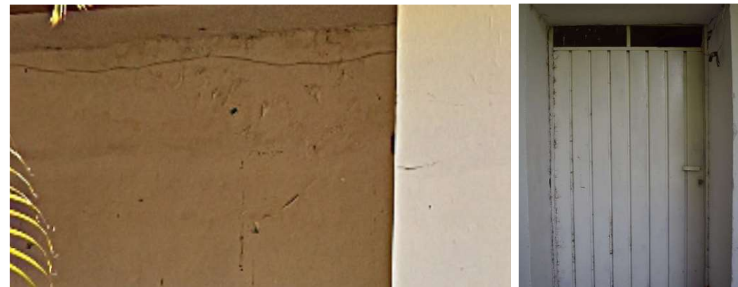
Imagen 2: Detalle de afectaciones en muro exterior norte
