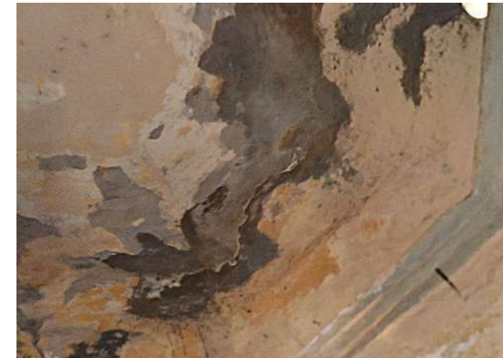
Imagen 2: Vista del desprendimiento de aplanados existentes en intradós de cúpula
