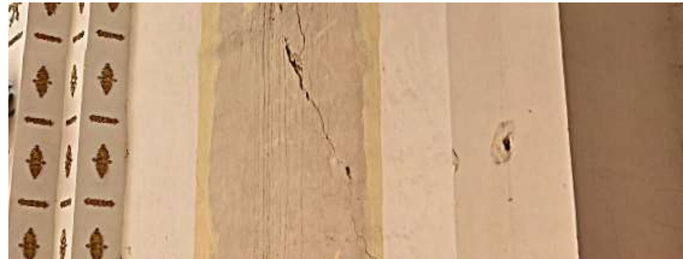
Imagen 1: Detalle de agrietamientos presentes en muro interior sur
