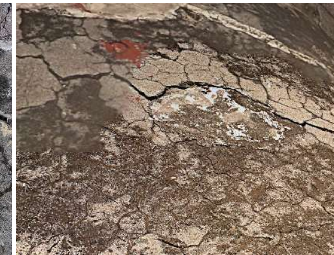
Imagen 4: Vista de agrietamientos en extradós de cubierta de Coro
