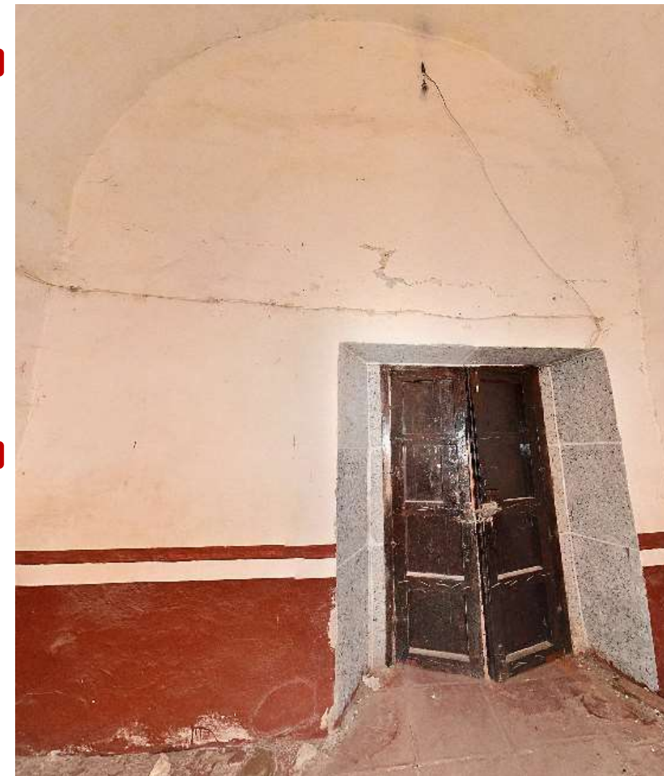
Imagen 1: Vista general de muro interior norte
