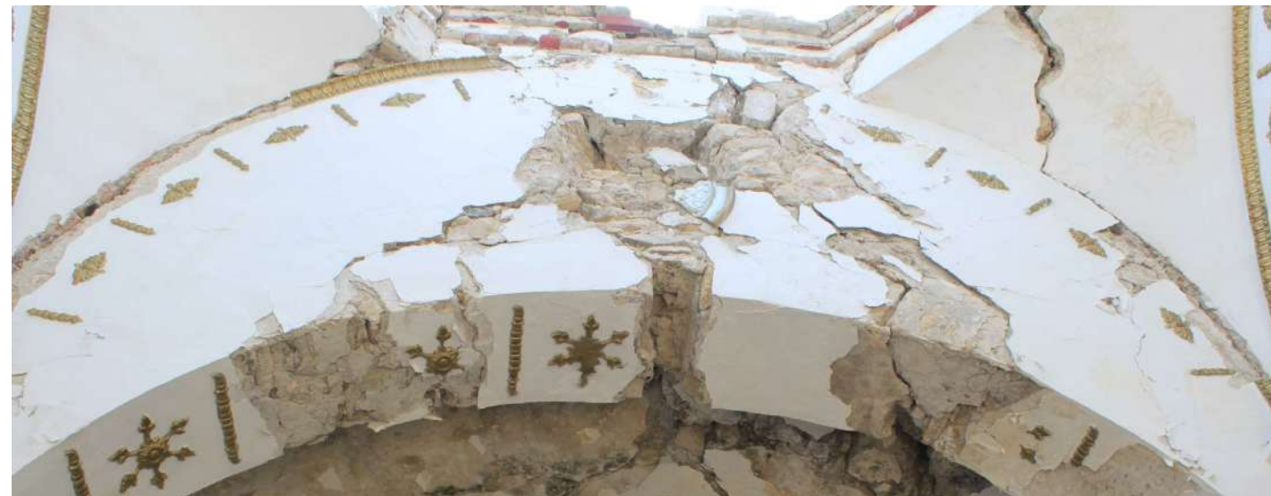
Imagen 1: Vista general del estado actual de muro interior oriente en Nave tramo 2
