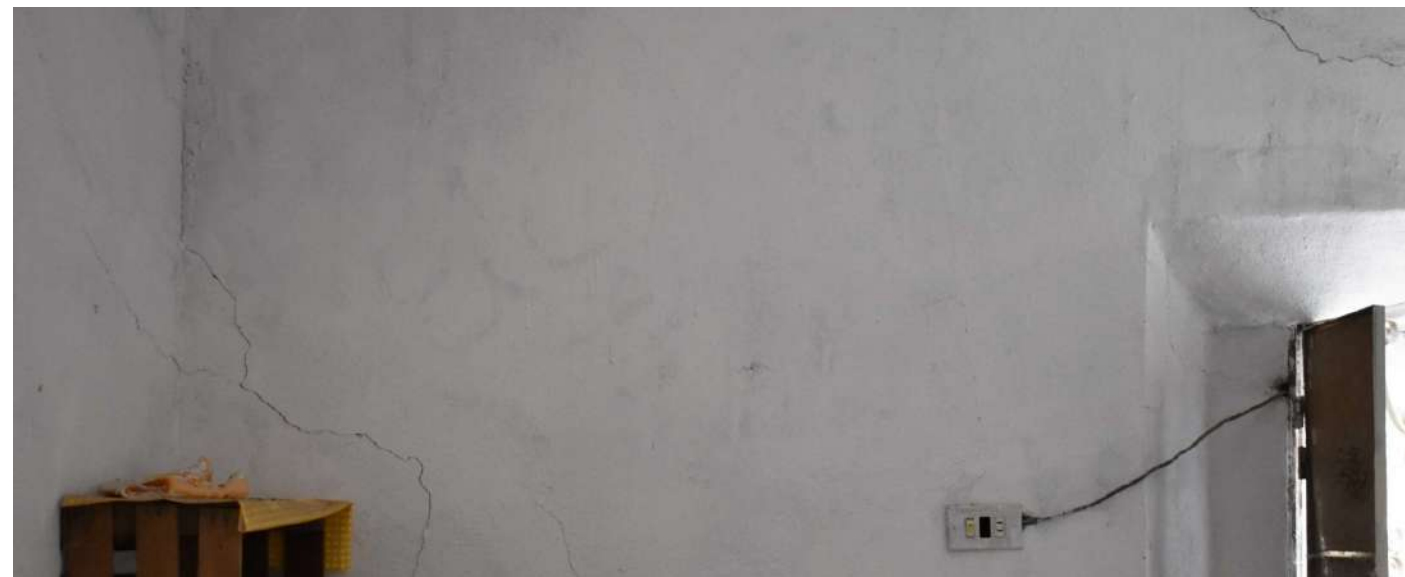
Imagen 2: Fisuras y agrietamientos en muro interior norte
