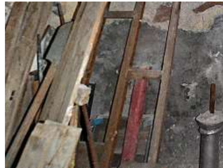
Imagen 1: Afectaciones en parte baja de muro interior sur
