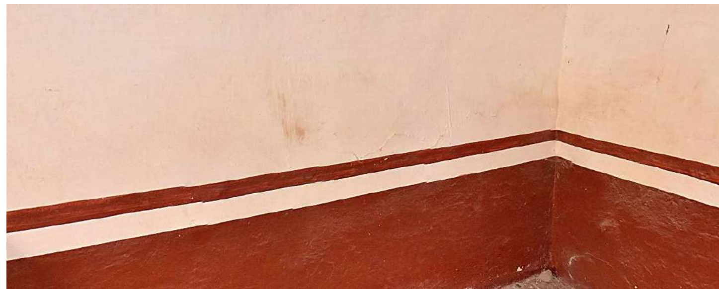
Imagen 2: Detalle de afectaciones en muro interior poniente
