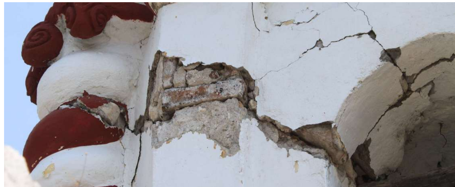
Imagen 1: Detalle de agrietamientos perimetrales en segundo cuerpo de torre, fachada sur
