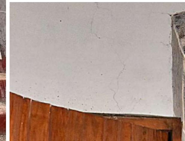
Imagen 3: Detalle de fisuras en muro interior sur
