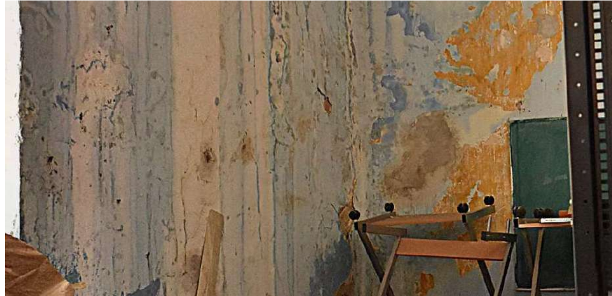
Imagen 2: Humedades principales daños en muro interior sur
