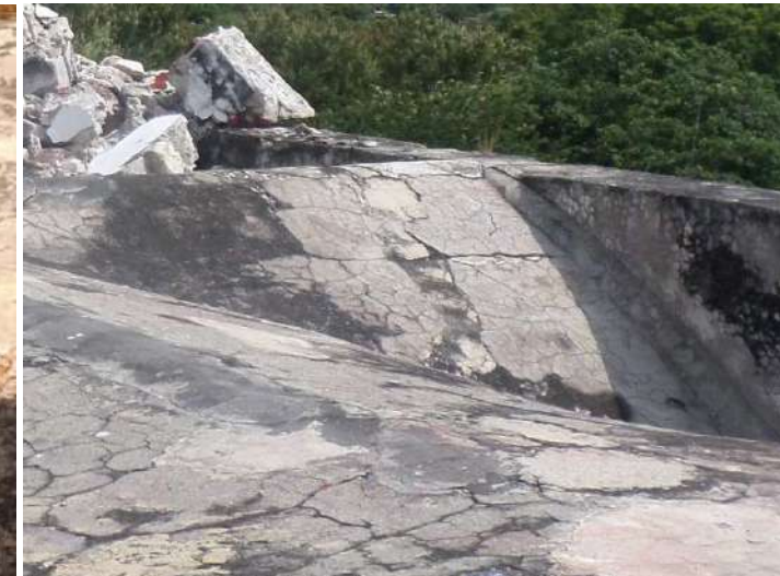
Imagen 3: Detalle de afectaciones presentes en extradós de cubierta
