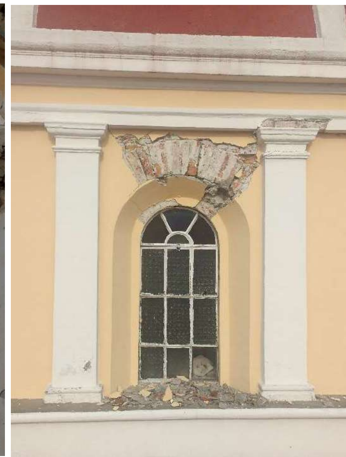
Cúpula con agrietamientos horizontales en tambor Templo del Calvario, Izúcar de Matamoros, Puebla. Sánchez Paulino, 2017.
