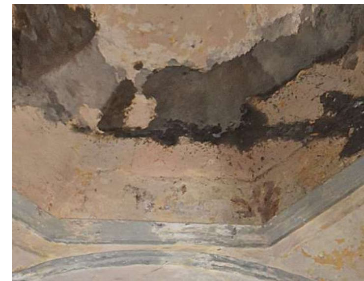
Imagen 2: Vista del estado actual de tambor interior oriente
