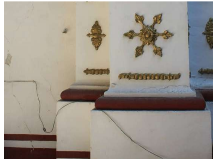
Imagen 3: Detalle de deterioros en basa de pilastra nororiente
