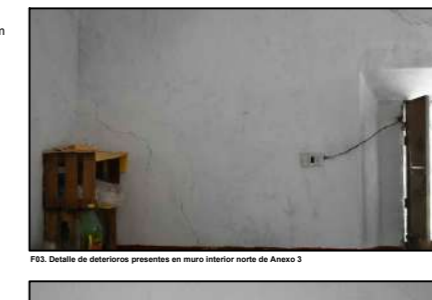
F03. Detalle de deterioros presentes en muro interior norte de Anexo 3
