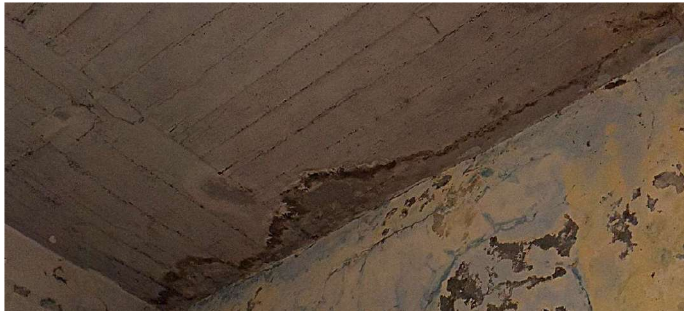
Imagen 1: Detalle de deterioros en intradós de cubierta
