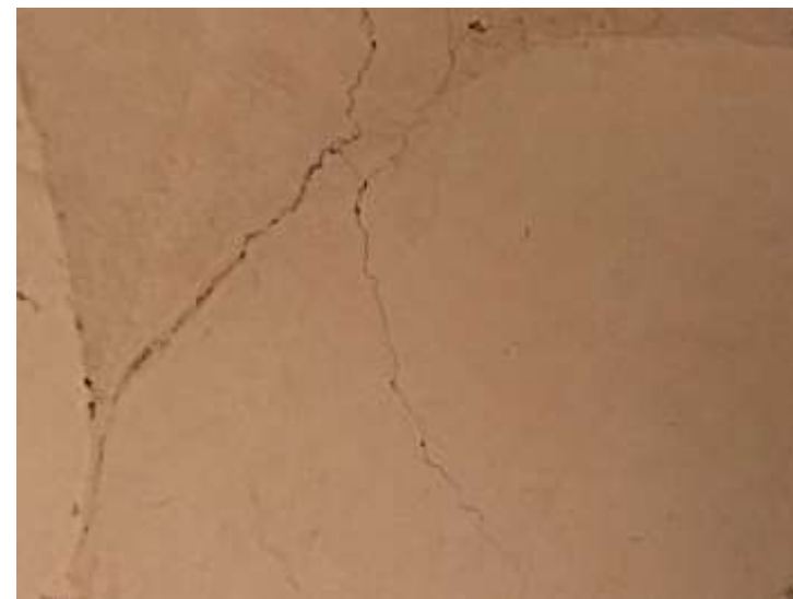
Imagen 2: Detalle de afectaciones en muro interior norte
