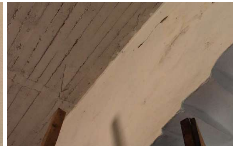
Imagen 2: Vista de deterioros en unión de cubierta y muro interior poniente
