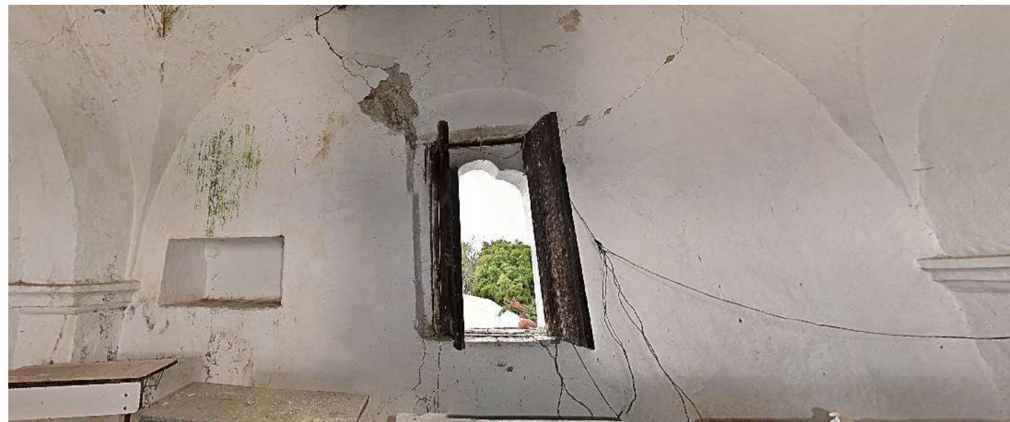
Imagen 1: Vista general de afectaciones presentes en muro interior poniente de Coro
