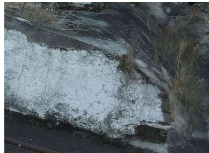
Imagen 2: Detalle de deterioros presentes
