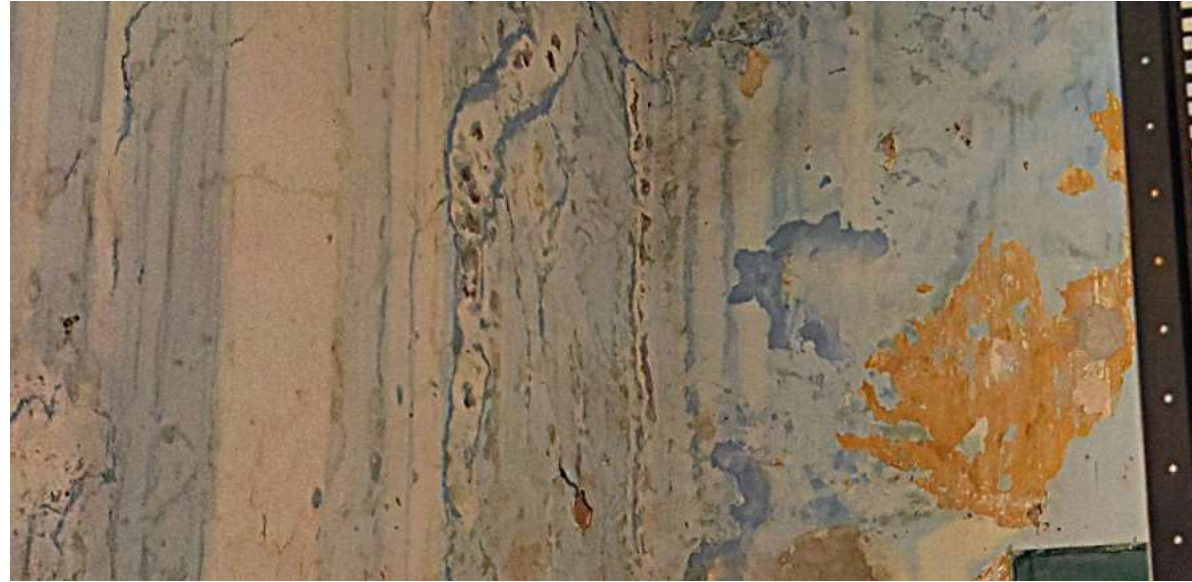
Imagen 1: Vista general de las afectaciones presentes en parte alta de muro interior sur
