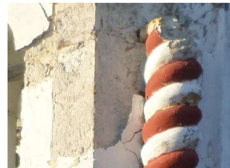
Imagen 3: Desprendimiento de aplanados y colapsos parciales en torre campanario fachada sur
