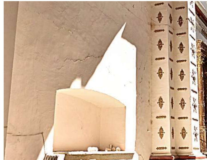
Imagen 1: Vista general de afectaciones presentes en muro interior norte
