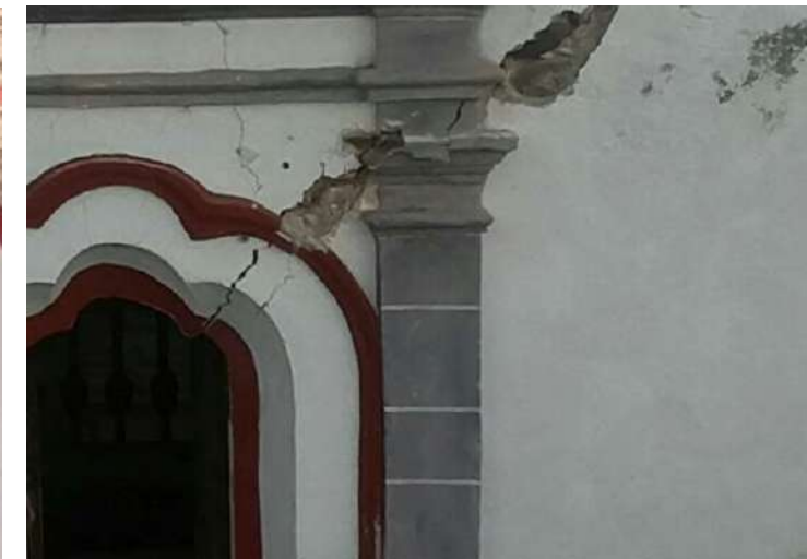
Imagen 4: Detalle de agrietamientos y desprendimientos afectando ventana coral
