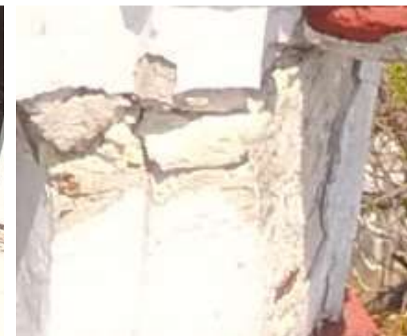
Imagen 3: Detalle de los agrietamientos perimetrales en segundo cuerpo de torre, fachada oriente
