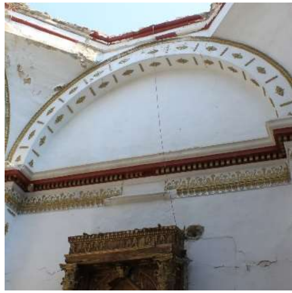
Imagen 2: Arco formero de Tramo 2
