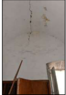
F03. Vista de agrietamientos en intradós de bóveda de bóveda de presbiterio
