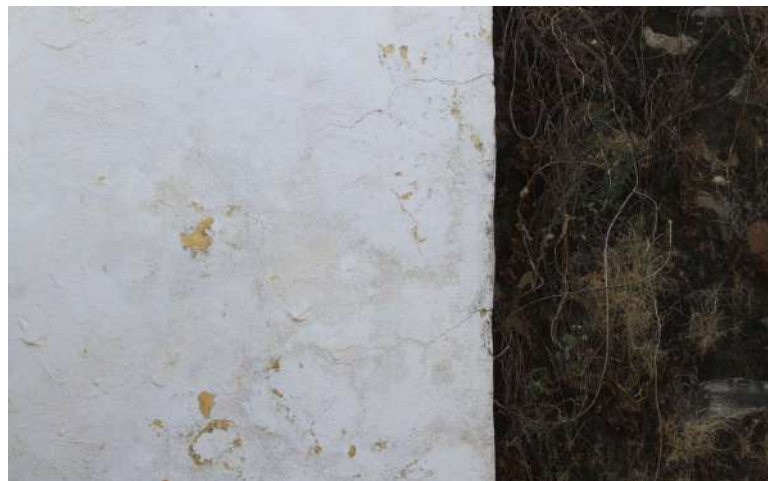
Imagen 3: Detalle de vegetación parásita presente en muro exterior poniente
