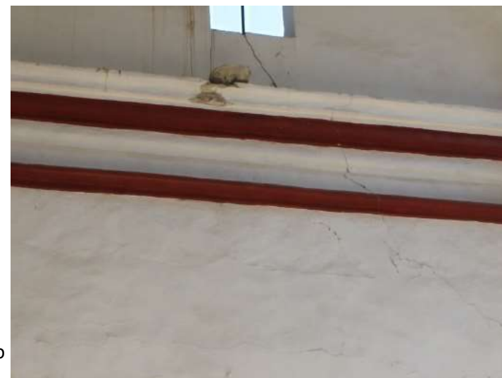
Imagen 2: Detalle de deterioros presentes en cornisamento en muro interior norte
