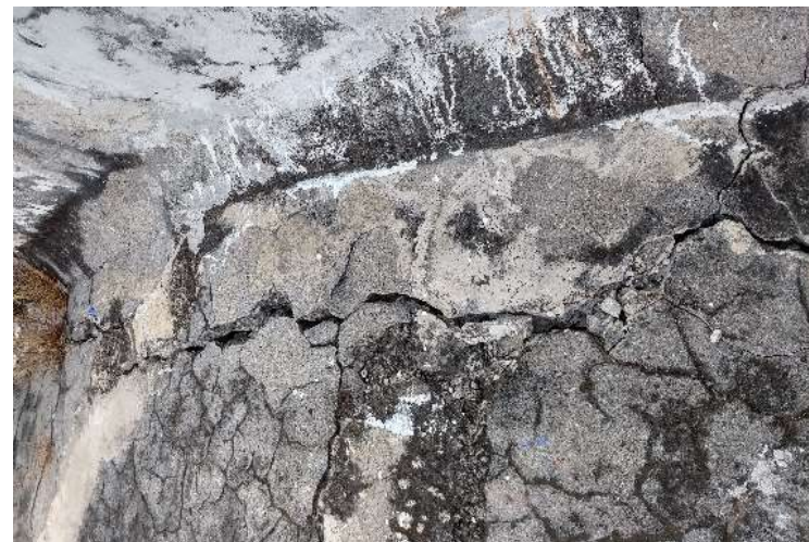
Imagen 3: Detalle de fracturas existentes en extradós de cubierta de Coro
