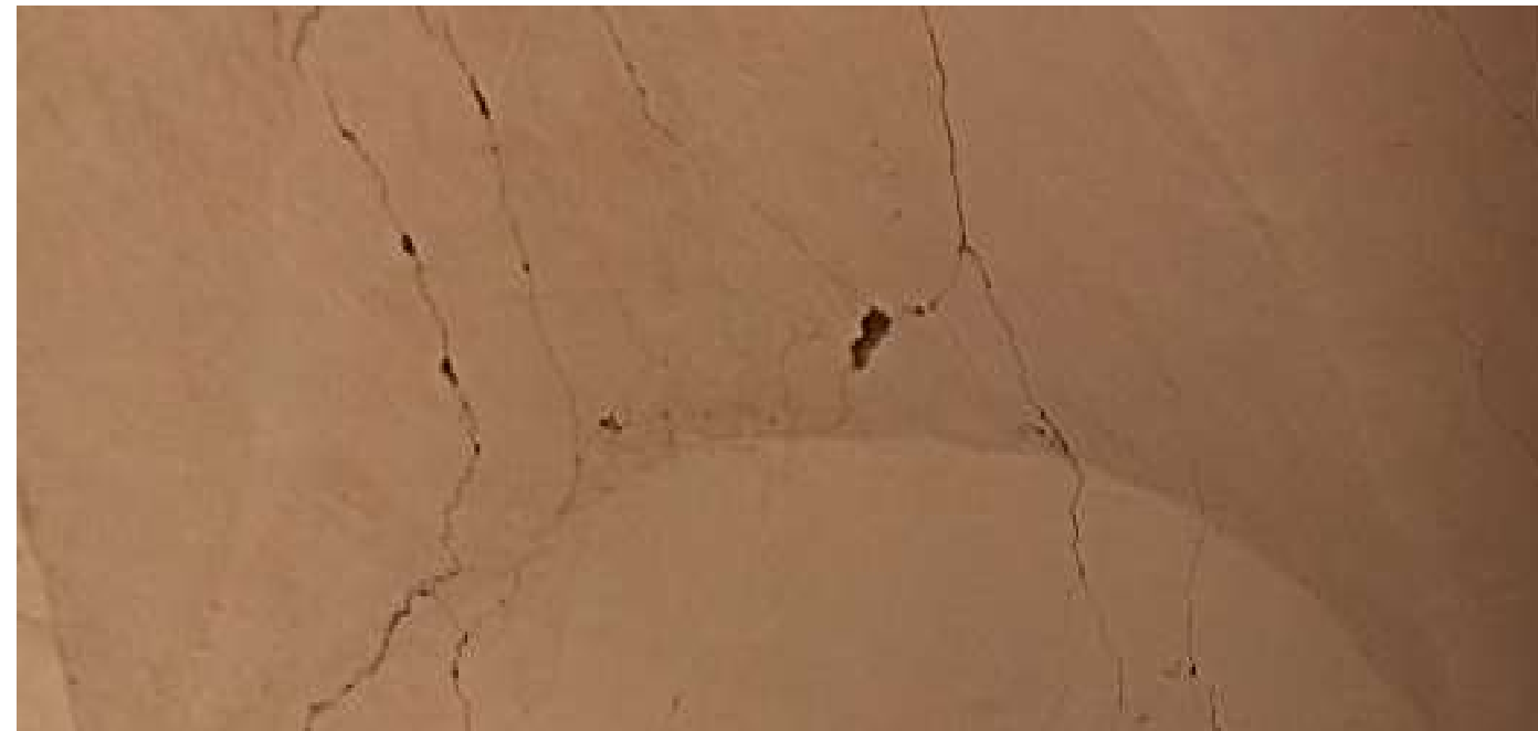
Imagen 1: Vista general de afectaciones en muro interior norte
