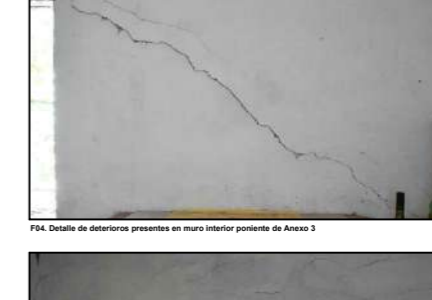
F04. Detalle de deterioros presentes en muro interior poniente de Anexo 3
