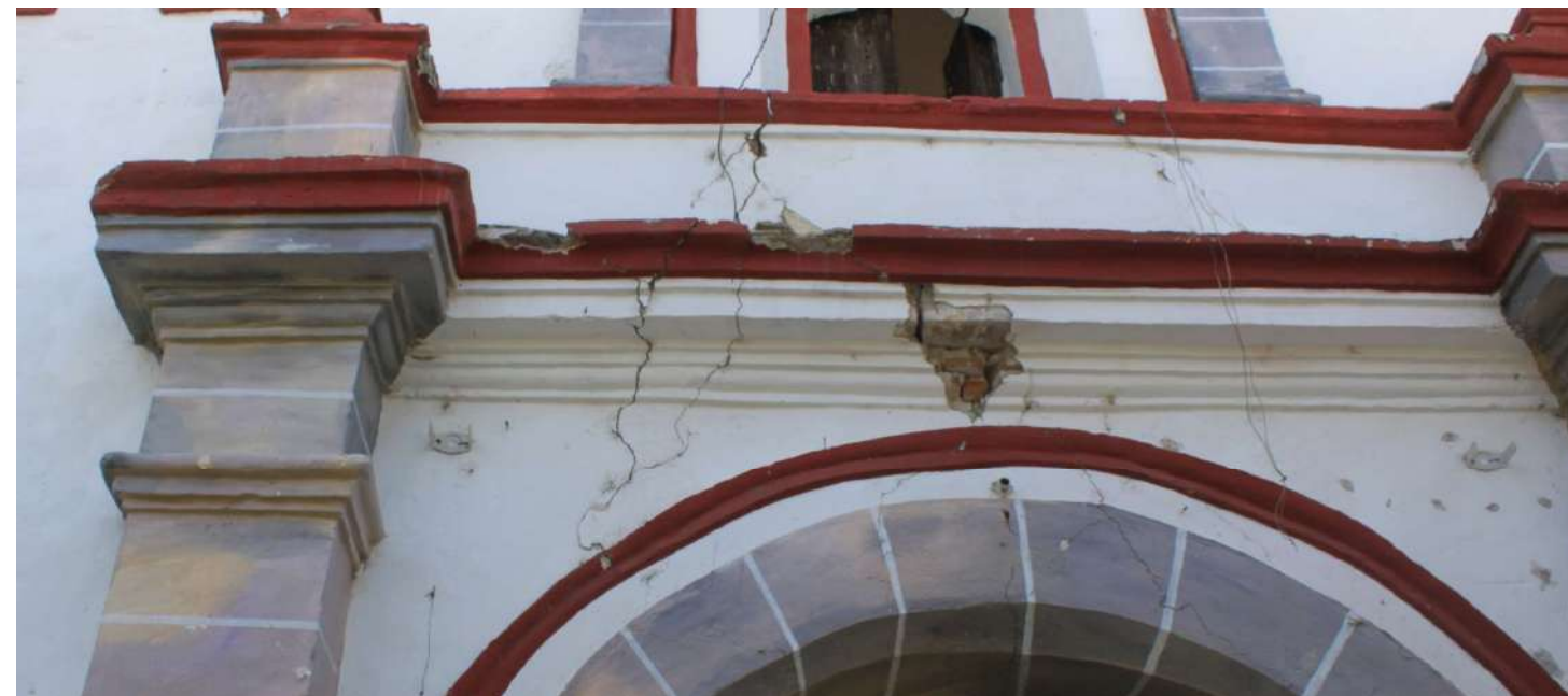
Imagen 1: Vista general de afectaciones en parte alta del primer cuerpo de fachada poniente
