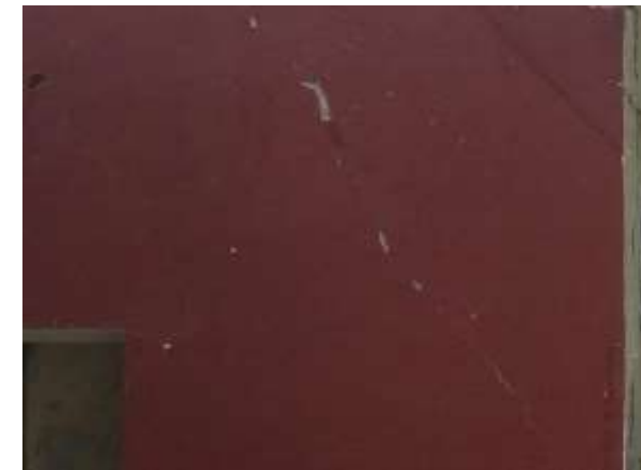
Imagen 3: Fracturas en muro exterior norte
