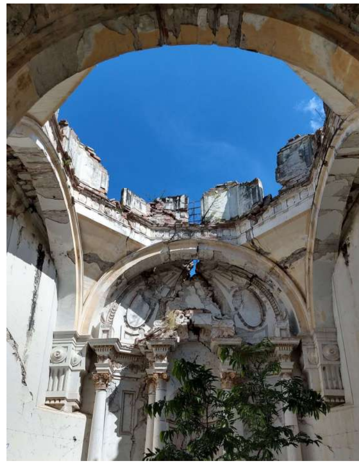
Ausencia de cúpula tras colapso Ex hacienda de San Juan Raboso, Izúcar de Matamoros, Puebla. Sánchez Paulino, 2017.
