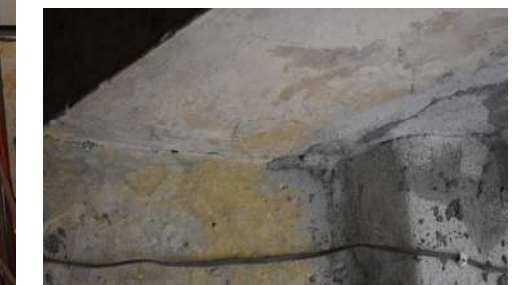
Imagen 4: Detalle de las condiciones que presenta el derrame vertical interior poniente de ventana
