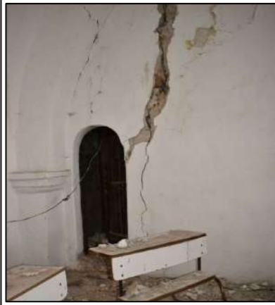
F01. Afectaciones en muro interior norte de Coro
