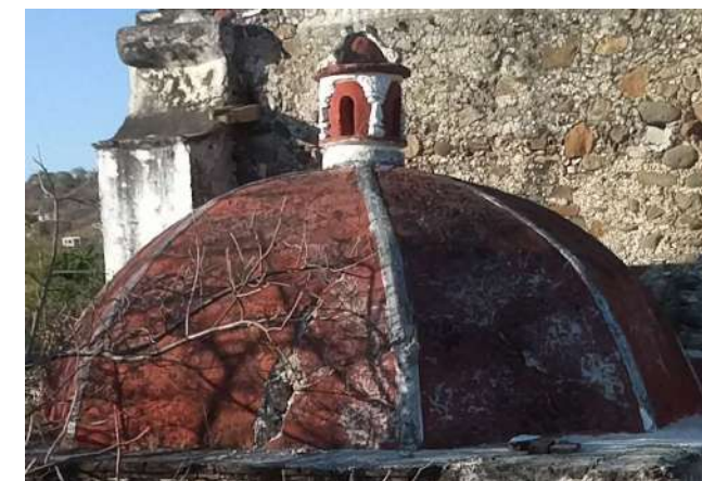
Imagen 3: Detalle de fractura en extradós de cúpula vista sur
