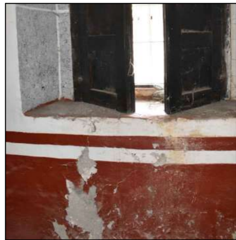
F02. Detalle de afectaciones presentes en muro interior oriente de Sacristía
