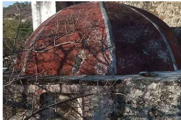
Imagen 1: Fracturas y agrietamientos en cúpula vista exterior sur
