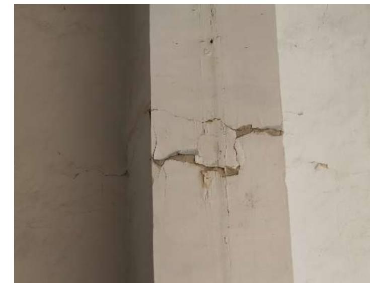
Imagen 3: Detalle de afectación presente en fuste de pilastra nororiente
