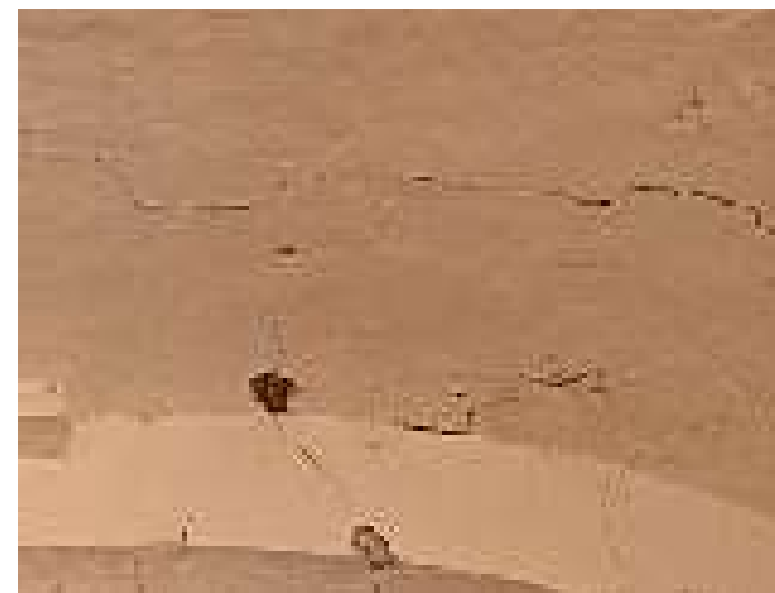
Imagen 2: Detalle de afectaciones presentes en intradós de cubierta
