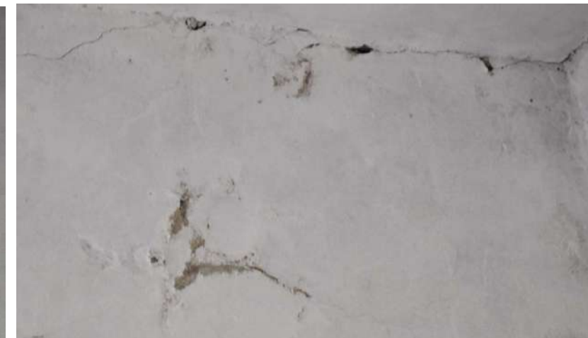
Imagen 3: Detalle de afectaciones presentes en muro interior oriente
