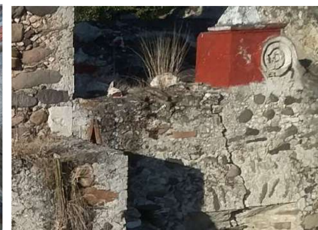
Imagen 2: Detalle de afectaciones presentes en pretil de cubierta
