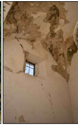
F04. Detalle de afectaciones en Presbiterio interior norte
