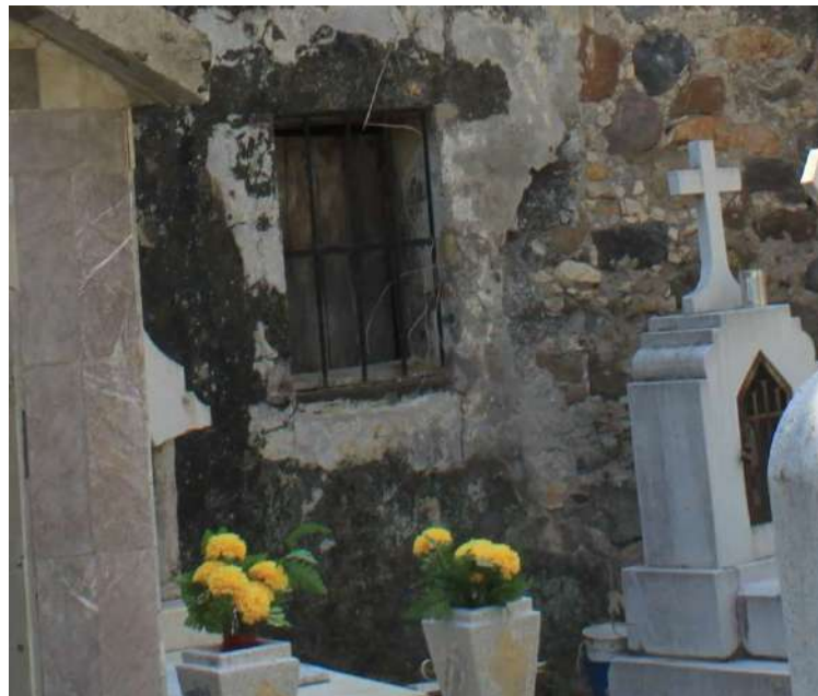
Imagen 1: Detalle de daños en muro exterior poniente
