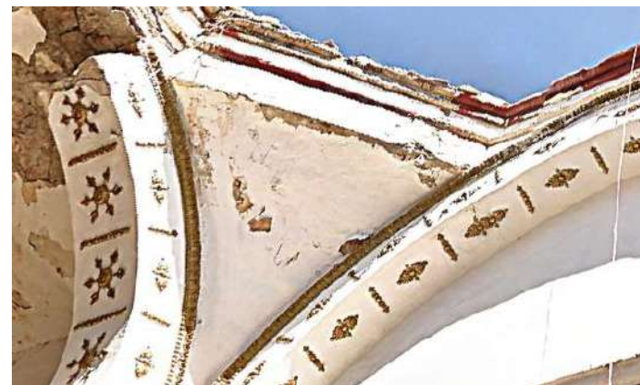
Imagen 2: Detalle de afectaciones presentes en nicho norponiente en Nave tramo 2
