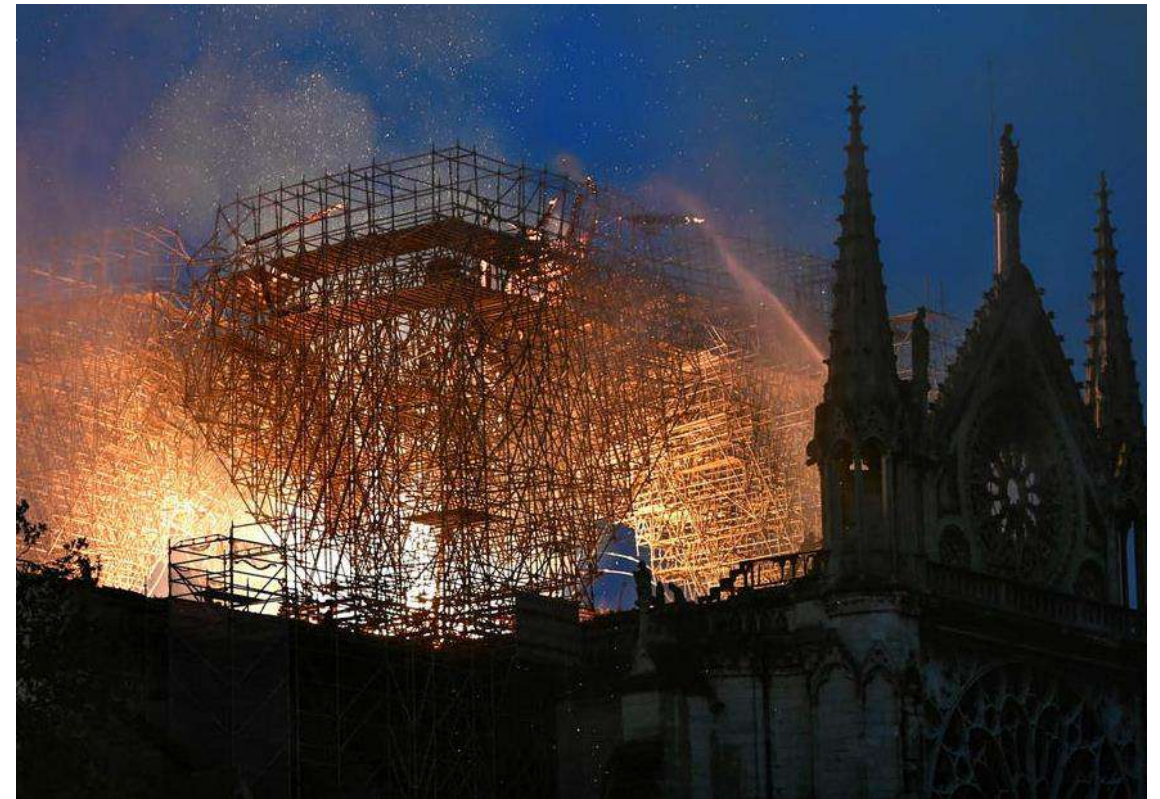
Imagen. 1. Un incendio suscitado mientras se realizaban labores de mantenimiento afectó gravemente la Catedral de Notre Dame en París en el 2019 Fuente: https://www.lanacion.com.ar/el-mundo/en-fotos-notre-dame-mas-ano-del-nid2375663
