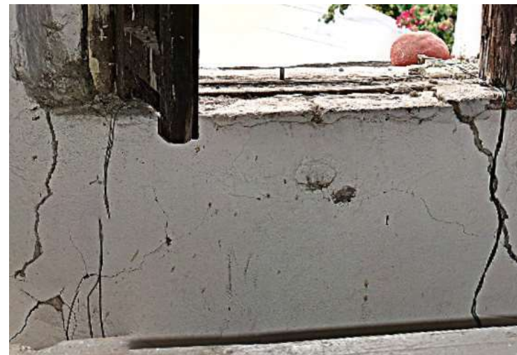
Imagen 2: Detalle de afectaciones en parte baja de muro interior poniente de Coro
