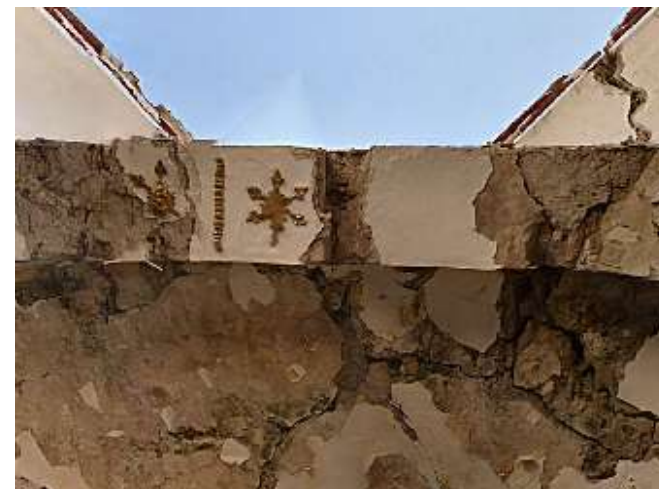
Imagen 2: Detalle de afectaciones en intradós de arco Oriente
