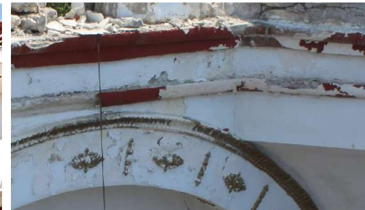
Imagen 3: Detalle de afectaciones en molduras superiores de muro interior norte en Nave tramo 2
