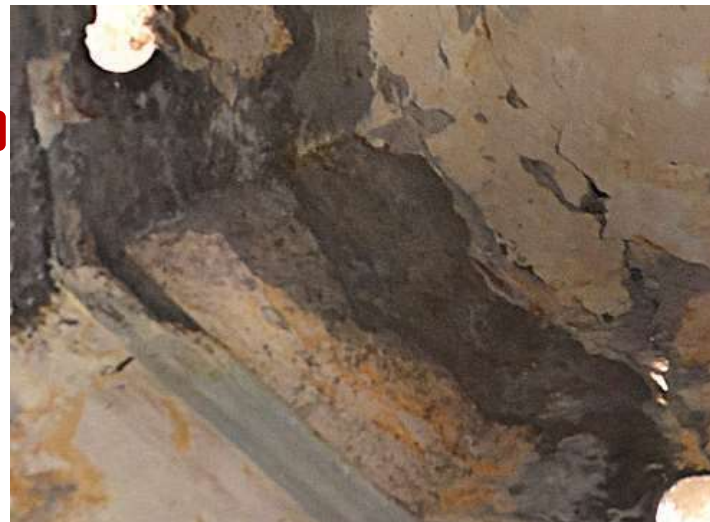
Imagen 1: Detalle de afectaciones en intradós de cúpula
