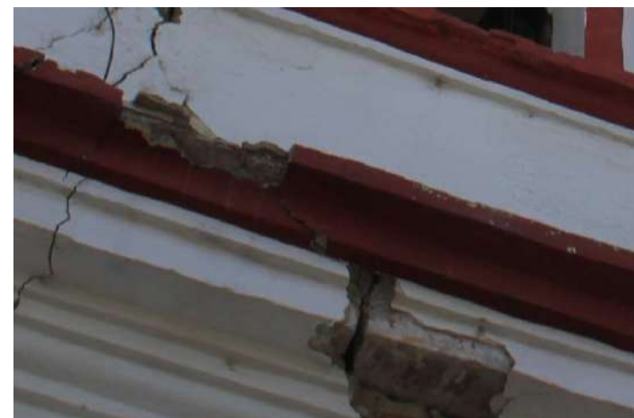
Imagen 2: Detalle de agrietamientos y daños en cornisas
