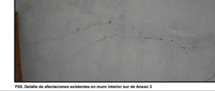
F05. Detalle de afectaciones existentes en muro interior sur de Anexo 3
