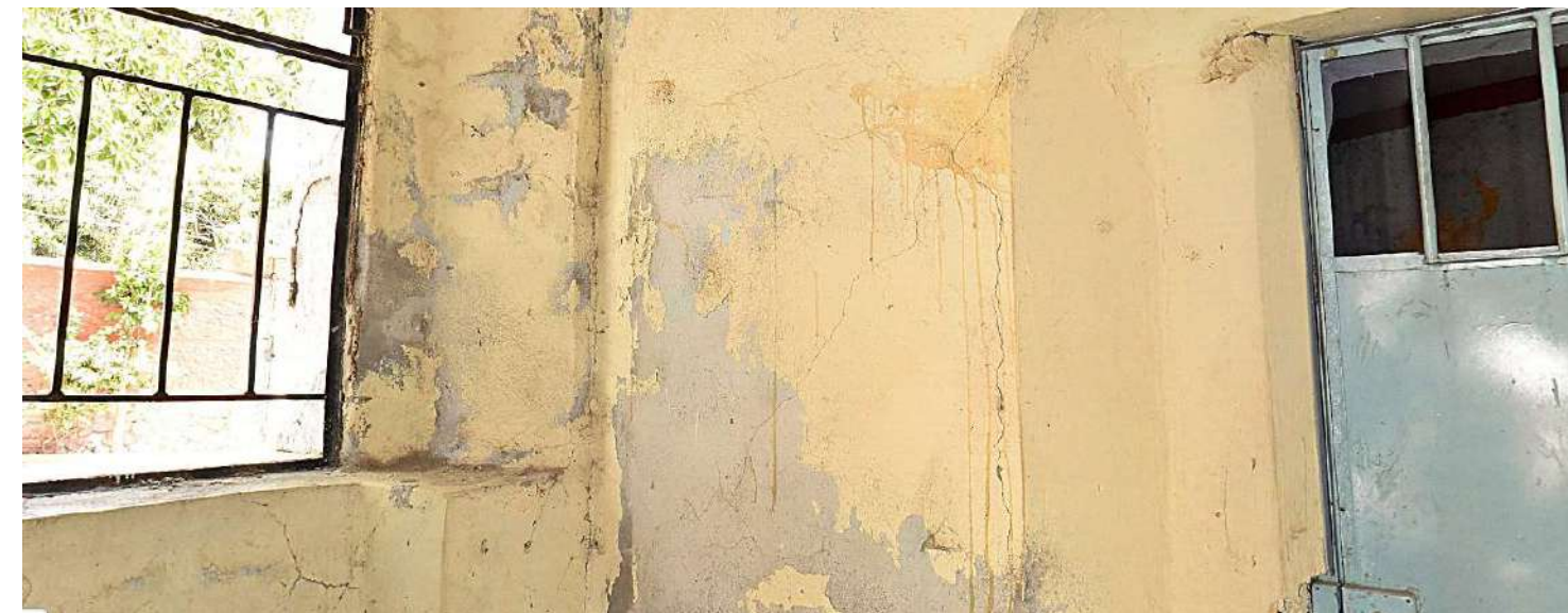
Imagen 2: Estado actual de muro interior sur
