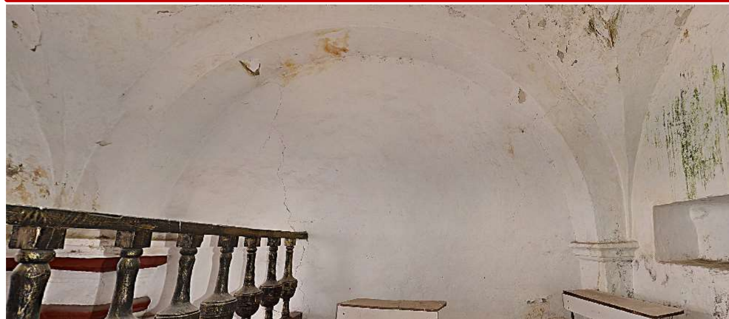
Imagen 1: Vista general de afectaciones presentes en muro interior sur de Coro
