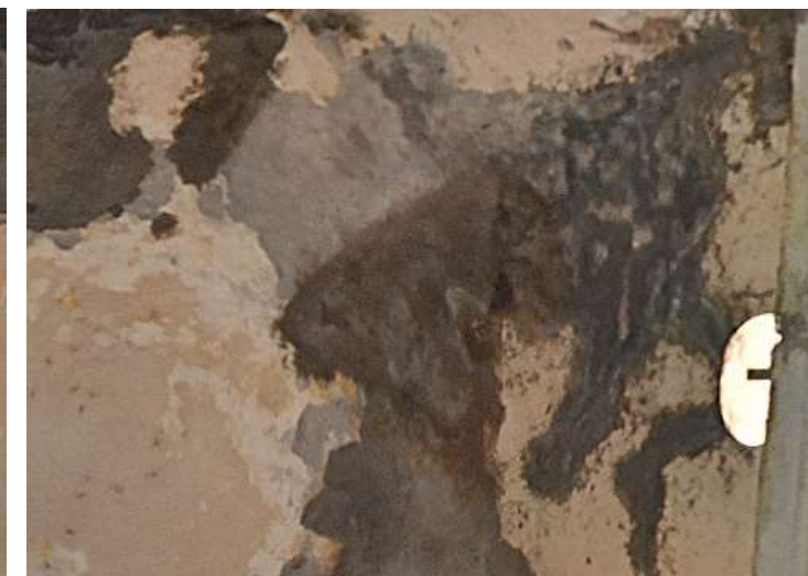
Imagen 4: Detalle de deterioros en intradós de cúpula
