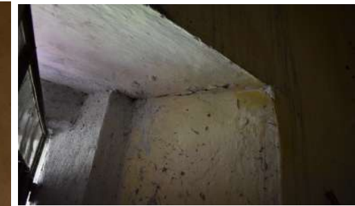
Imagen 2: Detalle del estado actual en derrame interior vertical de puerta
