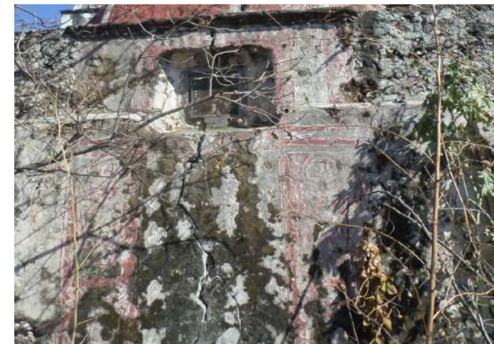
Imagen 2: Vista de los agrietamientos y humedades en muro exterior sur
