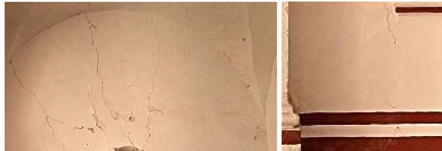
Imagen 2: Detalle de afectaciones en muro interior sur
