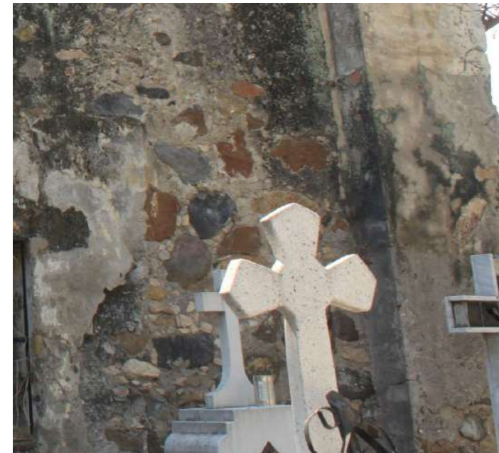
Imagen 2: Detalle de daños en muro exterior poniente
