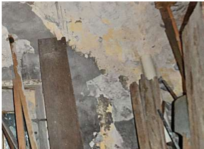
Imagen 3: Detalle de afectaciones presentes en parte baja de muro interior oriente
