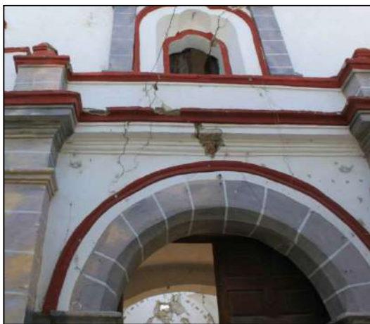
F01. Detalle de afectaciones en portada de acceso principal
