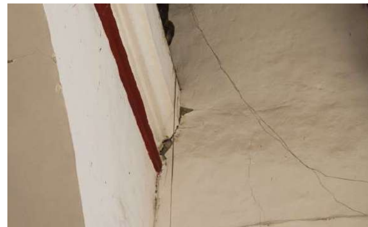
Imagen 2: Detalle de afectación en unión de muro interior norte
