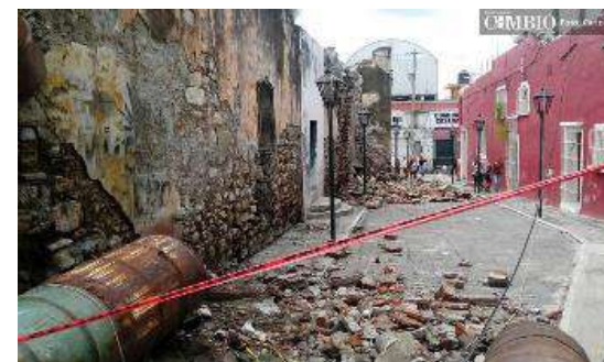
Imagen 6. Daños del Sismo de México (2017) Fuente: https://www.diariocambio.com.mx/2017/media
