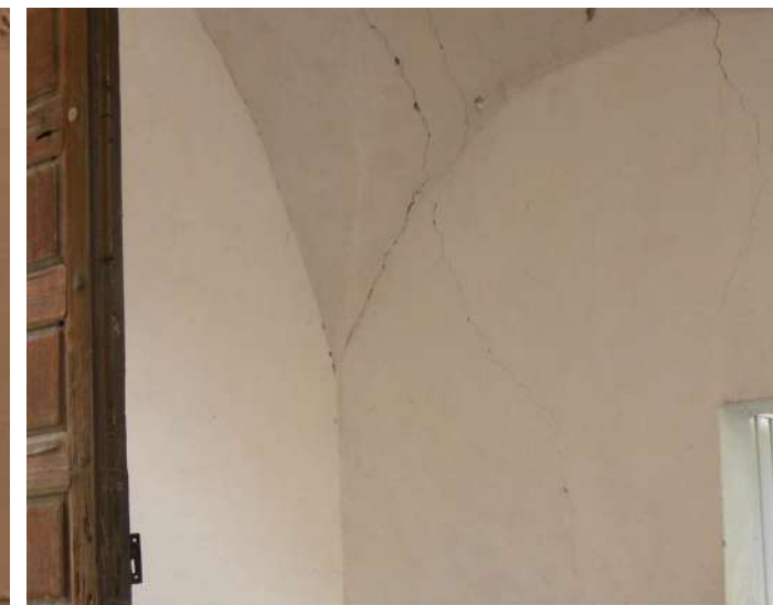
Imagen 3: Detalle de afectaciones en parte alta de muro interior norte
