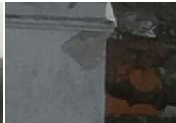
Imagen 2: Detalle de deterioro presente en fachada norte
