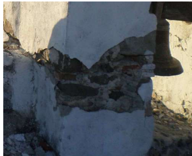
Imagen 1: Detalle de deterioro en base de espadaña, fachada oriente
