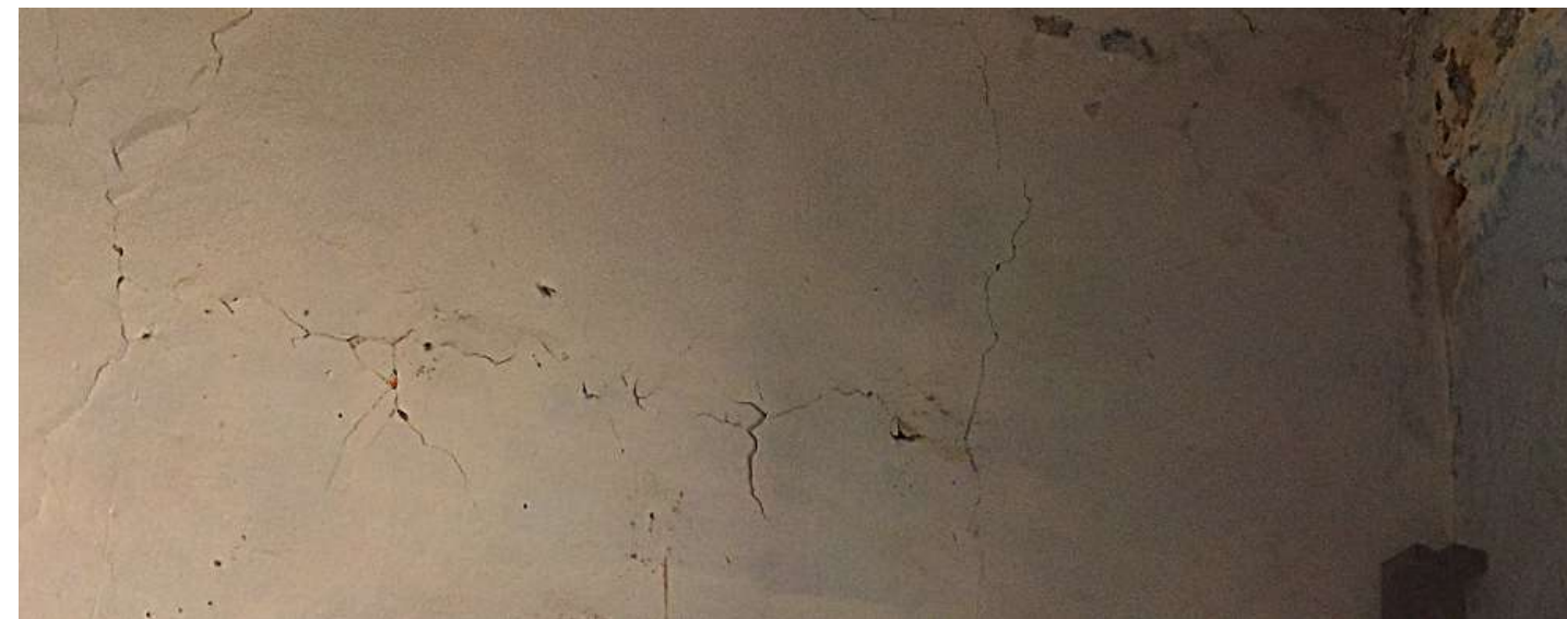
Imagen 1: Detalle de afectaciones presentes en muro interior norte
