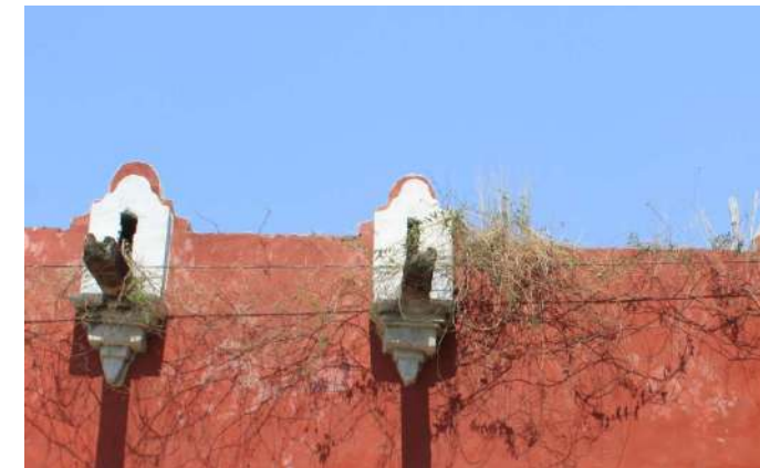
Imagen 3: Vegetación parásita y fisuras principales deterioros
