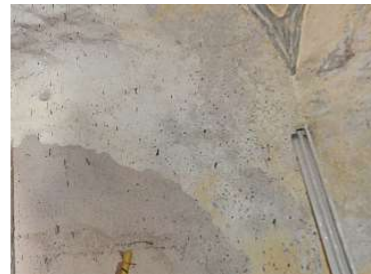
Imagen 4: Humedades existentes en muro interior norte
