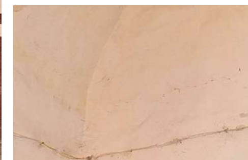
Imagen 4: Detalle de afectaciones en parte alta de muro interior norte
