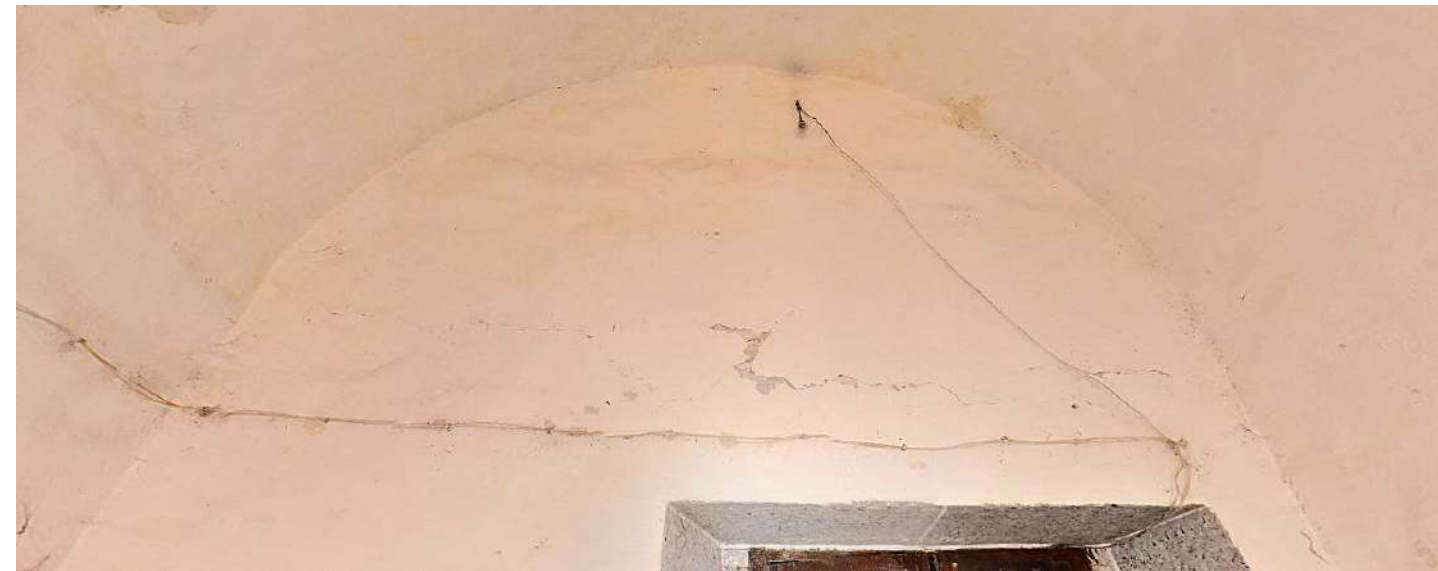
Imagen 1: Vista general de afectaciones en parte alta de muro interior norte
