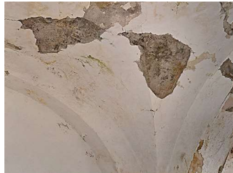
Imagen 3: Vista de intradós de parte nororiente de bóveda de Coro
