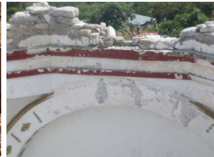
Imagen 4: Detalle de afectaciones presentes en muro interior sur de Nave tramo 2
