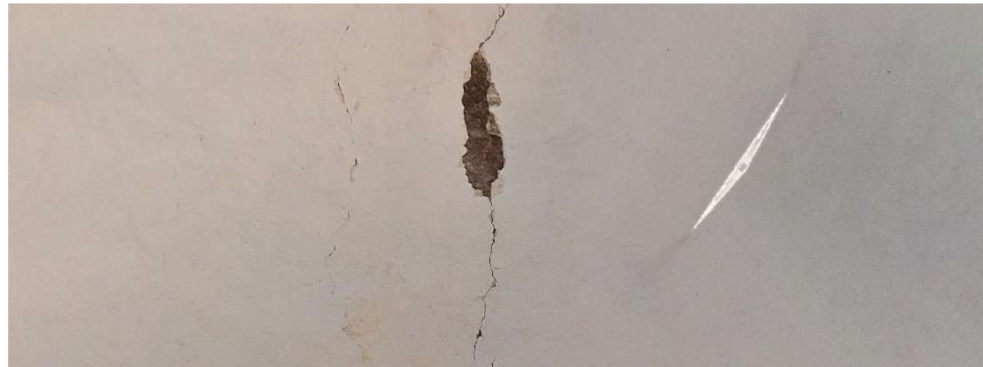
Imagen 2: Detalle de agrietamientos y desprendimientos en intradós de bóveda
