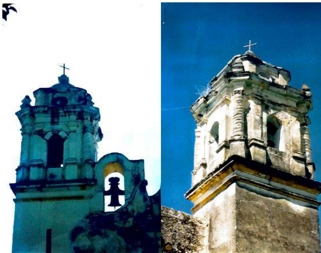
Imagen 7. Reporte fotográfico de los daños existentes en torre campanario tras el sismo del 15 de junio de 1999
