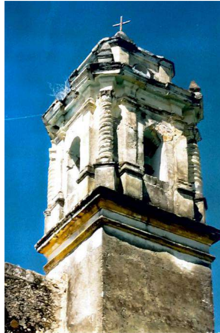
Imagen 1: Daños en segundo cuerpo de torre campanario lado nororiente, producto del sismo del 15 de junio de del año 1999
