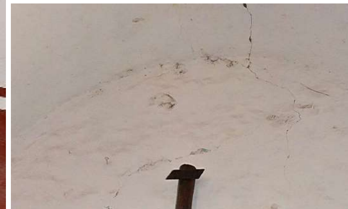
Imagen 3: Vista de deterioros existentes en parte alta de muro interior norte
