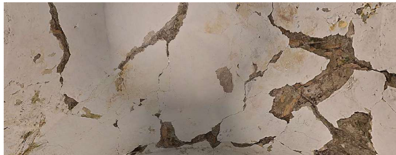
Imagen 1: Vista general de afectaciones existentes en intradós de bóveda de Coro parte poniente
