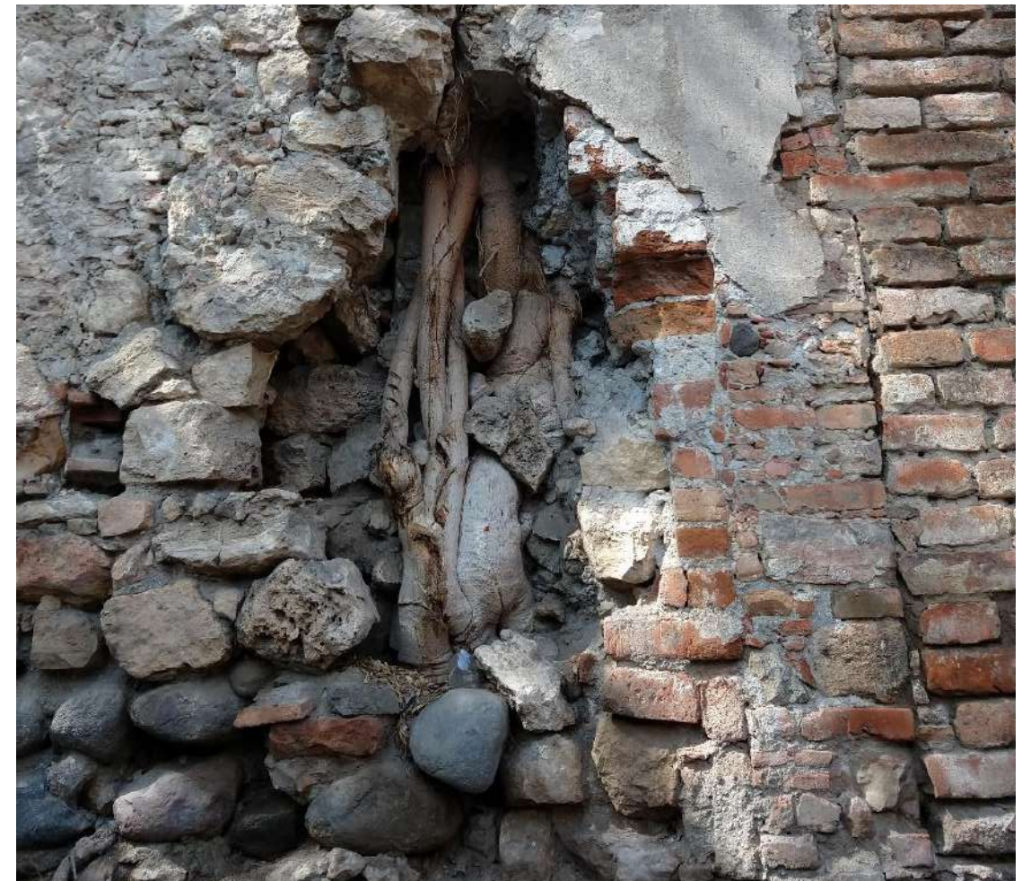
Imagen. 3. La falta de mantenimiento puede propiciar que agentes invasivos proliferen al grado de afectar de manera grave la construcción, en la imagen las raíces de un árbol que crece desde el interior del muro provoca roturas y desprendimiento en el mismo.
