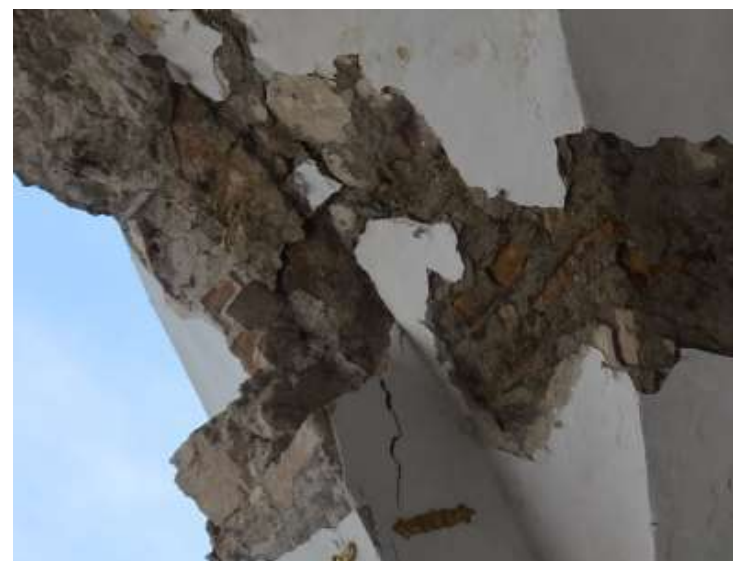
Imagen 2: Detalle de afectaciones en arco fajón e intradós de cubierta
