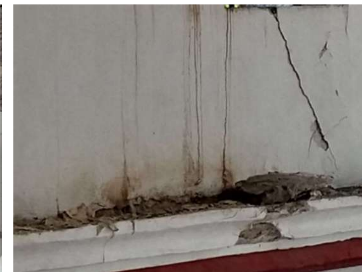
Imagen 3: Detalle de afectaciones presentes en cornisamento en muro interior norte
