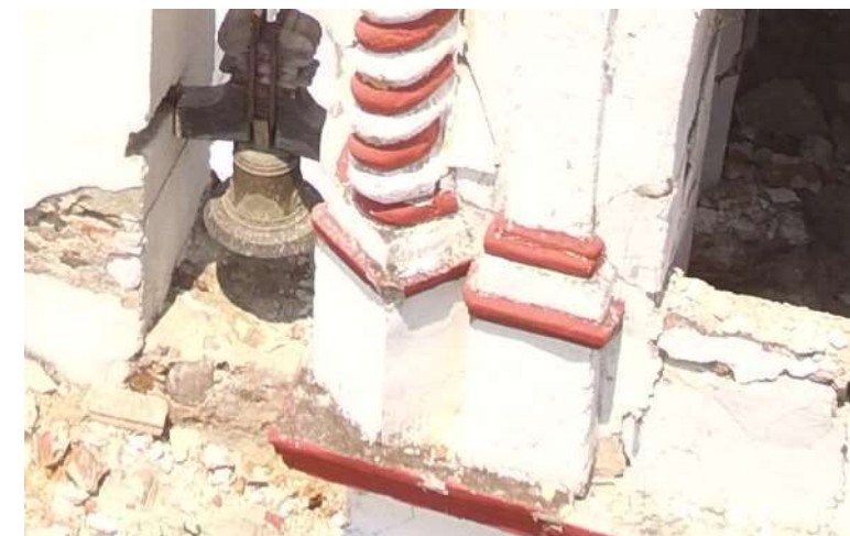
Imagen 2: Detalle de afectaciones presentes en parte baja de segundo cuerpo de torre fachada oriente
