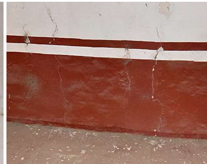
Imagen 2: Detalle de afectaciones en parte baja de muro interior norte
