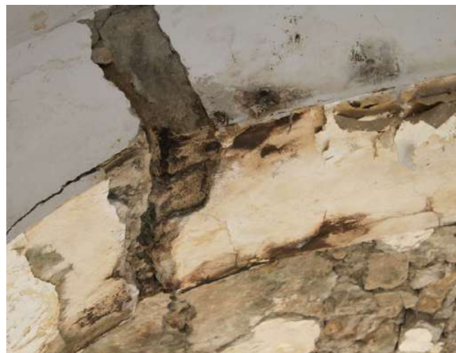
Imagen 1: Detalle de daño existente en arco fajón de Coro parte nororiente
