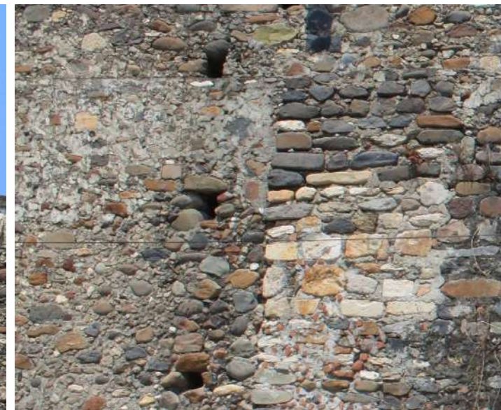
Imagen 2: Detalle del estado actual de muro exterior oriente
