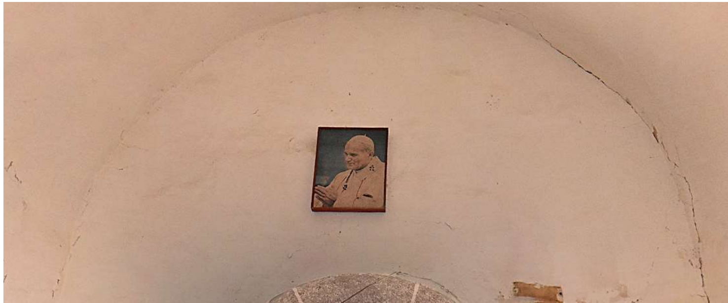
Imagen 1: Vista del estado actual en parte alta de muro interior sur
