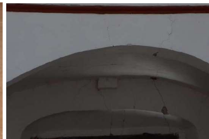
Imagen 3: Detalle de afectaciones en intradós de cubierta y muro adyacente parte poniente
