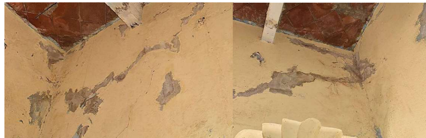
Imagen 2: Detalle de afectaciones en parte alta de muro interior oriente
