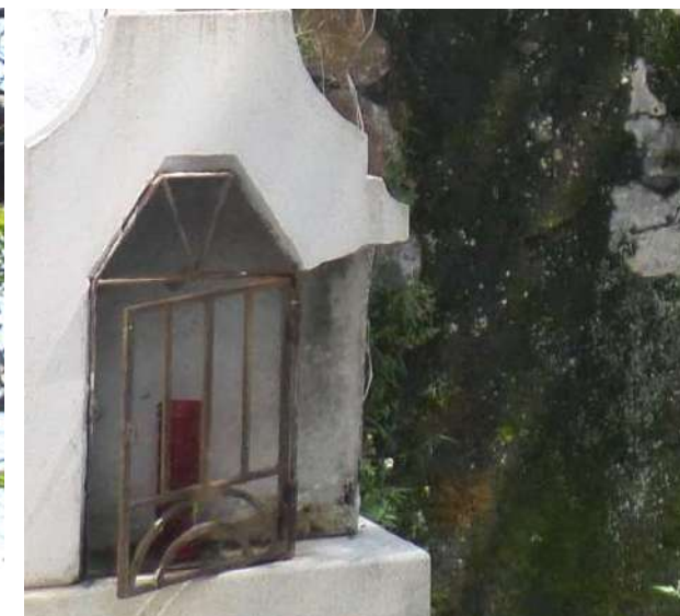
Imagen 3: Detalle de humedades en parte baja de muro exterior poniente
