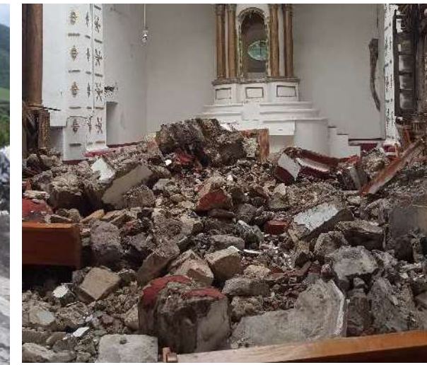
Imagen 4: Escombros resultado del colapso de cúpula depositado al interior del templo
