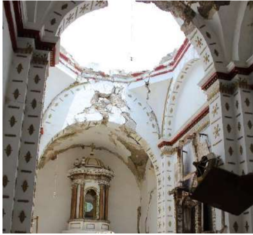
Imagen 15. Vista general de los daños en el interior de la nave del templo de San Agustín Obispo Fuente: Sánchez Paulino
