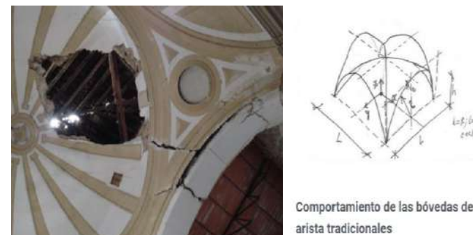
Imagen 19. Vista de la Cúpula dañada. Fuente: https://e-struc.com/2015/03/18/la-reparacion-de-una-cupula-de-fabrica/
