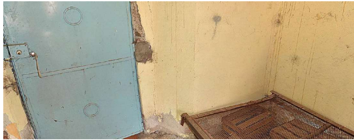
Imagen 1: Estado actual de parte baja de muro interior sur
