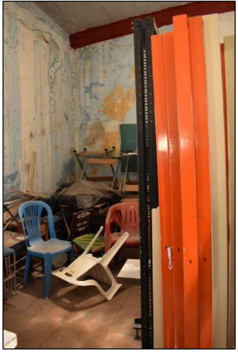
F02. Vista de deterioros existentes en muro interior sur de Bodega 1
