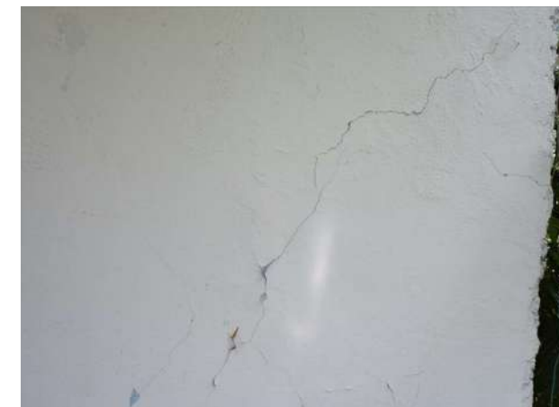
Imagen 3: Detalle de grietas y fisuras
