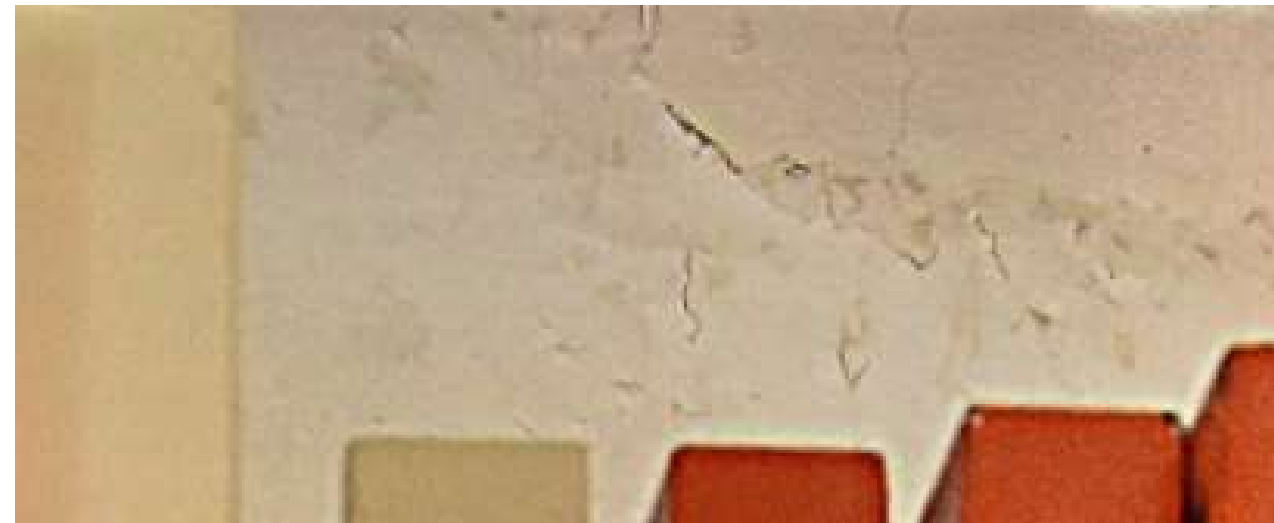
Imagen 1: Detalle de fisuras y agrietamientos presentes en muro interior sur
