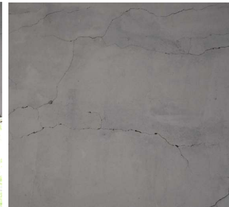
Imagen 2: Detalle de fisuras presentes en muro interior poniente
