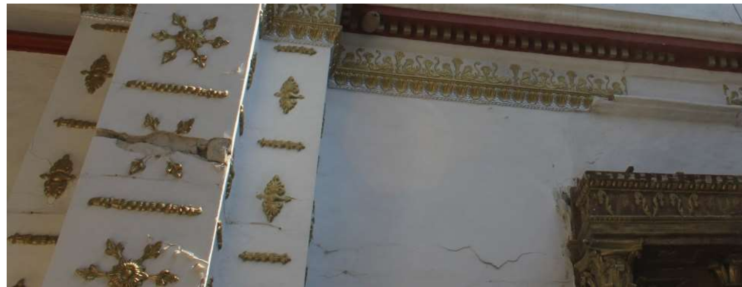
Imagen 1: Detalle de afectaciones en parte alta de fuste de pilastra nororiente
