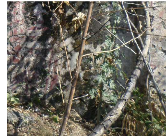
Imagen 4: Detalle de las humedades presentes en muro exterior sur
