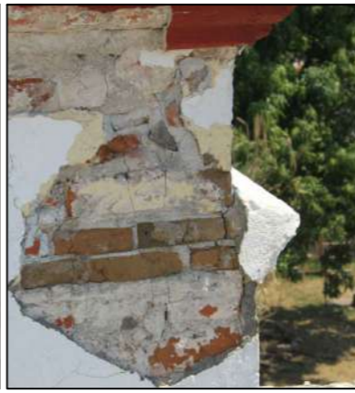
F03. Detalle de afectaciones en segundo cuerpo de Torre campanario fachada sur
