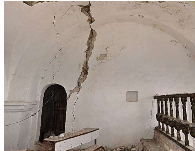
Imagen 1: Vista general de afectaciones presentes en muro interior norte de Coro
