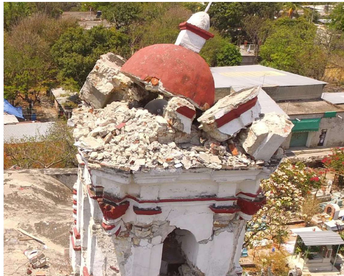
Imagen 1: Detalle de afectaciones presentes en parte baja de muro interior norte en Presbiterio
