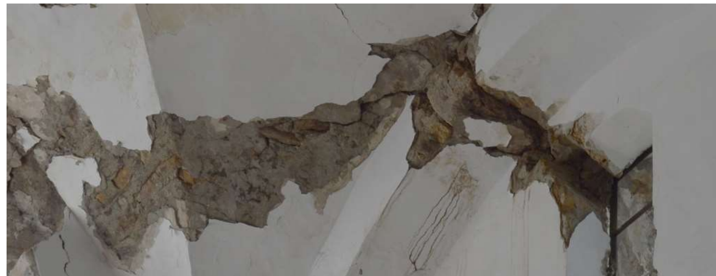
Imagen 1: Vista de afectaciones en arco formero e intradós de cubierta
