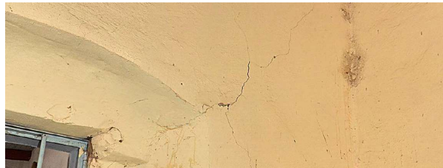
Imagen 2: Agrietamientos en muro interior sur
