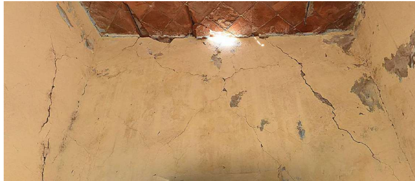
Imagen 1: Vista general en parte alta de muro interior norte
