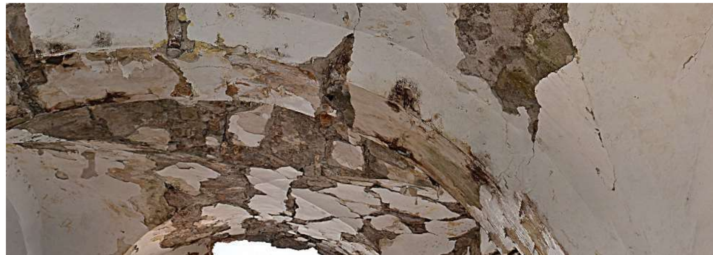
Imagen 1: Detalle de afectaciones en arco fajón de Coro
