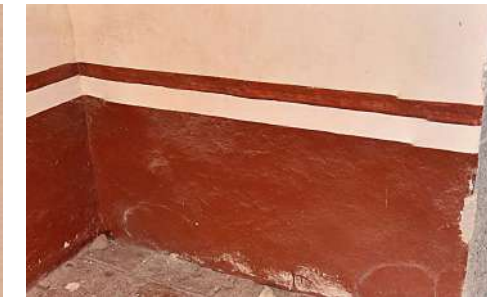
Imagen 2: Detalle de afectaciones en parte baja de muro interior norte
