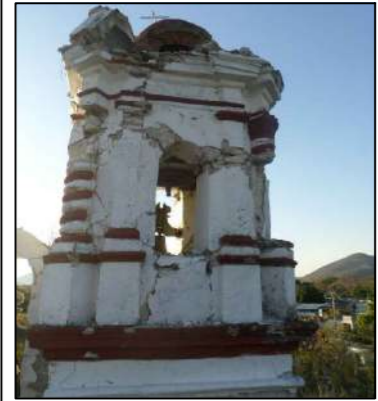
F01. Detalle de deterioros presentes en segundo cuerpo de Torre campanario fachada oriente
