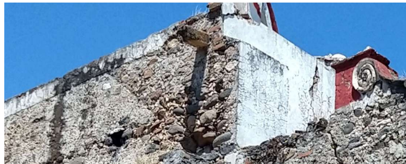
Imagen 2: Detalle de afectaciones presentes en muro exterior sur y oriente de Nave tramo 2
