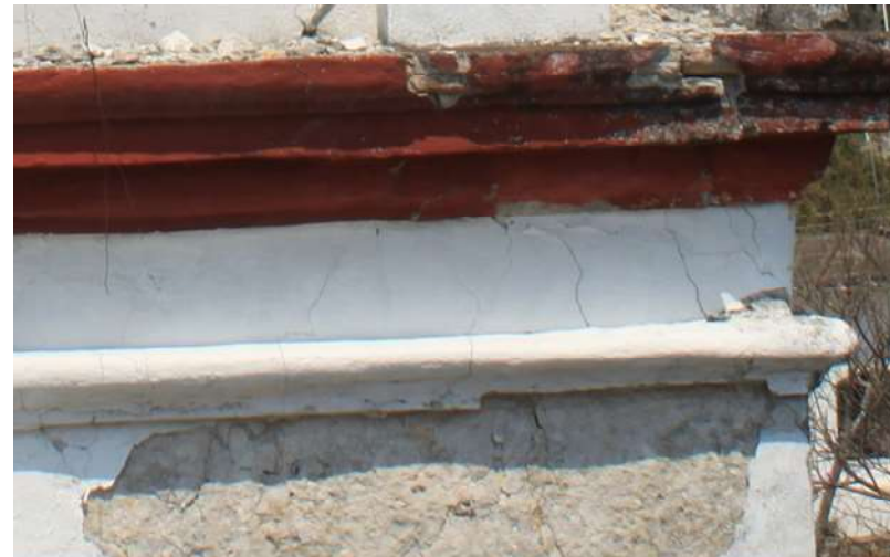
Imagen 2: Detalle de afectaciones presentes en cornisas de torre fachada oriente
