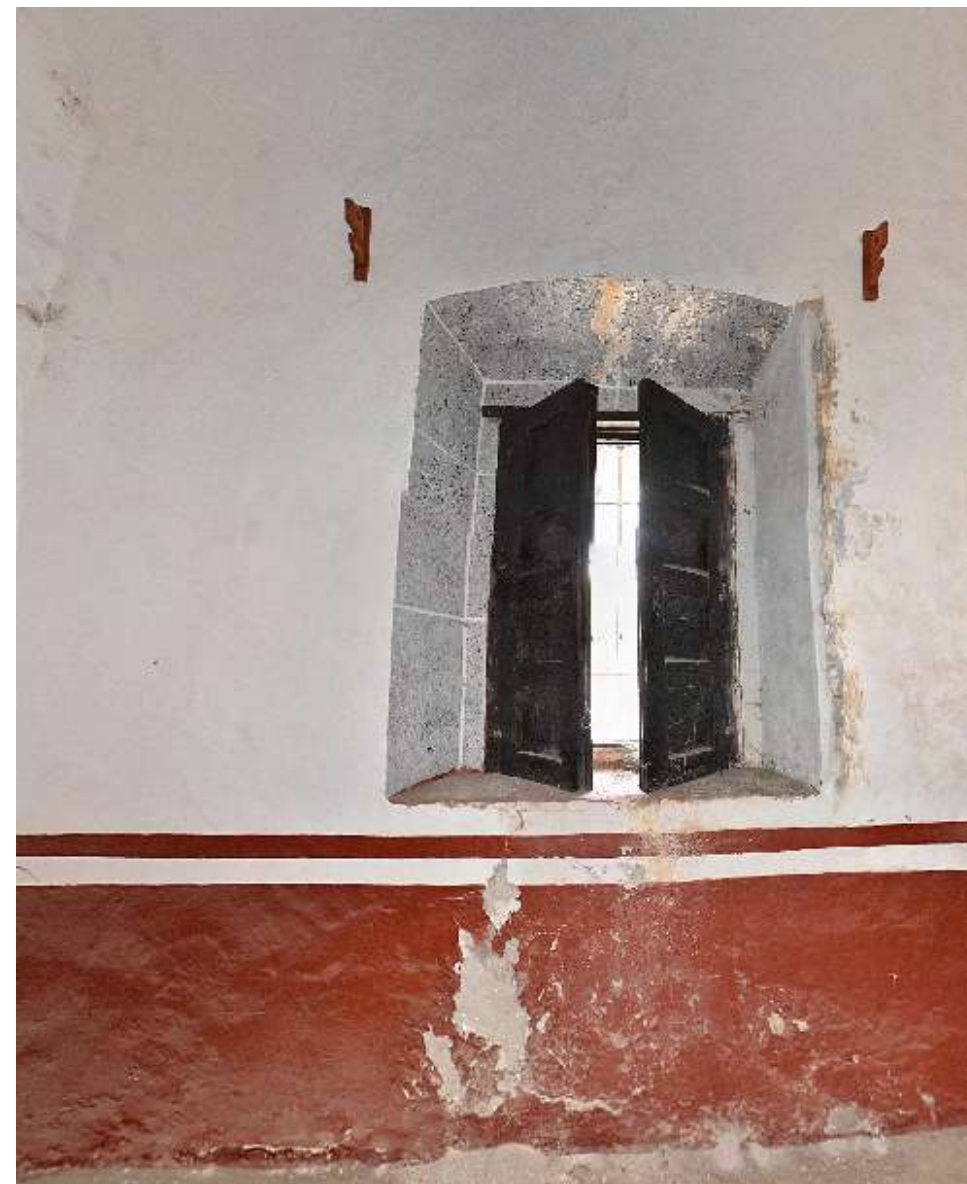
Imagen 2: Detalle de afectaciones presentes en parte baja de muro interior norte en Presbiterio
