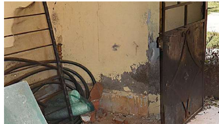
Imagen 2: Detalle afectaciones en muro interior norte
