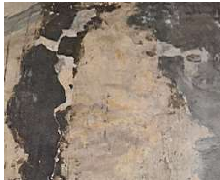
Imagen 1: Vista de afectaciones en muro interior oriente
