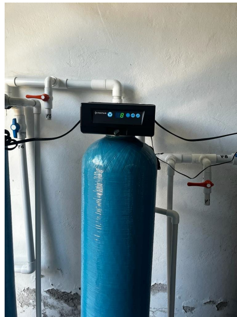
Figura 2.4. Filtro de carbón activado.
