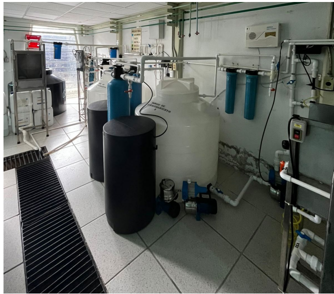
Figura 2.1. Vista parcial interna de la planta tratadora de agua.
