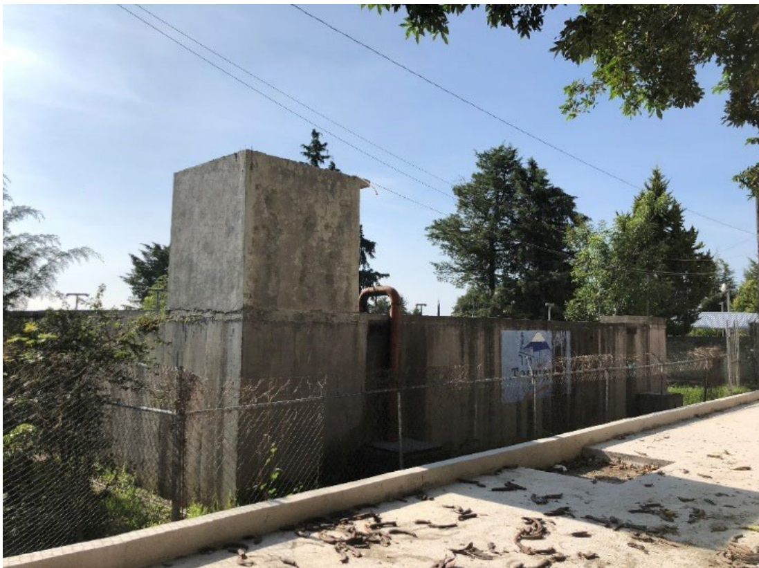
Imagen 14. Tanque. Aunque se encuentra en el barrio del Calvario, este depósito da servicio sobre todo al barrio del Centro a través de la red municipal que se desarrolló inicialmente. Fotografía propia, 2019
