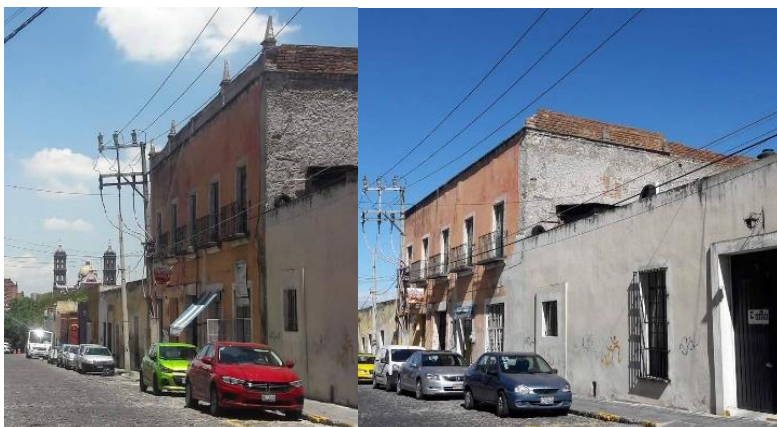
Figura 26: Inmueble de la calle 5 oriente 1206, luego del sismo ocurrido el 19 de septiembre del 2017. Dado a su estado deteriorado, perdió sus pináculos que remataban en la parte superior. Las imágenes corresponden al antes y al después del suceso. Fotografías del autor (2017).
