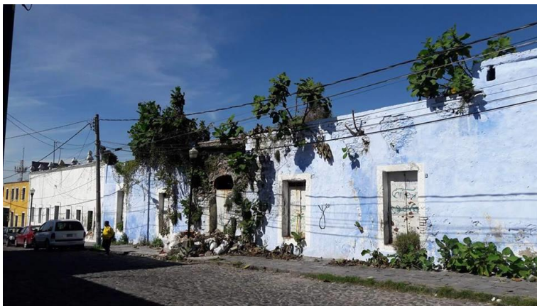
Figura 25: Inmueble en estado ruinoso. La fachada presenta serio desgaste, aunque también resalta el crecimiento de vegetación en la parte superior de la vivienda, extendiendo las afectaciones a la rotura de muros y acabados. Google Maps (2017).
