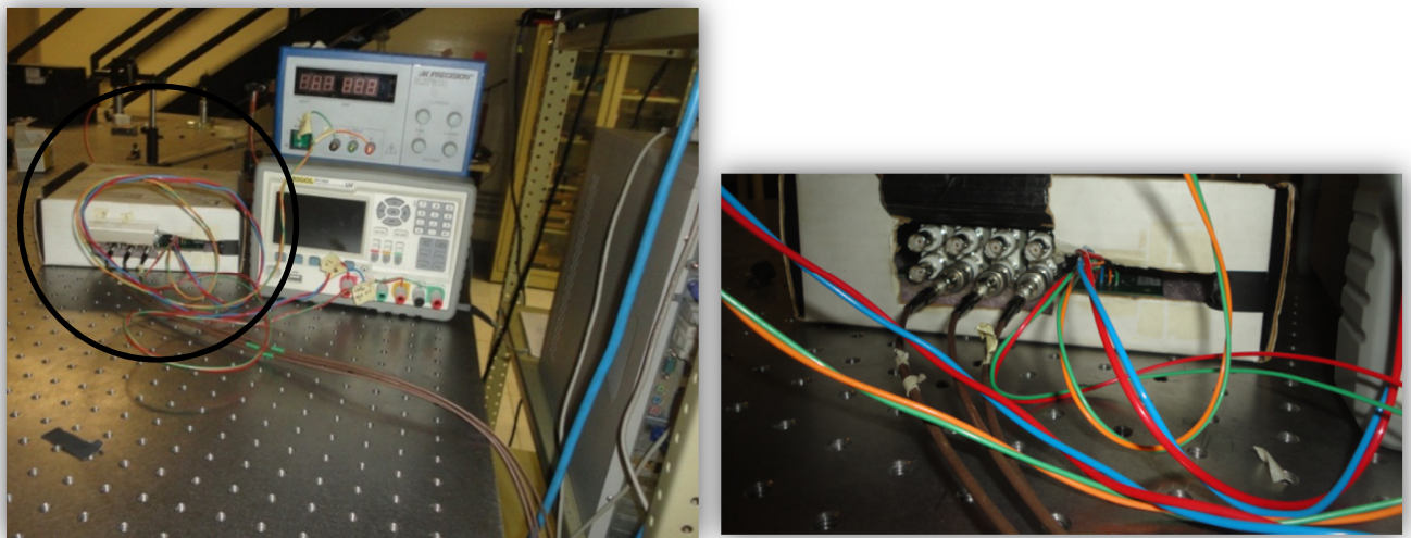
Figura 2.22. Fuentes de alimentación externa para los módulos.
