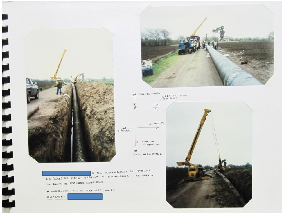
Se observan aspectos constructivos en instalación de tubería de acero de 24" diám. tratada y esmaltada. Se aprecia la falta de parcheo exterior.
