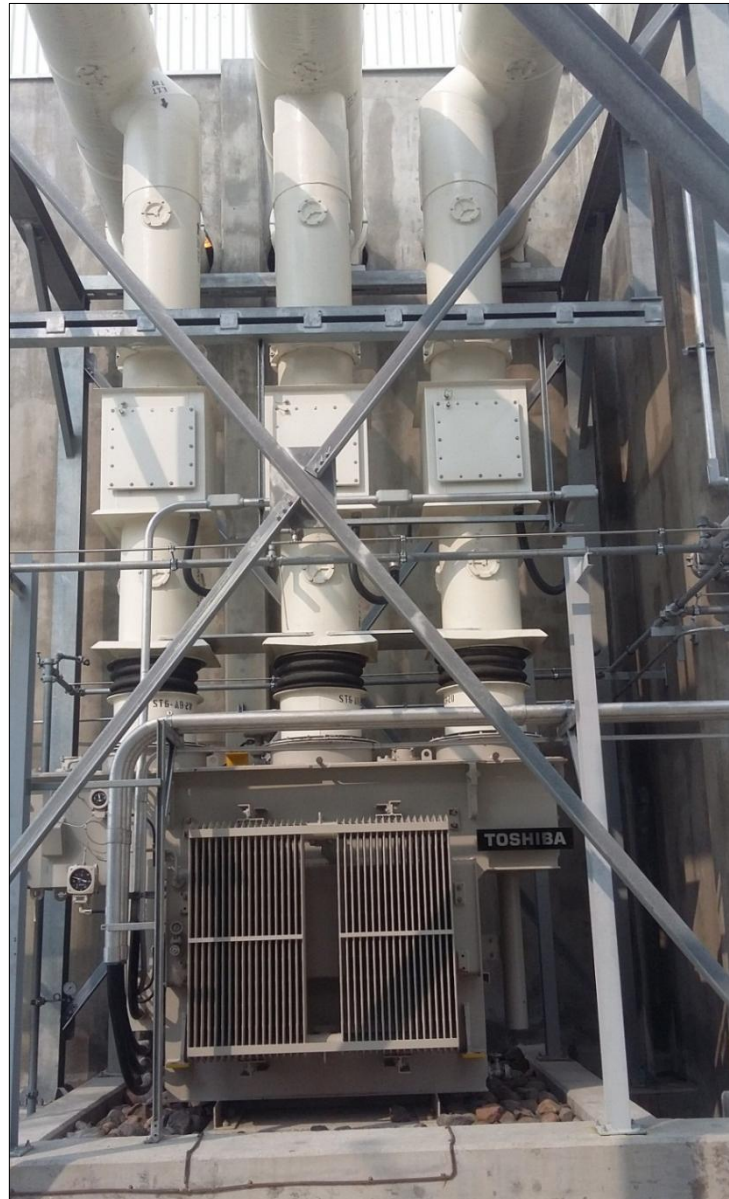
Figura 2.8 Transformador de excitación
