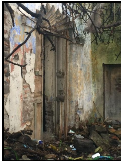
Figuras 180, 181, 182 y 183 Vista de elementos arquitectónicos deteriorados BJB|Fuente propia 2016
