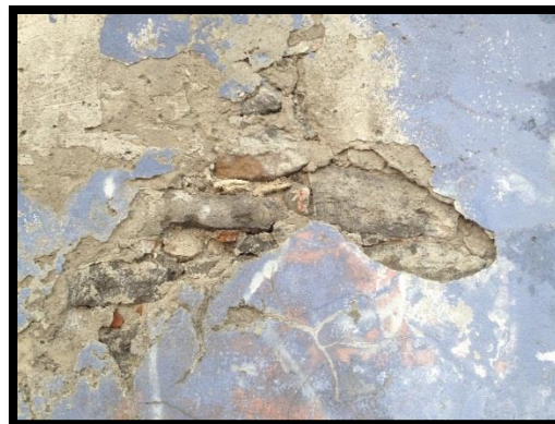
Figura 177 y 178 Vista de deterioración BJB|Fuente propia 2016
