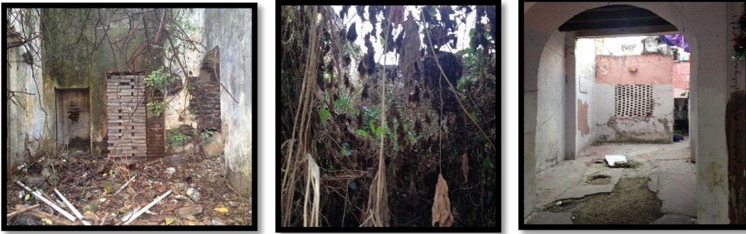
Figura 95,96 y 97 Interiores de algunas losas colapsadas del predio Puebla BJB | Fuente Propia 2014
