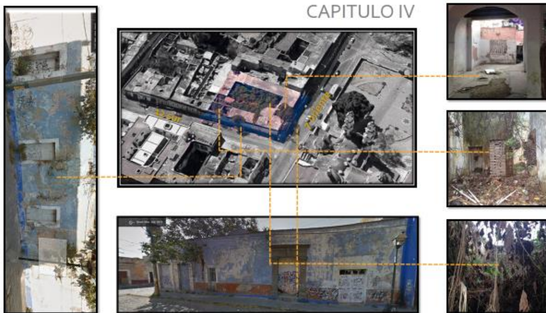
(Imagen 9) Fuente propia Foto vista área marcando sus fachadas e interiores colapsados.
