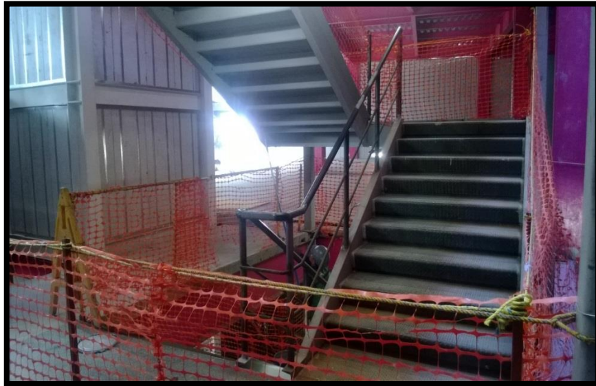
Ilustración 3 DELIMITACION DE AREA DE ESCALERAS, ACTIVIDAD ARMADO DE PASAMANOS Y COLOCACION DE ESCALONES, GALERIAS SERDAN
