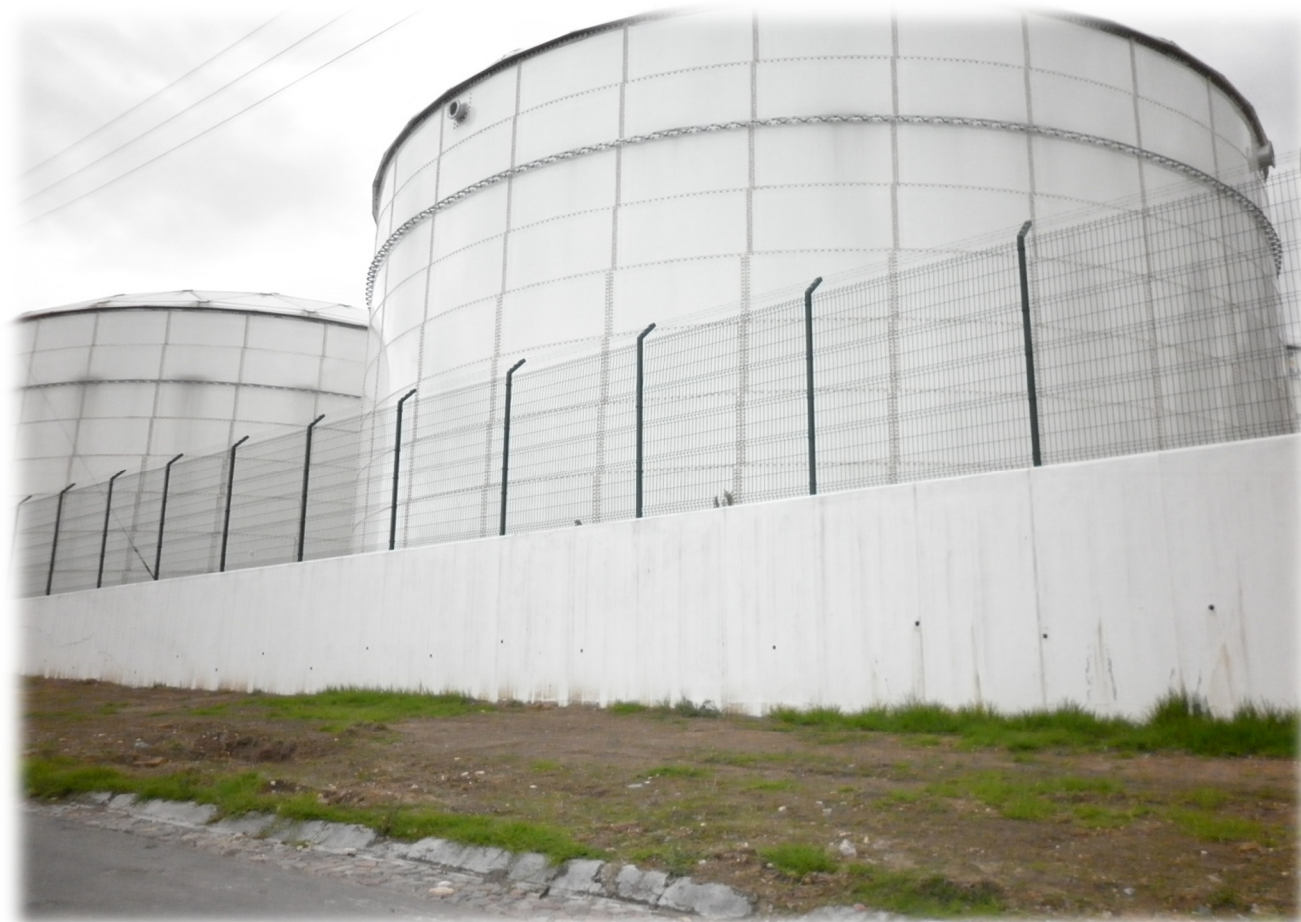
Ilustración 36 – Centro de Bombeo de SOAPAP, que Abastece del Servicio al Desarrollo
