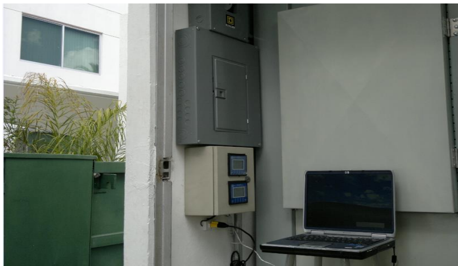
Fig. 4.10 Medidores Elnet conectados y comunicados con equipo de cómputo
