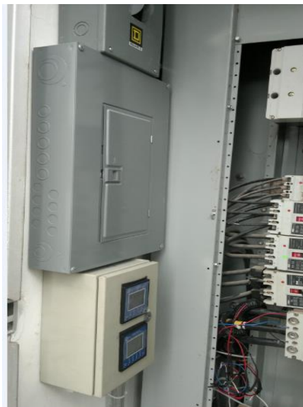
Fig. 4.9 Equipos de medición junto a tablero principal de distribución
