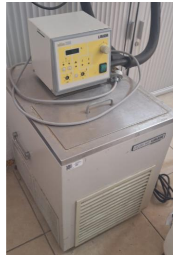
Figura 16. Equipo termostato de circulación.
