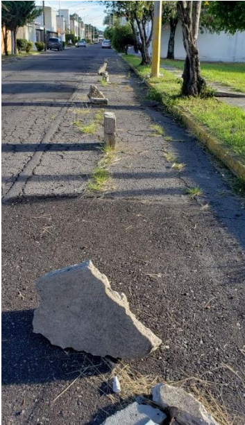
Figura 7. Mobiliarios en mal estado
