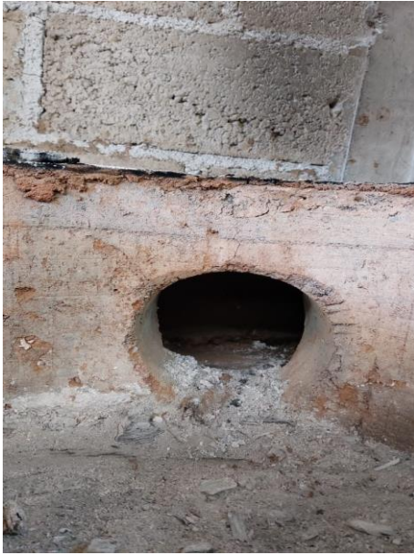
Fig. 91. Vista frontal de los ductos
