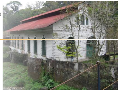
FOTOGRAFIA 1.5 Actual estado de la planta Hidroeléctrica "Viri III"
