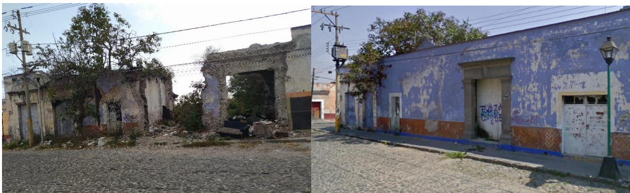
Figura 31 Fachada deteriorada, la fotografía de la izquierda fue tomada en diciembre del 2022 y la fotografía de la derecha en el año 2009.
