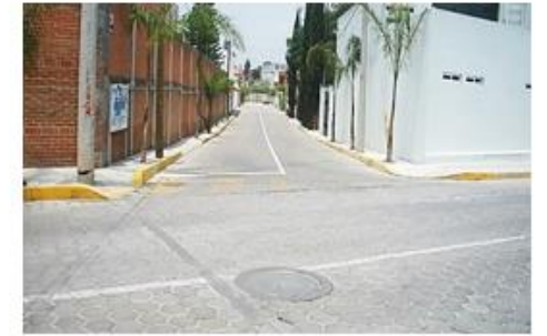
Ilustración 43 Red de drenaje Av. Del Ciervo |Foto por: Yosibeth Soriano
