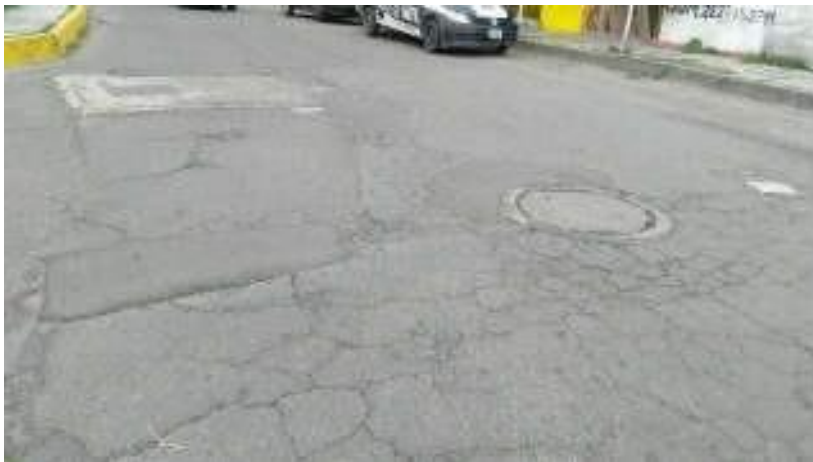
Fig. 47 Deterioro de la pavimentación de la calle Revolución Poniente Valdez&Ramirez, 2017
