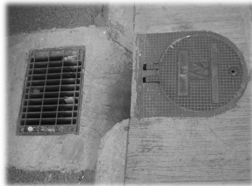
FOTOGRAFIA 15 TOMADA POR JFRJ 27/04/13. SERVICIOS DE ALCANTARILLADO
