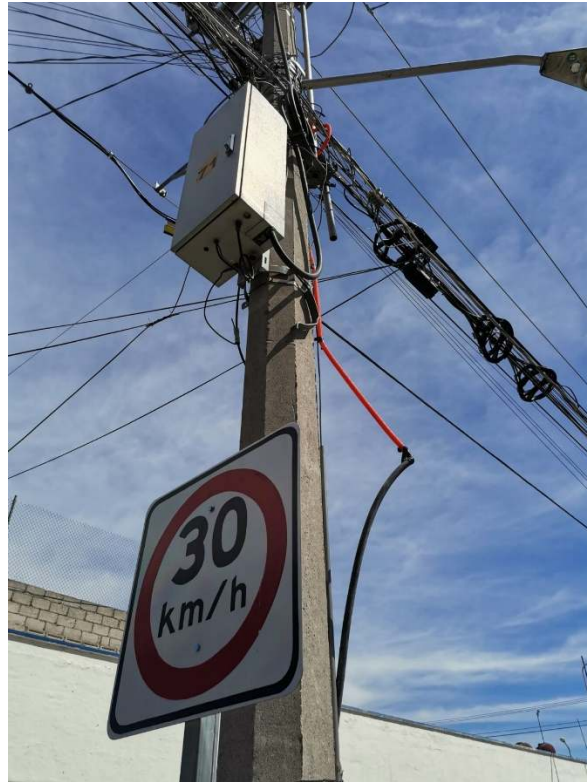
Toma clandestina de línea eléctrica para alimentar al baño. López, 2021. Fotografía digital.
