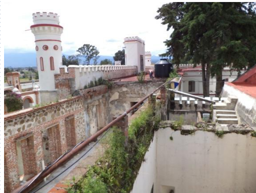
8.- Pérdida total de cubierta junto a capilla de la hacienda, también observamos la presencia de plantas parasitas a lo largo del muro.
