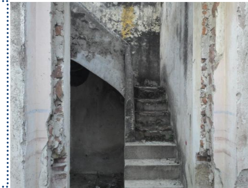
12.- Agrietamiento en muros, erosión en escaleras y humedad en escaleras de habitaciones inferiores.
