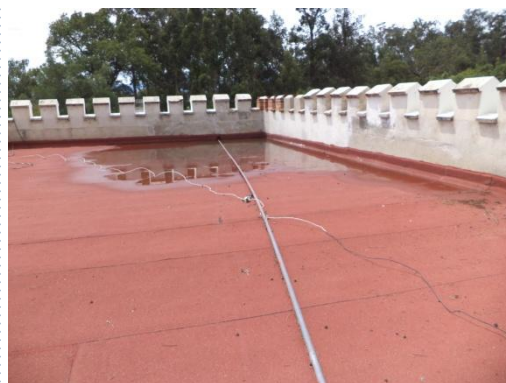
9.- Estancamientos de agua en azoteas, esto causado por la mala ejecución de la aplicación del impermeabilizante.
