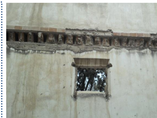
10.- Socavación en muros interiores, agrietamiento y pérdida de aplanados.
