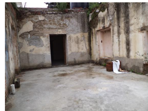
5.-Vegetación parasita en remates de muros, pérdida de losa y aplanados, así como humedad causada por las lluvias; en esta fotografía se puede apreciar que la consolidación de los muros es a través de un sistema mixto entre adobe y tabique rojo juntado con mortero.
