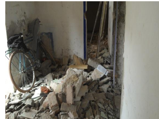
4.- acumulación de escombros y pérdida de aplanados en habitaciones abandonadas.
