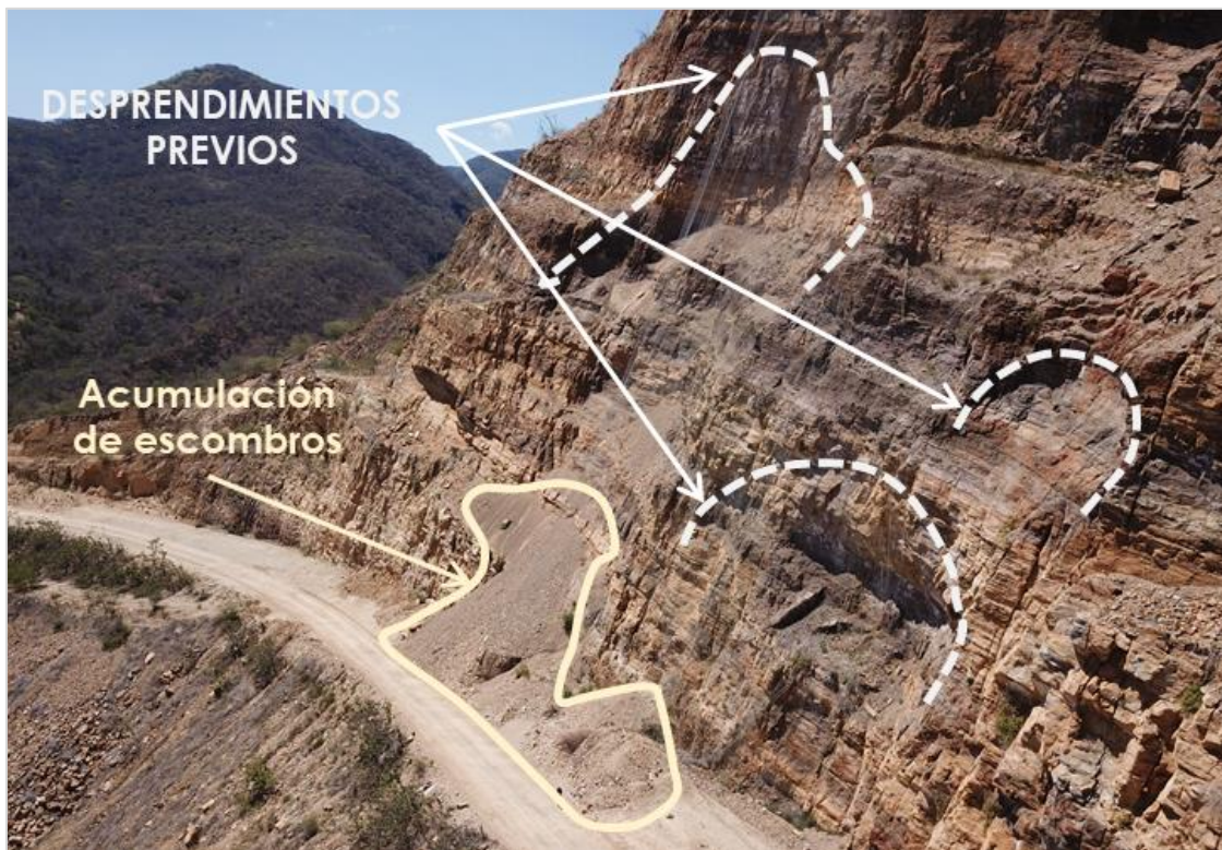
Figura 5.2 Parte central del talud con evidencia de caídos previos, al igual que acumulación de escombros por graneo constante.
