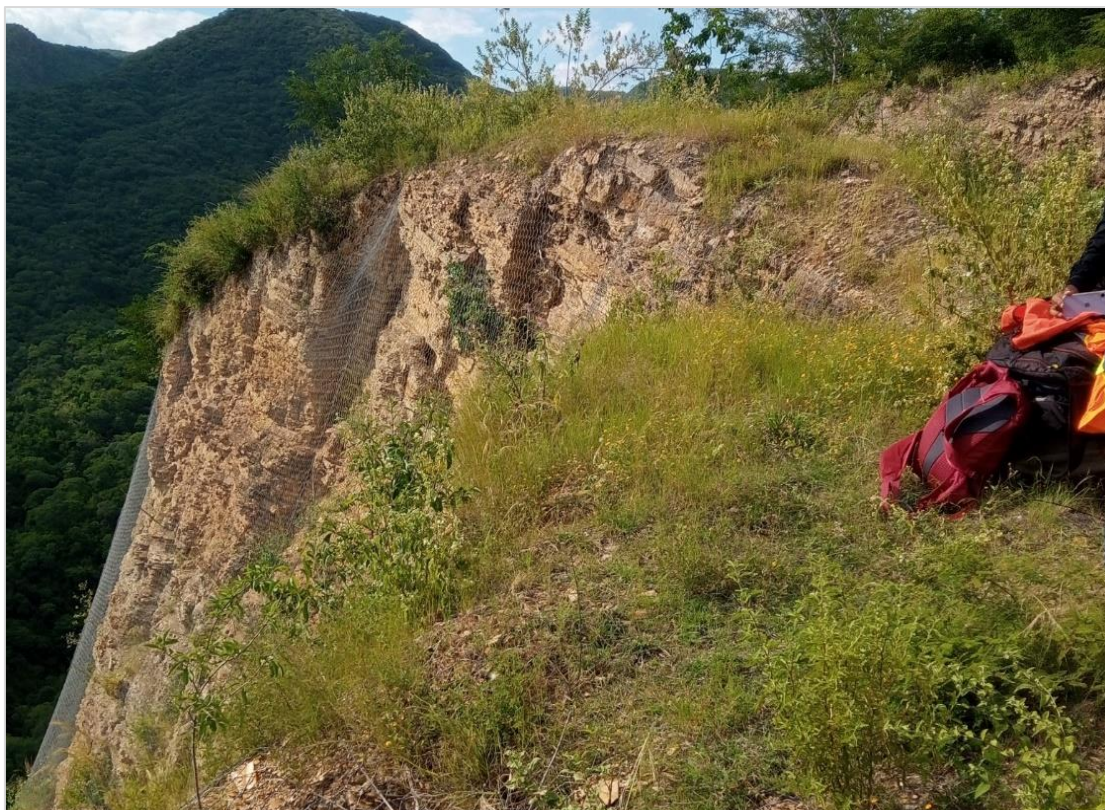
Figura 5.3 Zona del hombro del talud donde el macizo rocoso está intemperizado, relajado y más fracturado.
