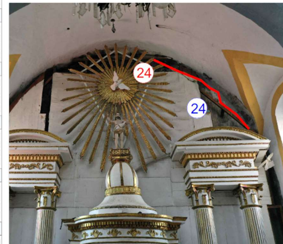
Ilustración 27: Aplanados con mortero cemento-arena y grietas en muro testero.
