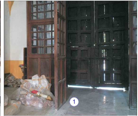
Imagen 4: la proliferación de organismos superiores como palomas generan manchas en los muros.
