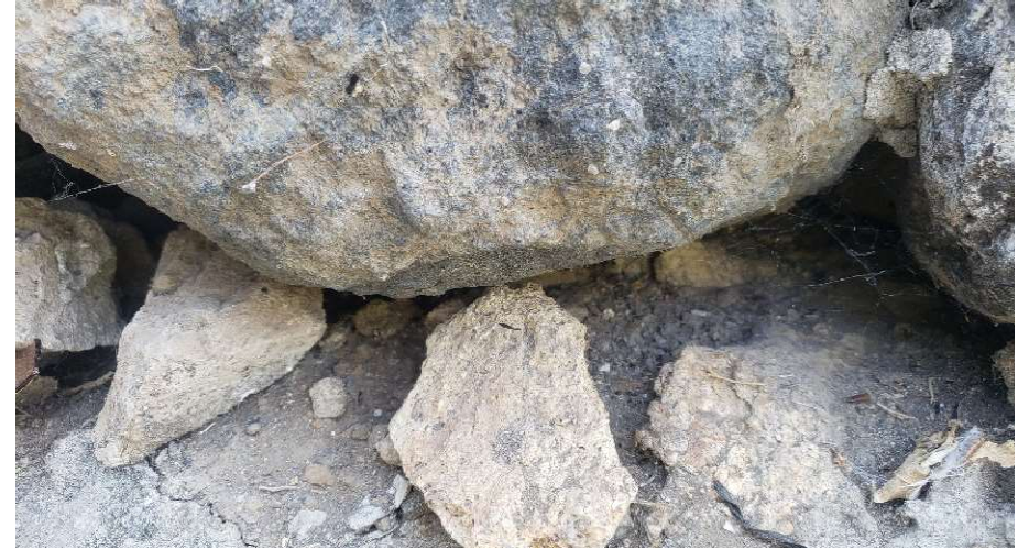
Ilustración 120: disgregación del mortero de paramento externo y del núcleo del muro testero. Autor: SLF
