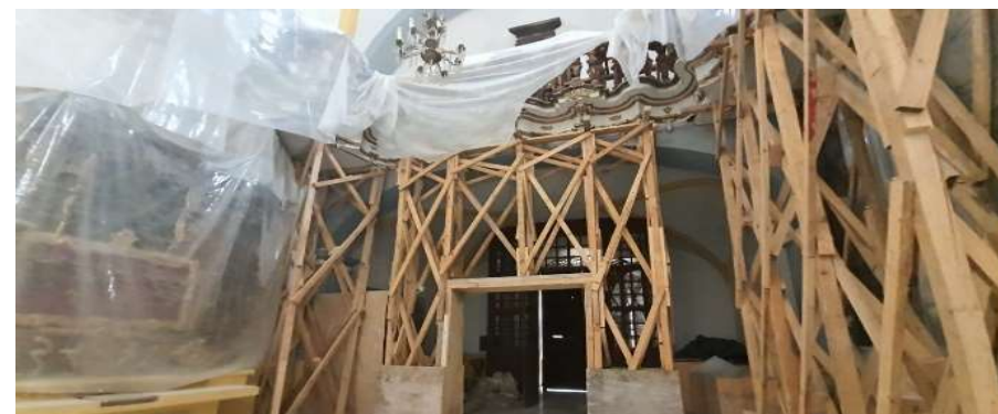
Ilustración 68: Balaustrada del coro apuntalada. Autor: SLF
