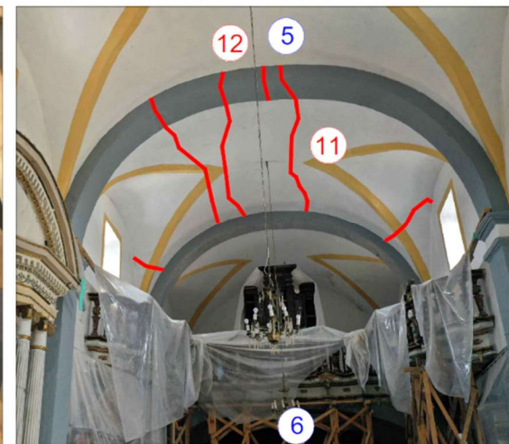
Imagen 10: Grietas en sentido longitudinal de la nave principal.
