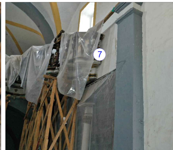
Imagen 12: Manchas causadas por heces de palomas.
