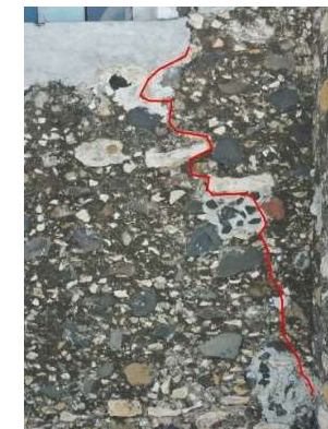
Ilustración 8: Grietas en el tramo 6 muro norte. Autor: Arq. Samuel López Flores
