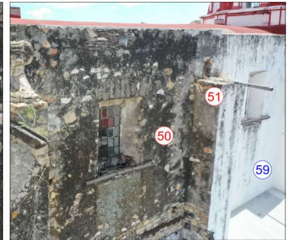
Imagen 68: vegetación parasita y disgregación de aplanados.
