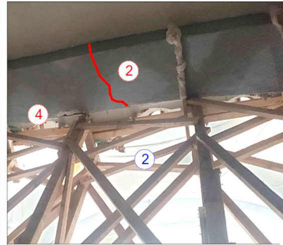
Imagen 3: La colocación del apuntalamiento en el arco del coro genera pérdida de aplanados.
