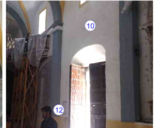
Imagen 14: Manchas por heces de aves en el muro sur del tramo 2 e instalación eléctrica superficial.
