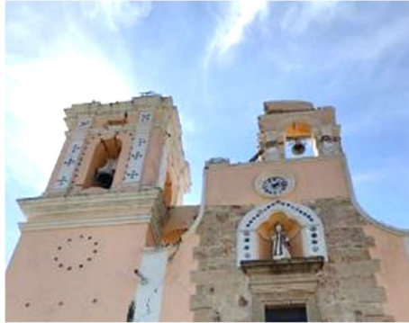
Ilustración 140: Colapso de espadaña en 2017. Autor: Lic. Silverio Reyes Sarmiento
