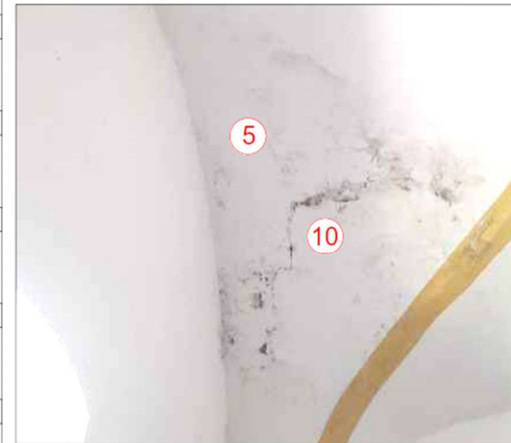
Imagen 7: Disgregación y grietas en bóveda de lunetos.
