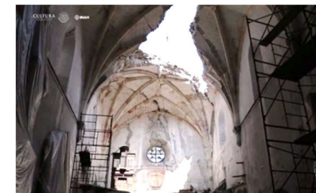
Ilustración 3: Colapsos en el convento de San Martín Caballero de Huaquechula, Fuente: https://www.youtube.com/watch?v=3D0liF2G048
