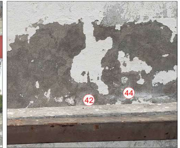
Imagen 54: Aplanados de mortero cemento-arena, disgregación y eflorescencia en la spartes bajas de los muros.
