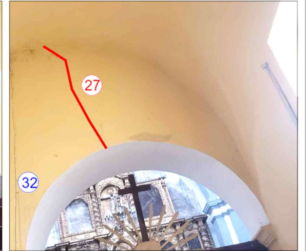
Imagen 34: colocación de instalación eléctrica superficial y grietas en muro norte y apertura de puerta hacia la capilla del sagrario.
