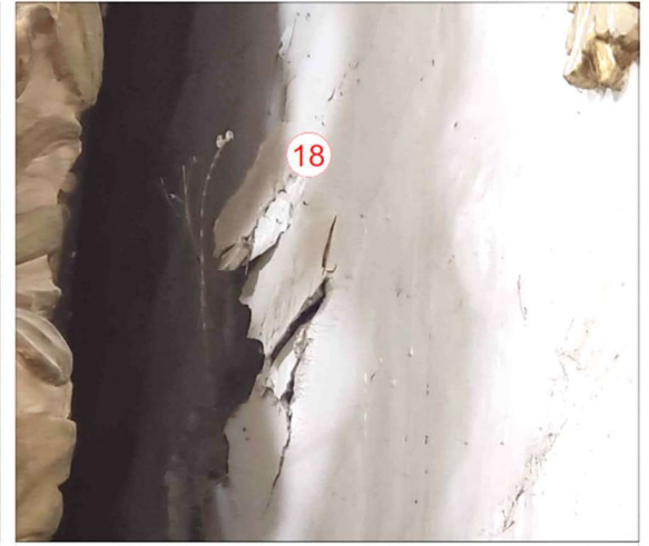
Imagen 18: grietas causadas por vegetación parasita en muro norte.
