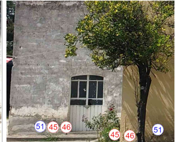
Imagen 58: grietas y disgregación de aplanados en zonas bajas de muros.
