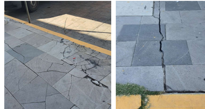
Ilustración 91: Grietas en banquetas y guarniciones en la plaza principal de Huaquechula. Fuente: Arq. Alejandro Daniel Sánchez López
