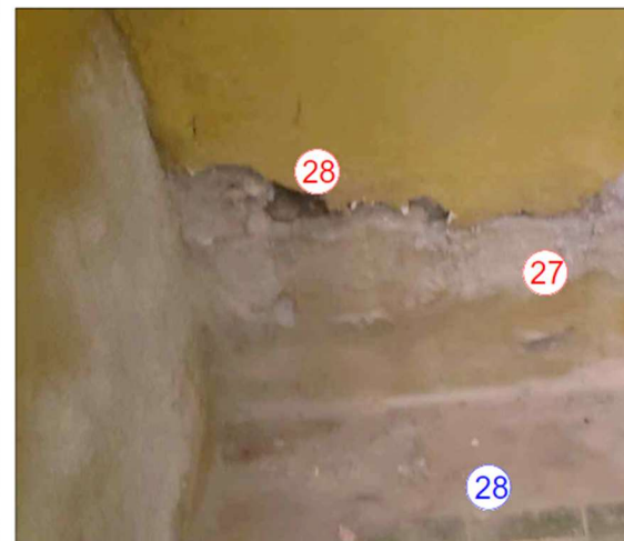
Imagen 31: Disgregación de aplanados, eflorescencia y cambio de piso original.
