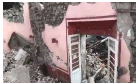
Ilustración 2: Daños en una casa de Huaquechula, Puebla Fuente: Noticias Telemundo https://www.facebook.com/watch/?v=10155
