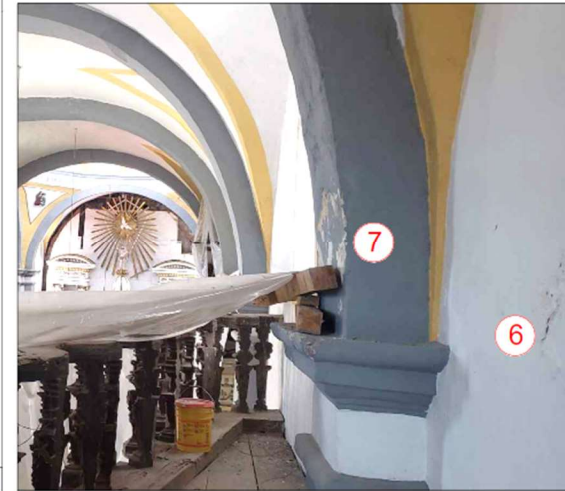
Imagen 5: desprendimiento de pintura por fricción y disgregación de aplanado en muro norte.
