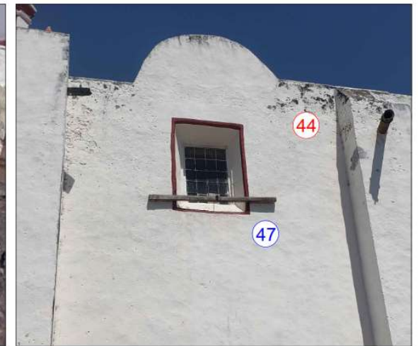
Imagen 56: drigregación de aplanados en las partes superior de los muros.
