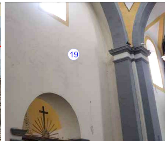
Imagen 24: Manchas por heces de aves en muro sur.
