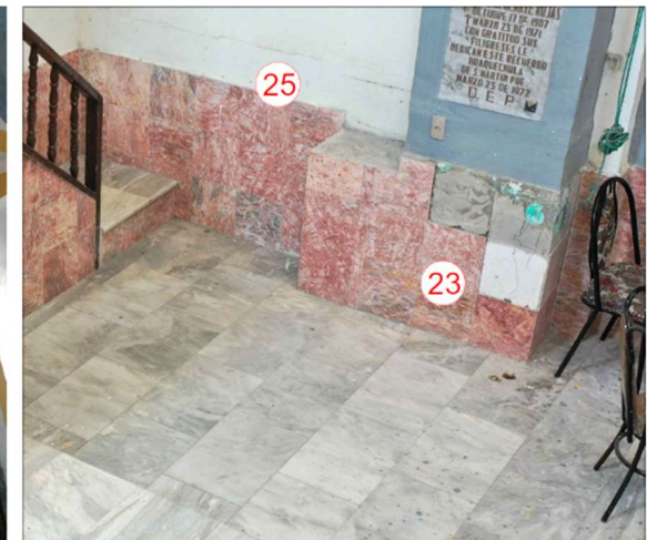
Ilustración 28: desprendimiento de lambrines de marmol y grieta en muro norte.
