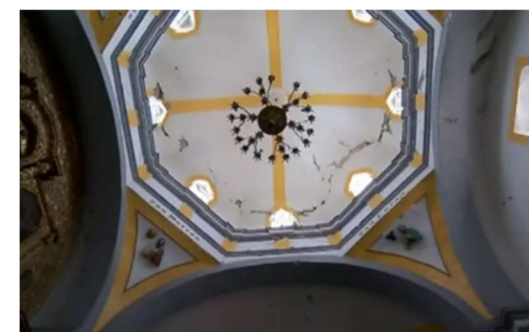
Ilustración 4: Deterioros en cúpula de la Parroquia de San Martín Obispo, Fuente: https://www.youtube.com/watch?v=u29IXJz58p4
