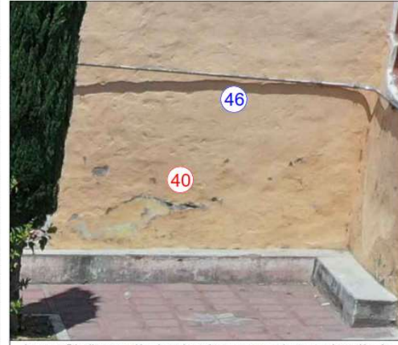
Imagen 51: disgregación de aplanados en muro oriente y colocación de canalización eléctrica de fierro galvanizado.
