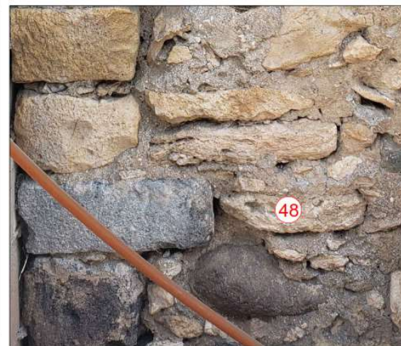
Imagen 62: disgregación de juntas de mampostería en el muro testero.
