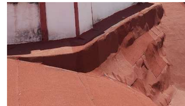
Ilustración 1123: Deterioro y mala colocación de impermeabilizante prefabricado en el extradós de la bóveda. Autor: SLF
