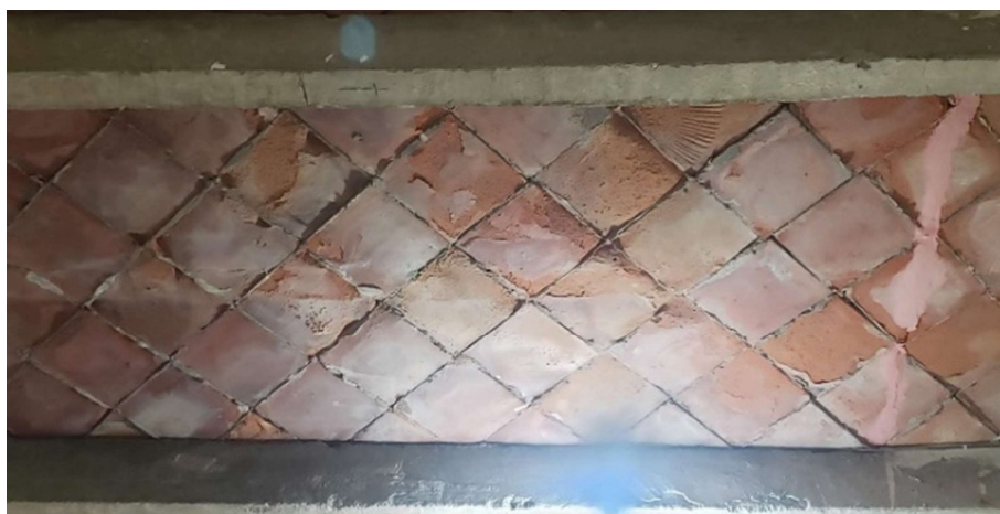
Ilustración 113: disgregación de ladrillos de losa catalana por mal estado de impermeabilizante prefabricado. Autor: SLF
