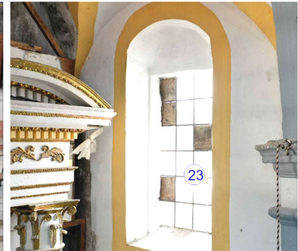
Imagen 26: Sustitución de cristales por tableros de madera.
