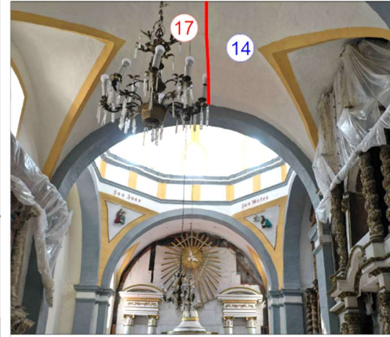
Imagen 17: grietas y deformaciones en boveda sobre el tramo 3
