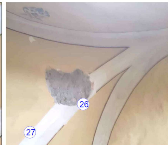
Imagen 30: faltante de aplanado en cubierta de baptisterio y alteración de color de pintura.
