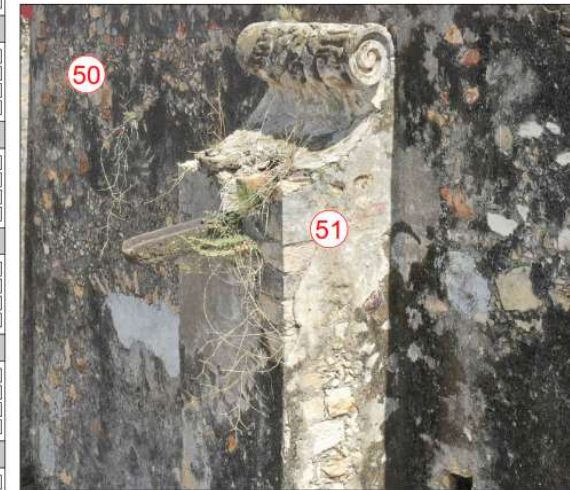
Imagen 67: vegetación parasita y disgregación de aplanados.
