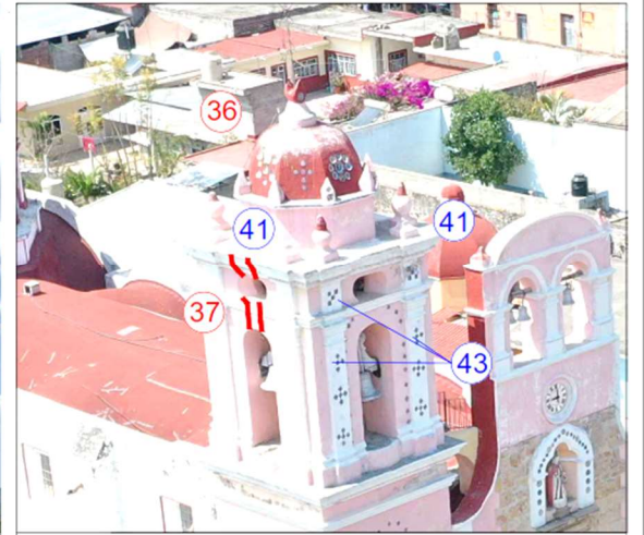
Imagen 46: grietas en campanario lado sur, disgregación de impermeabilizante en cupulín y pérdida de mayolica.
