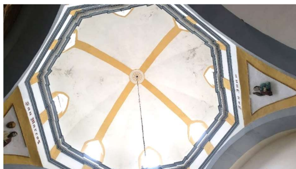
Ilustración 64: Interior de la cúpula de la parroquia de San Martín obispo. Autor: SLF
