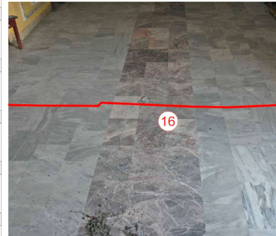
Imagen 15: Grieta en piso del tramo 3.
