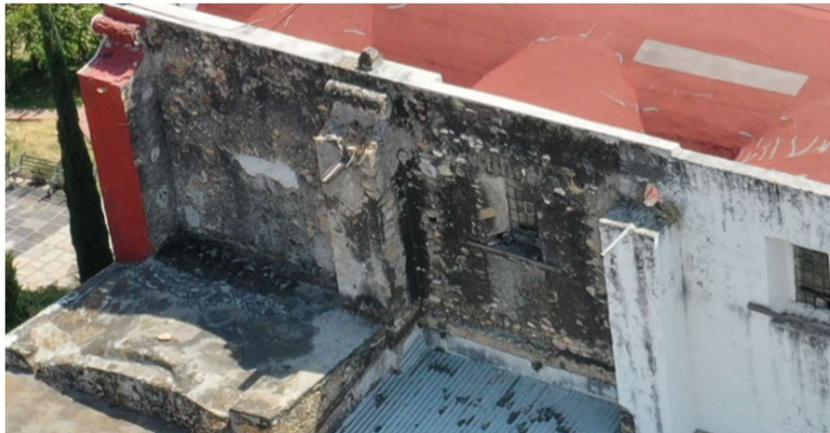
Ilustración 118: Hongos y vegetación parasita en muro norte. Autor: Autor: SLF
