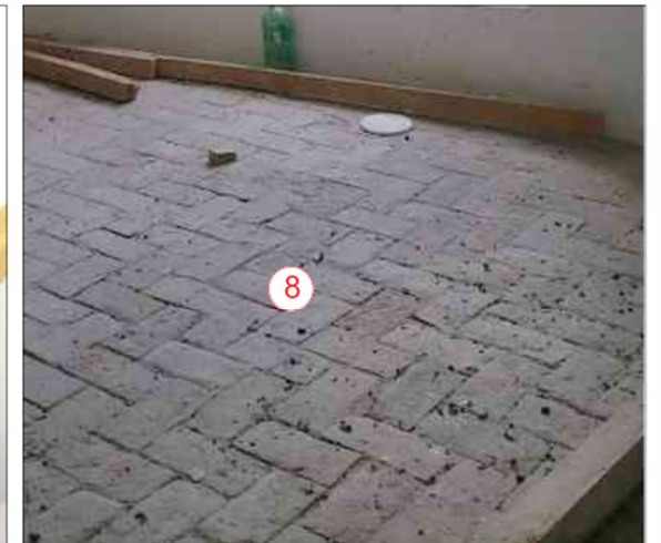
Imagen 8: desgaste de piso del coro.
