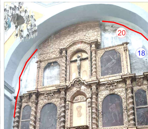
Imagen 23: Aplanados con mortero cemento-arena en muro norte del transepto y grietas en uniones de muros y bóvedas.
