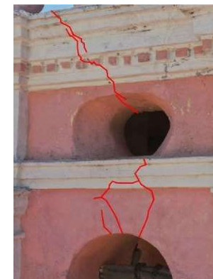
Ilustración 7: Grietas en el campanario, lado norte. Autor Arq. Samuel López Flores
