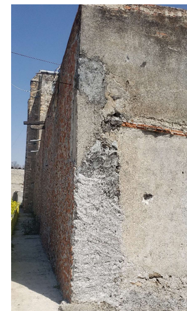
Ilustración 100: Castillo de concreto en conexión de muros de adobe en sacristía y bodega. Autor: SLF
