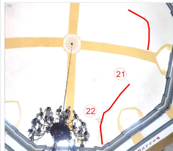
Imagen 21: Grietas y disgregación en cupula.
