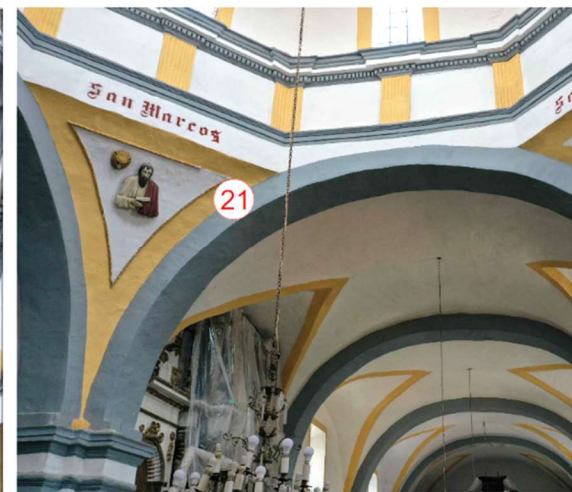
Imagen 22: Perdida parcial de imagen de bulto en pechinas.
