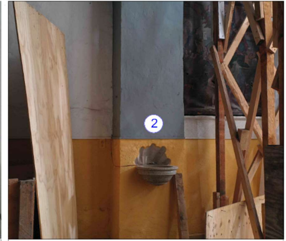
Imagen 2: Las pilas de agua bendita reducen la sección portante de las pilastras en el primer tramo.
