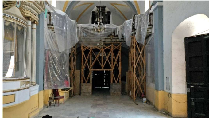
Ilustración 32: Colocación de apuntalamientos en le sotocoro de la parroquia de San Martín Obispo desde septiembre del 2017 y en 2024 aún permanece. Autor: Arq. Samuel López Flores
