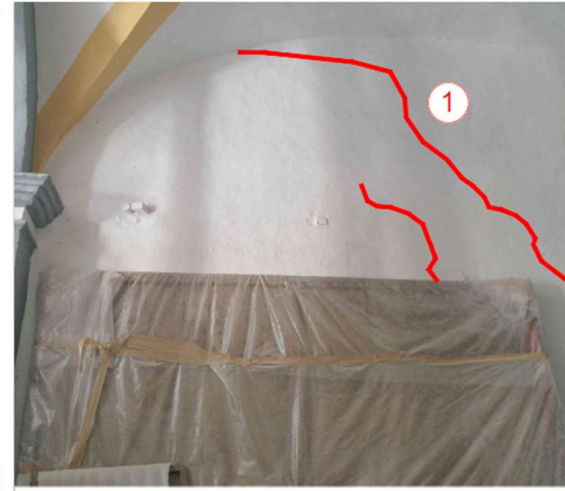
Imagen 1: La colocación del apuntalamiento en el arco del coro genera pérdida de aplanados.
